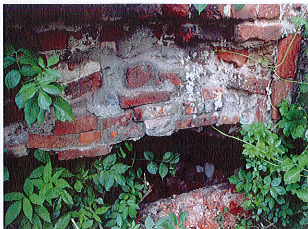
Fot. 2. – uszkodzenia sklepienia kolebkowego otworu w dolnej części muru
