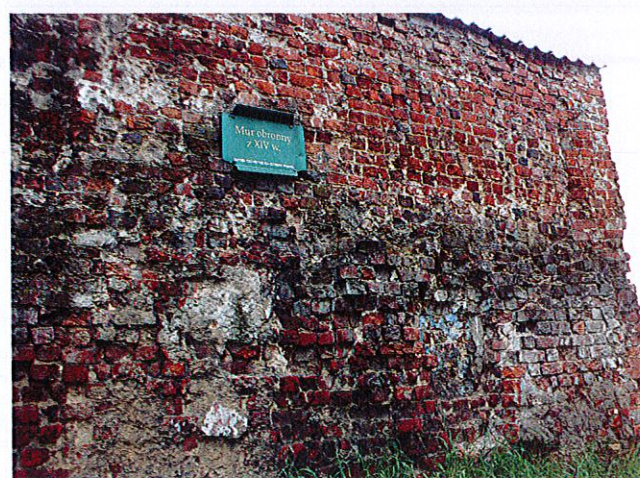
Fot. 10. – stan muru
