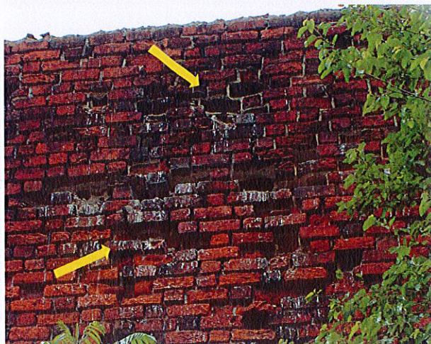
Fot. 4. – ubytki cegieł i spoinowania muru od strony południowej
