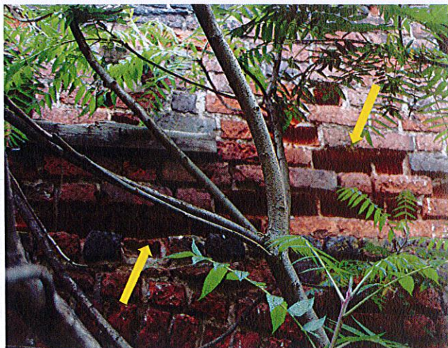
Fot. 3. – ubytki cegieł od strony południowej;
