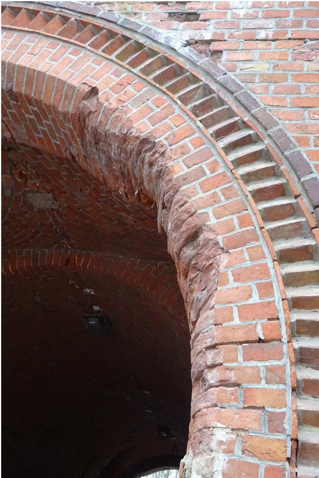
Ubytki w murach
