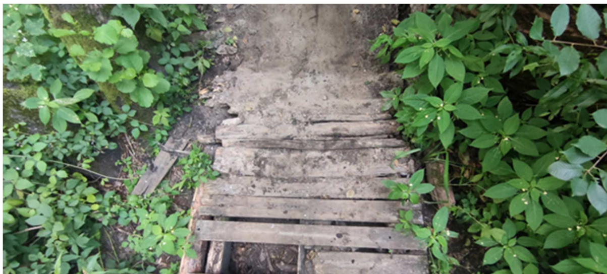
Fot. 5 – Zakończenie kładki od strony Owińskiej z brakującymi deskami pomostowymi
