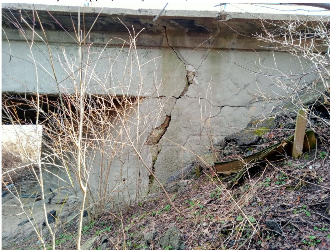
Foto nr 5 – Przyczółek, pęknięcia i ubytki betonu ;
