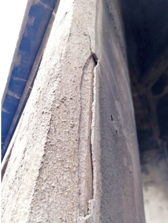
Foto nr 6 i 7 – Słupy filarów – typowe uszkodzenia.
