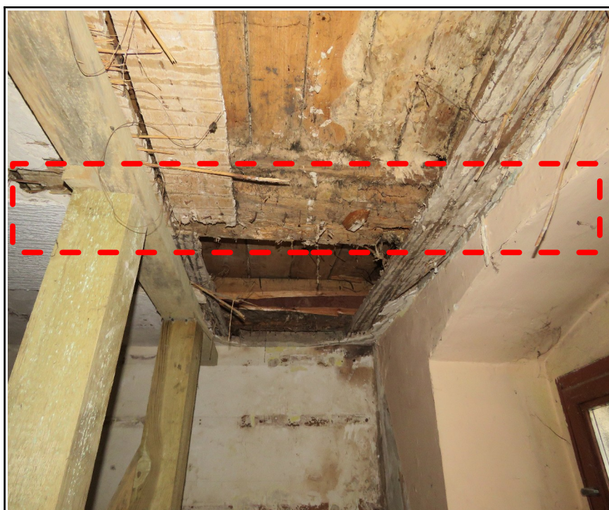
Fot. nr 2 – Lokal usługowy nr 2 - oznaczenie belki stropowej do wymiany
