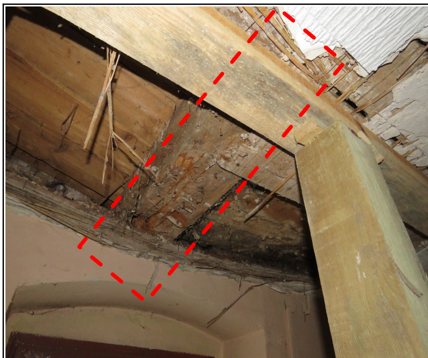
Fot. nr 1 – Lokal usługowy nr 2 - oznaczenie belki stropowej do wymiany
