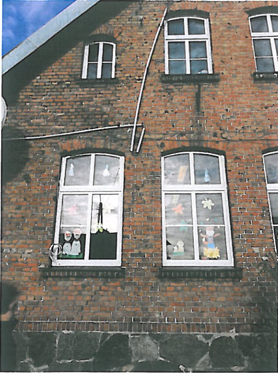
Fot.1 Frag. elew. połudn. część wysoka zach. z główną rysą od okna parteru
