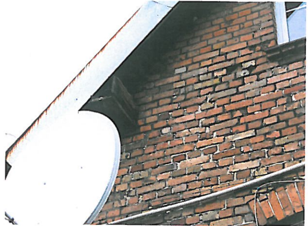
Fot.4 Elew. połudn. frag. z uszkodzeniami ściany szczytowej
