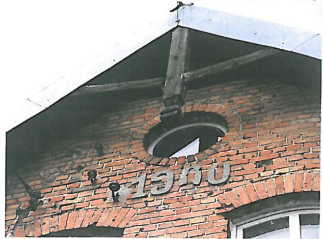
Fot.2 Elew. połudn. frag. szczytu z uszkodzonym drewnianym wieszakiem i uszkodzeniami cegieł
