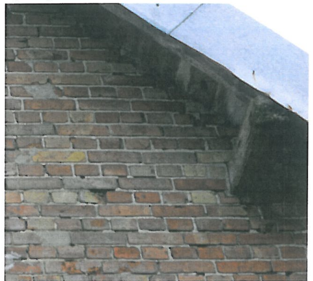
Fot.10 Frag. szczytowej części ściany zachodniej z uszkodzoną płatwią poza murem i elem. cegieł,spoin do uzupełnienia
