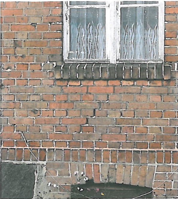
Fot.6 Elew. południowa rysa nad oknem piwnicy do parapetu okna środkowego w niskiej części ściany
