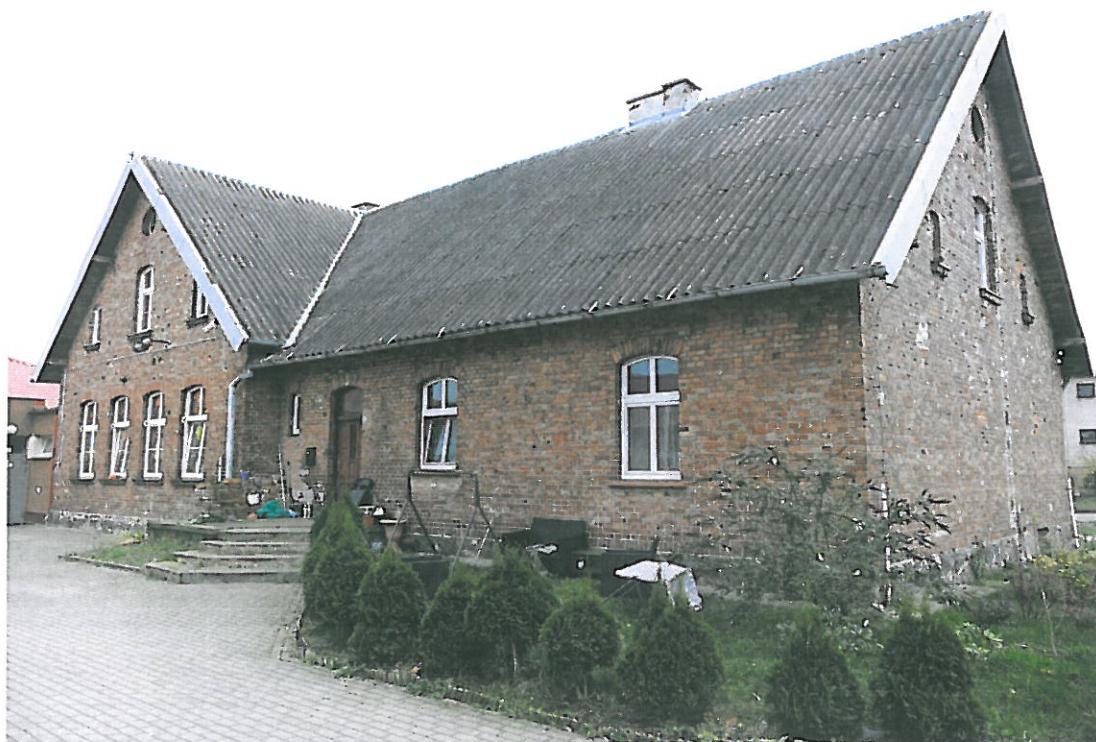
B. Frag. elew. połudn. część wysoka zach. z główną rysą od okna parteru
