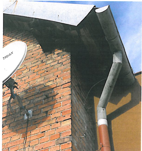
Fot. 5 Narożnik półd-wsch. Z uszkodzeniami elem. drewnianych końcówki płatwi i krokwi
