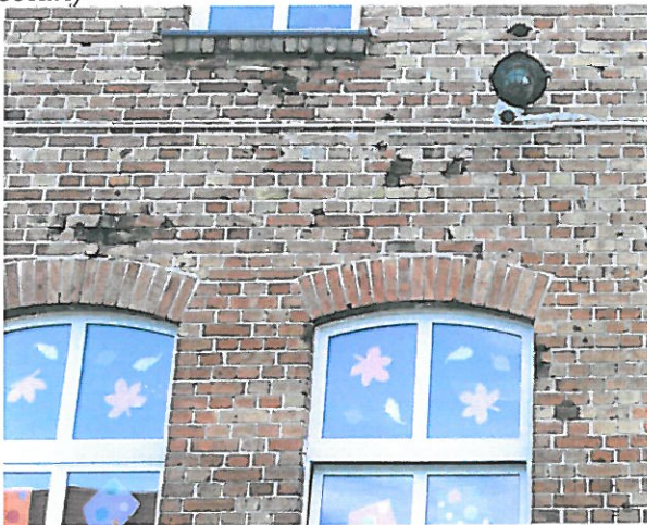
Fot.8 Elew. północna środkowa część ściany tzw.wysokiej z uszkodzeniami cegieł nad oknami parteru do parapetu okna poddasza
