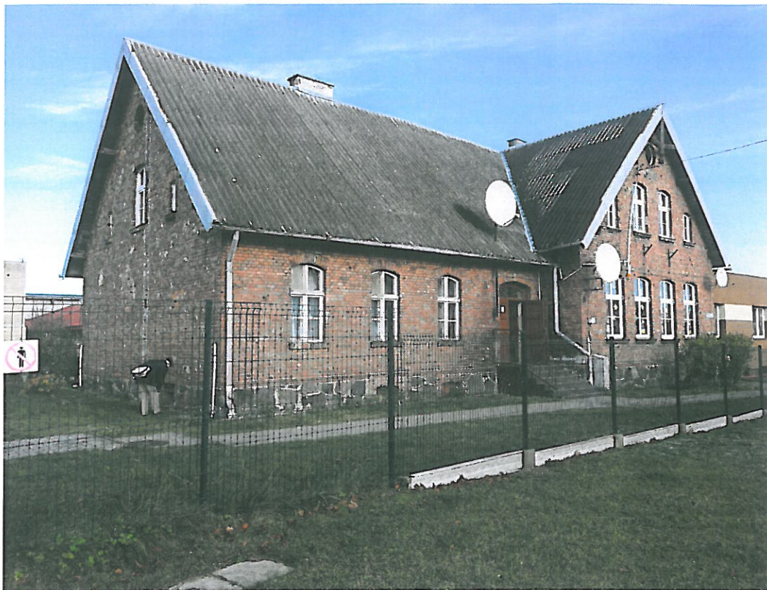
Fot. A. Frag. elew. połudn. część wysoka zach. z główną rysą od okna parteru
