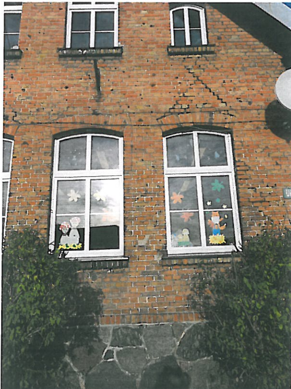
Fot.3 Frag. elew. półn. przy narożniku wschodnim z głównymi spękaniem nad oknem parteru do okna poddasza
