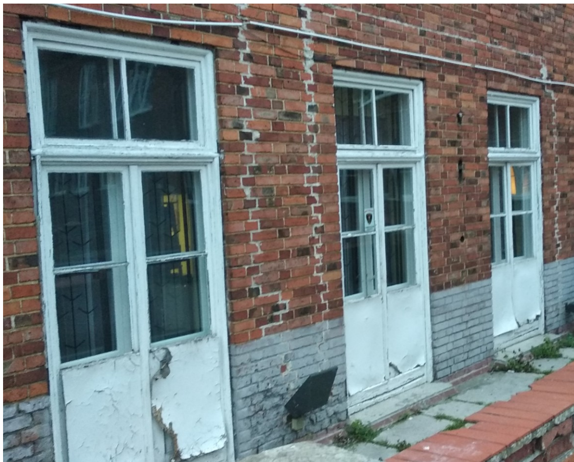
Widok na stan stolarki drzwiowej
