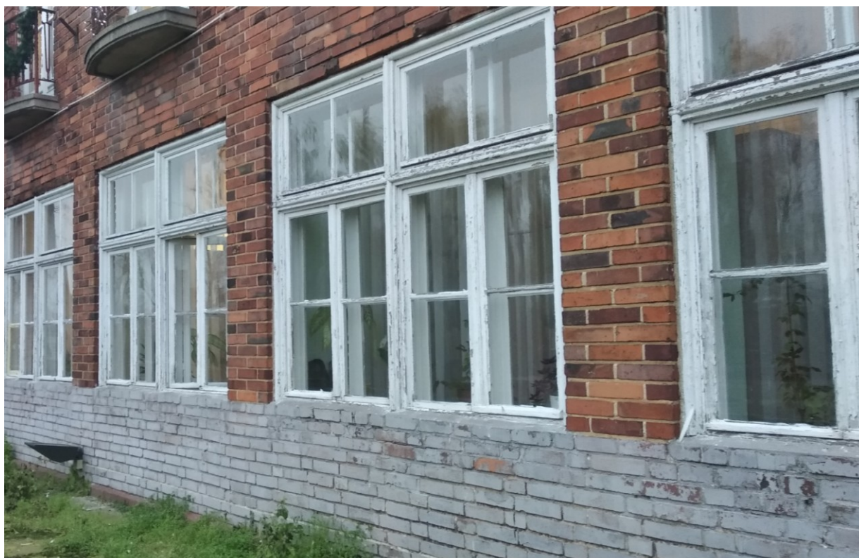
Widok na stan stolarki okiennej do wymiany.
