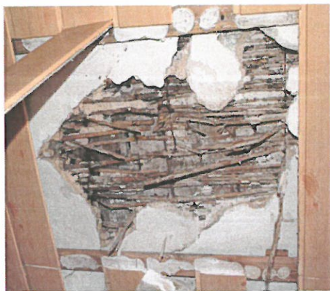
Zd.21. Przykład destrukcji stropów konstrukcji drewnianej .
