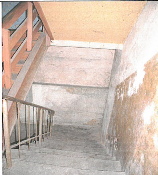
Zd.28. Wyeksploatowane w całości biegi klatki schodowej. Stan techniczny niezadawalający. Ubytki tynków, korozja biologiczna.
