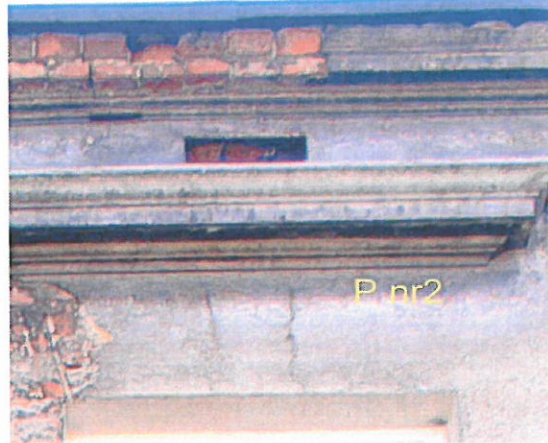
Zd.2. Miejsce pęknięcia nr 2 konstrukcyjne gzymsu, nadproża okna, oraz ściany kolankowej oficyny.
