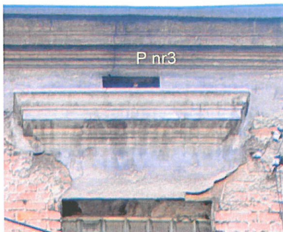
Zd.3. Miejsce pęknięcia nr 3 konstrukcyjne gzymsu, nadproża okna, oraz ściany kolankowej oficyny w pionie klatki schodowej.
