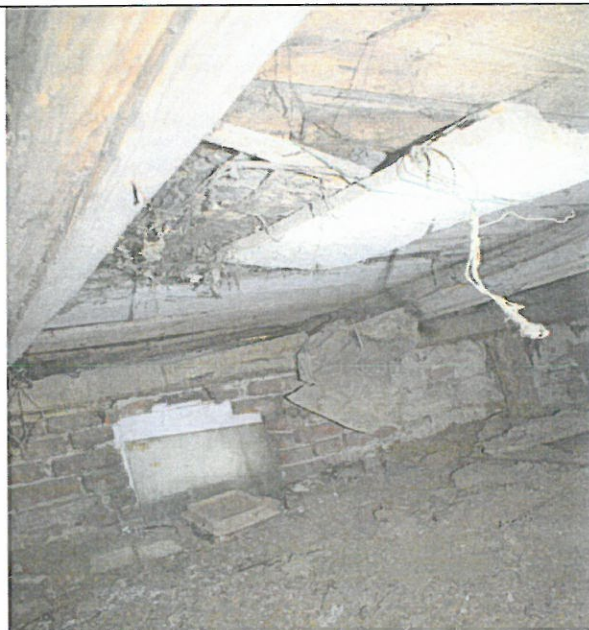
Zd.26. Korozja biologiczna konstrukcji więźby dachowej
