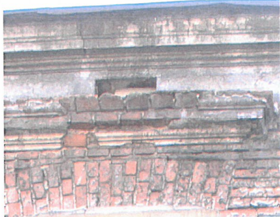
Zd.1. Miejsce pęknięcia nr 1 konstrukcyjne gzymsu, nadproża okna, oraz ściany kolankowej oficyny.
