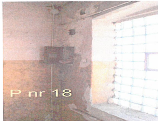
Zd.18. Pęknięcie pionowe na całej wysokości wewnętrznej poprzecznej ściany konstrukcyjnej klatki schodowej łączącej z podłużną.
