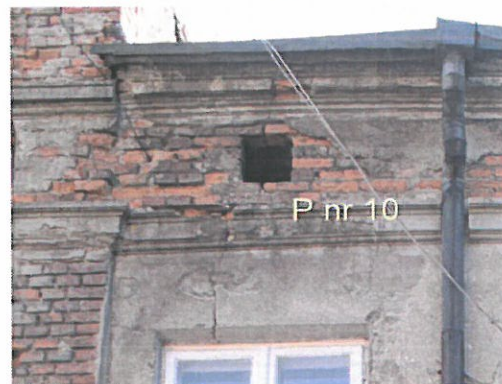
Zd.10. Miejsce pęknięcia nr 10 konstrukcyjne gzymsu, nadproża okna strychoowego, oraz ściany kolankowej przybudówki do oficyny.
