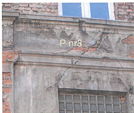
Zd.8. Miejsce pęknięcia nr 8 konstrukcyjne ściany pasa międzyokiennego pomiędzy drugą a trzecią kondygnacją oficyny w pionie klatki schodowej. Pilastr po lewej stronie zdjęcia oznacza miejsce wybudowania ściany nośnej poprzecznej klatki schodowej.
