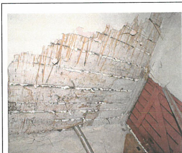
Zd.29. Ubytki wyprawy tynkarskiej na pow. stropu klatki schodowej.
