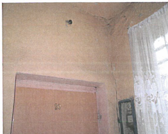
Zd.20. Pęknięcie pionowe na całej wysokości wewnętrznej poprzecznej ściany konstrukcyjnej klatki schodowej łączącej z podłużną.
