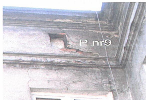
Zd.9. Miejsce pęknięcia nr 9 konstrukcyjne gzymsu, nadproża okna strychoowego, oraz ściany kolankowej przybudówki do oficyny.
