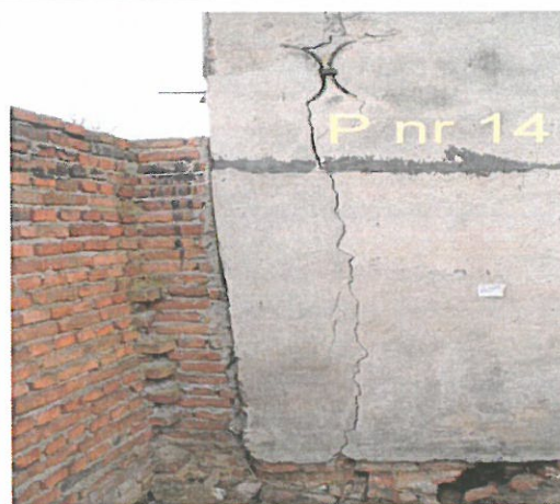
Zd.14. Pęknięcie nr 14 konstrukcyjne pionowe na ścianie tylnej budynku dobudówki do oficyny.
