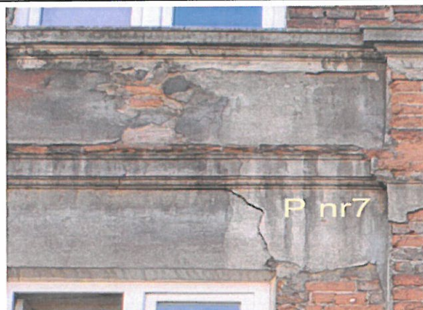
Zd.7. Miejsce pęknięcia nr 7 konstrukcyjne ściany pasa międzyokiennego pomiędzy drugą a trzecią kondygnacją oficyny. Pilastr po prawej stronie zdjęcia oznacza miejsce wybudowania przyległej ściany nośnej poprzecznej klatki schodowej.
