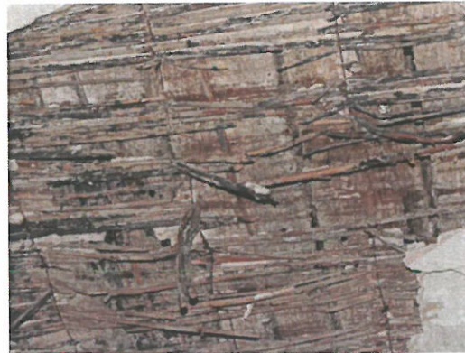
Zd.22. Przykład destrukcji stropu konstrukcji drewnianej.
