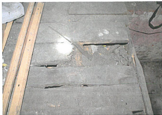
Zd.30. Ubytki destrukcja desek na pow. strychu.
