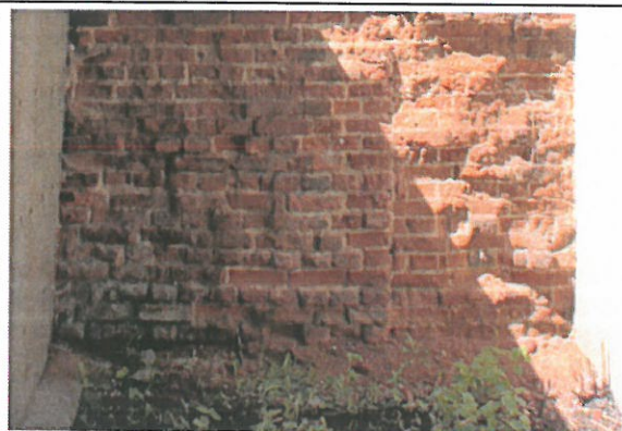
Zd.2. Brak widocznej izolacji poziomej, destrukcja powierzchni muru fundamentowego i ściany budynku od strony zachodniej budynku.
