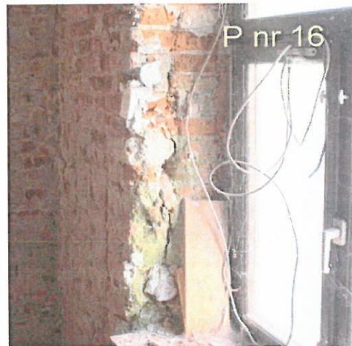
Zd.16. Pęknięcie (rozwarstwienie) pionowe ściany parteru przy otworze okiennym.
