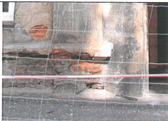
Zd.1. Brak widocznej izolacji poziomej, destrukcja powierzchni muru fundamentowego od strony wschodniej frontowej budynku. Zbyt nisko położone okna parteru. Ubytki cegieł w płaszczyźnie ściany.
