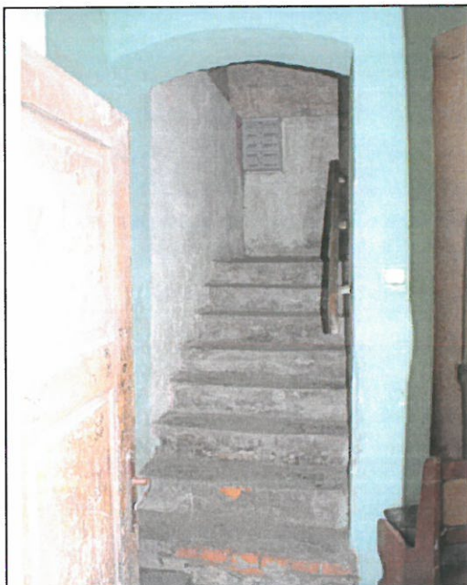
Zd.27. Wyeksploatowane w całości biegi klatki schodowej. Stan techniczny niezadawalający.
