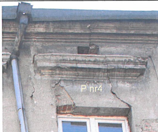
Zd.4. Miejsce pęknięcia nr 4 konstrukcyjne gzymsu, nadproża okna, oraz ściany kolankowej oficyny.
