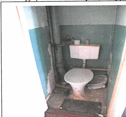
Zd.30 Przykładowa destrukcja węzła sanitarnego.
