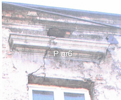
Zd.6. Miejsce pęknięcia nr 6 konstrukcyjne gzymsu, nadproża okna, oraz ściany kolankowej oficyny.
