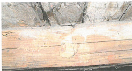
Zd.25. Korozja biologiczna konstrukcji więźby dachowej.
