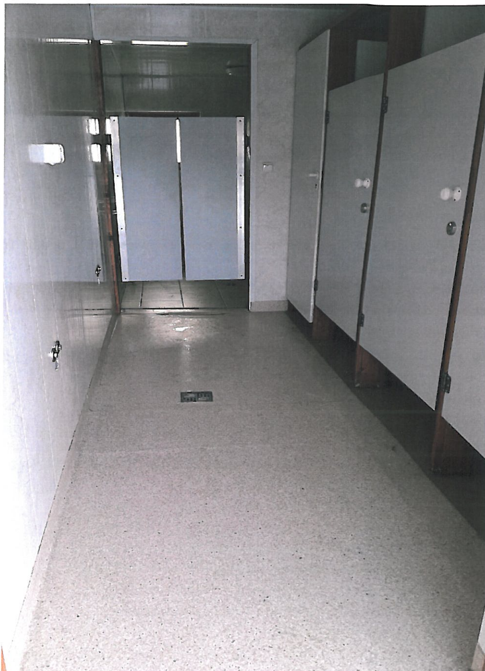
Zdjęcie nr 1. Widok podłogi w przebieralni w budynku FOK (pom. jednej przebieralni).
