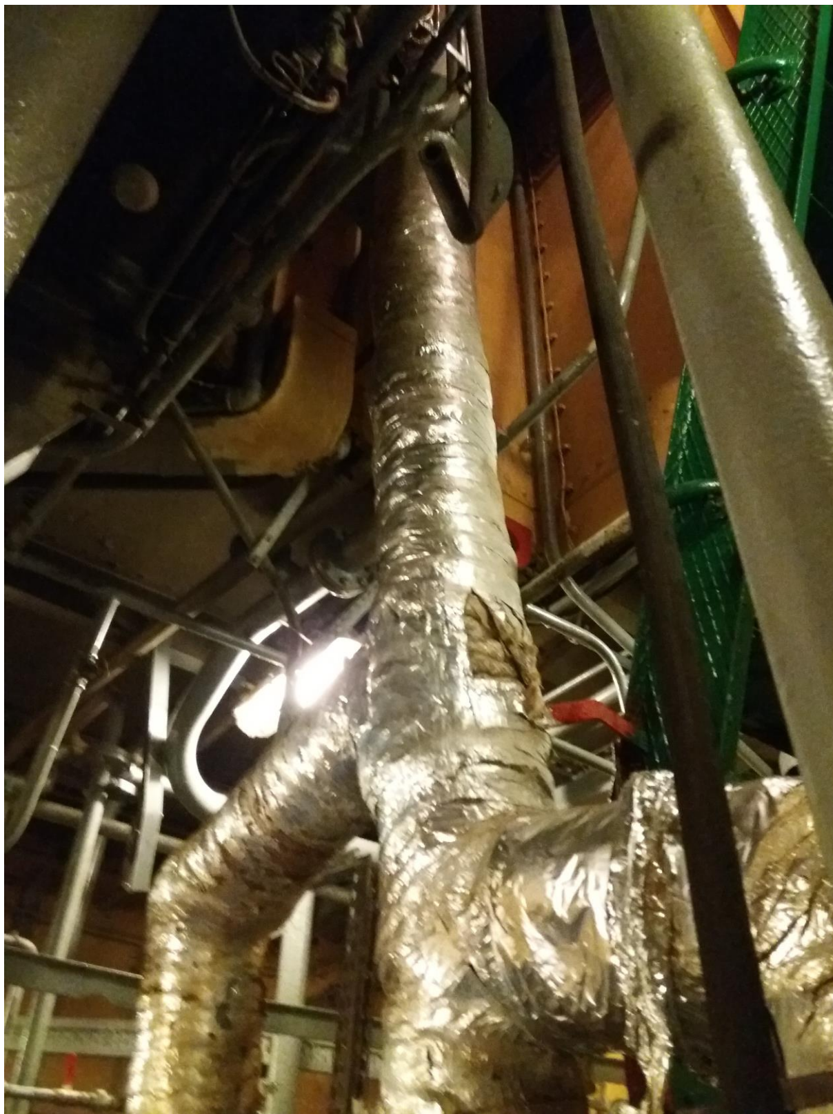
Zdjęcie 17 kolektor odlotu spalin spalni
