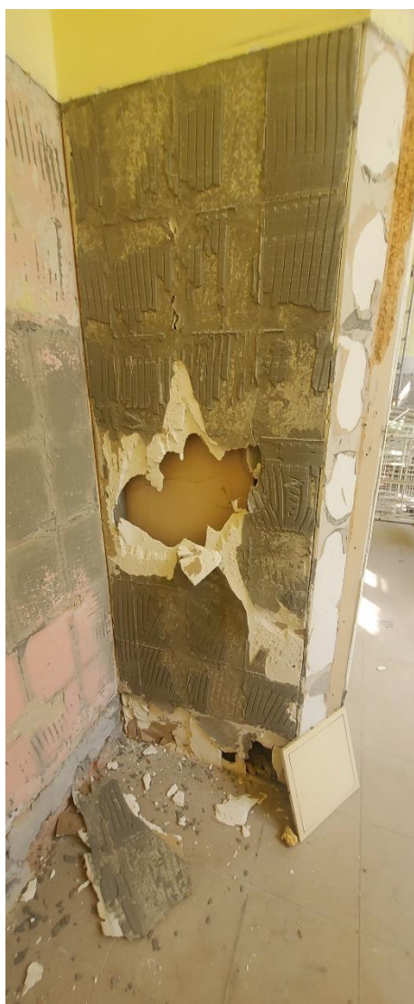
Rysunek 3 Uszkodzenie zabudowy szachtu
