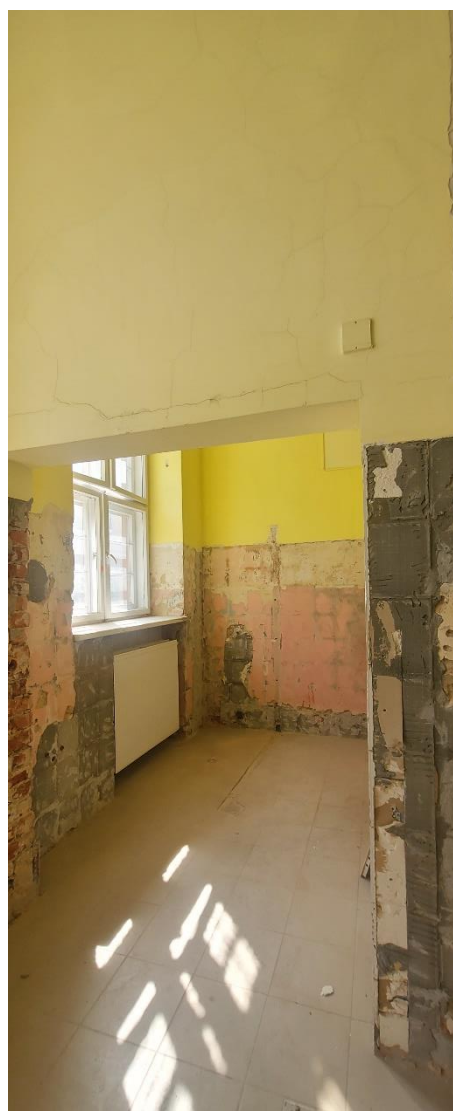
Rysunek 4 Zarysowanie tynku nad nadprożem w przejściu do magazynu
