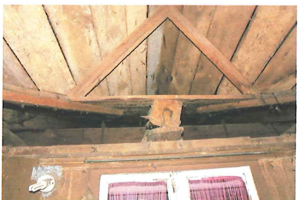
Ryc. 20 Odcięta krokiew na osi okna i zadaszenia lukarny /ślad wtórnej realizacji ściany lukarny ?/
