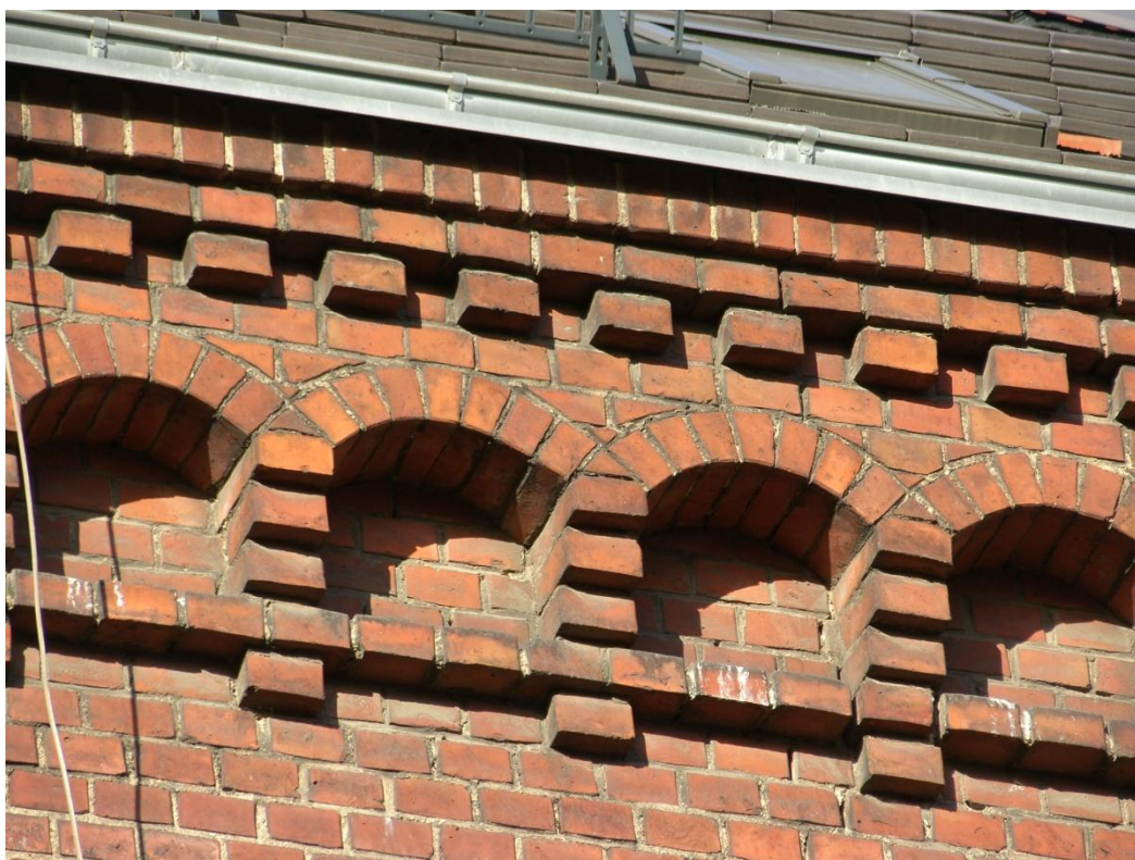
22. Gzyms arkadkowy podokapowy. Brak śladów tynkowania blend.
