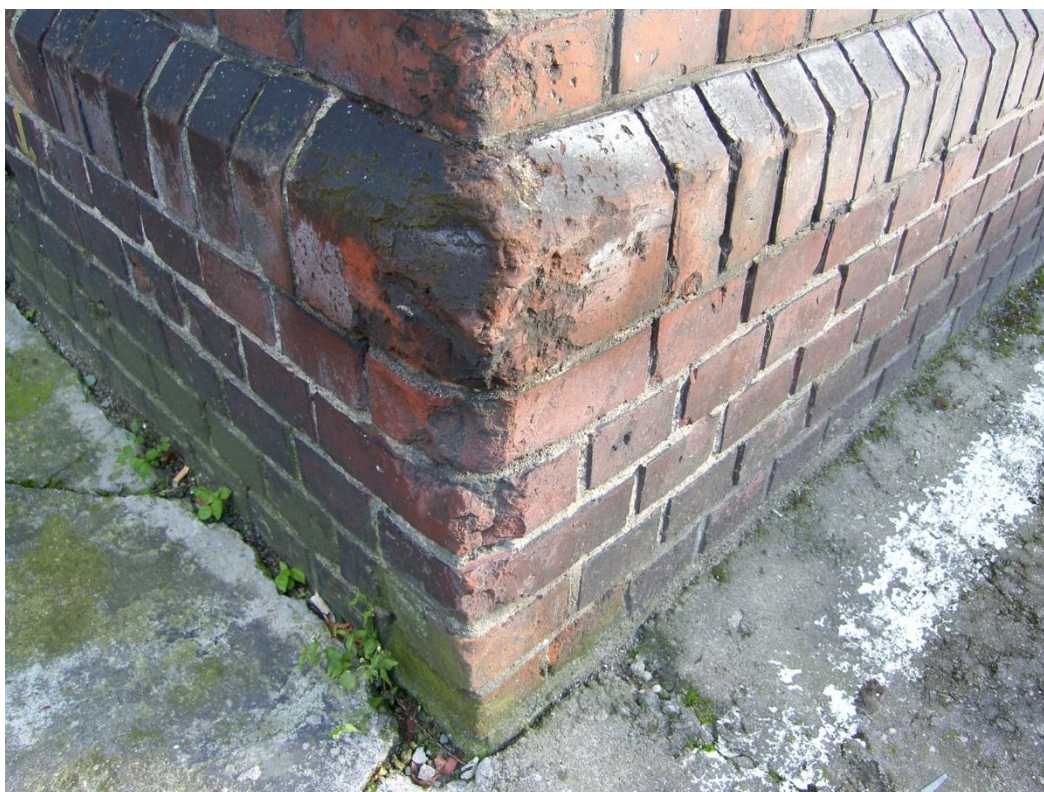
24. Stan zachowania narożnika północnego. Widoczne zawilgocenie przyziemia i porażenie glonami.
