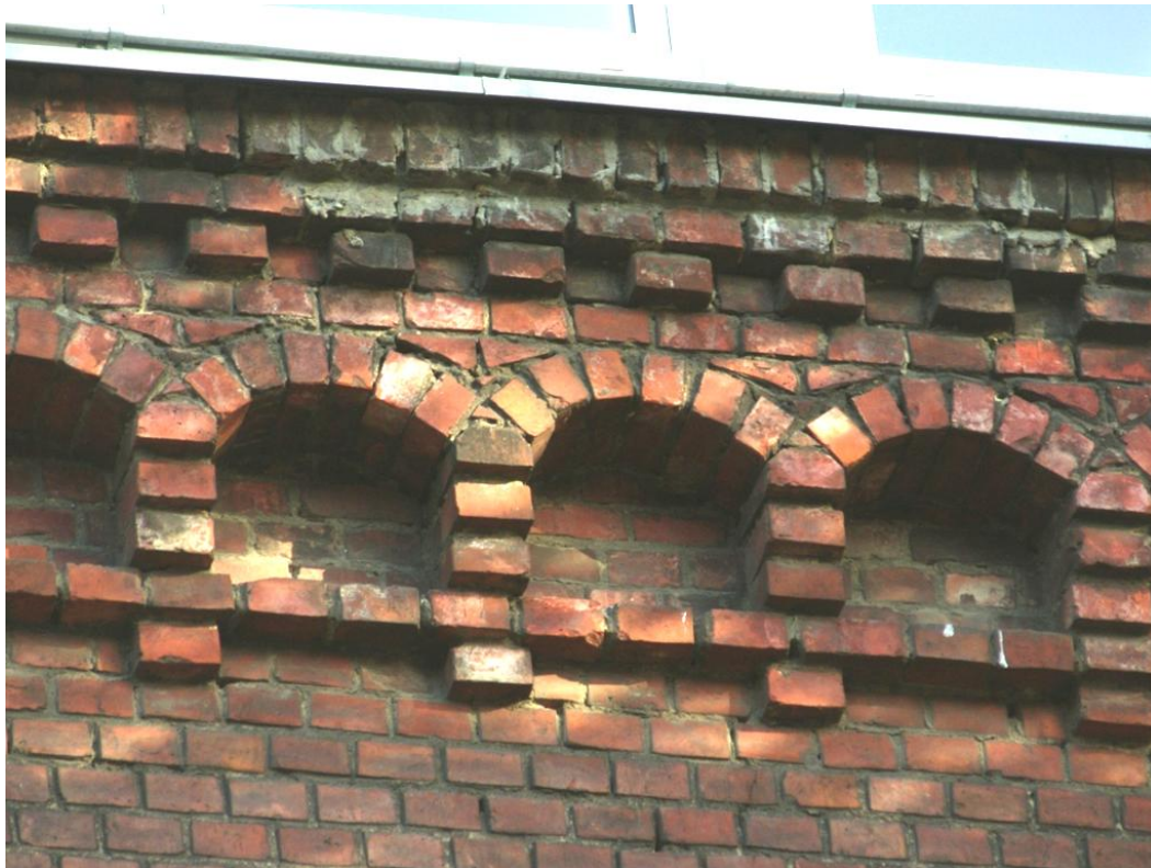
33. Odbudowany fragment gzymsu podokapowego. Konieczna naprawa, oczyszczenie i scalenie kolorystyczne.
