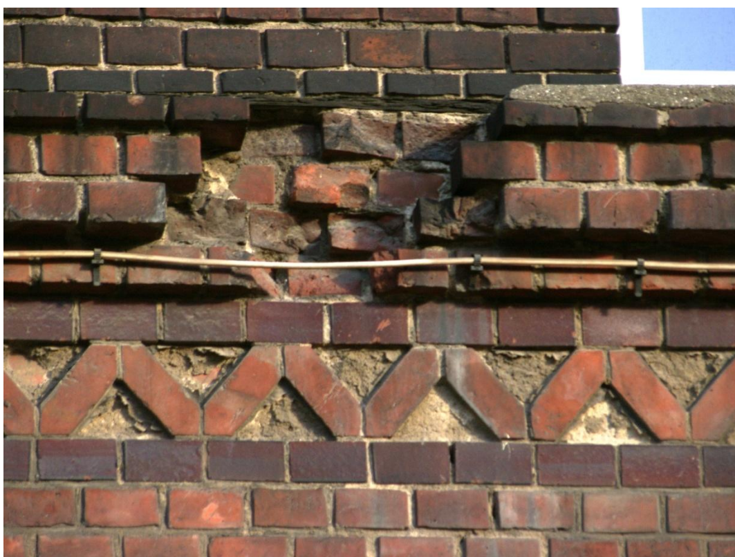
30. Fryz z pasami cegły glazurowanej. Widoczne ubytki tynku oraz zniszczenia w obrębie gzymsu i jego nakrywy.
