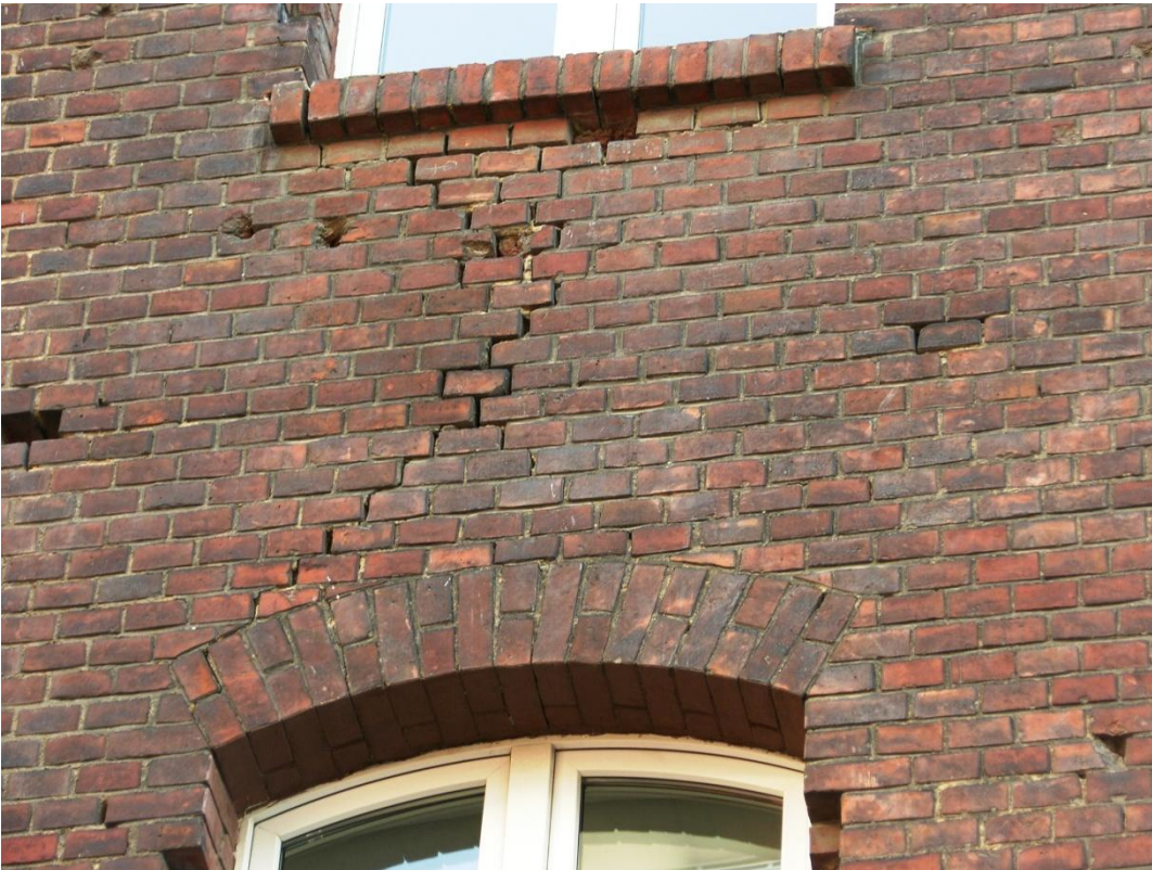
54. Spękania lica należy przeszyć z wypełnieniem fugą.
