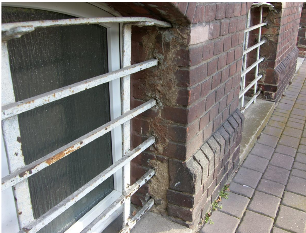
21. Uszkodzenia ościeży okien przyziemia spowodowane osadzeniem krat.
