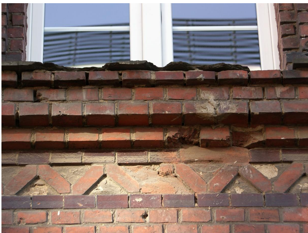
50. Fryz z widocznymi uszkodzeniami cegieł, tynków oraz kamiennych nakryw.
