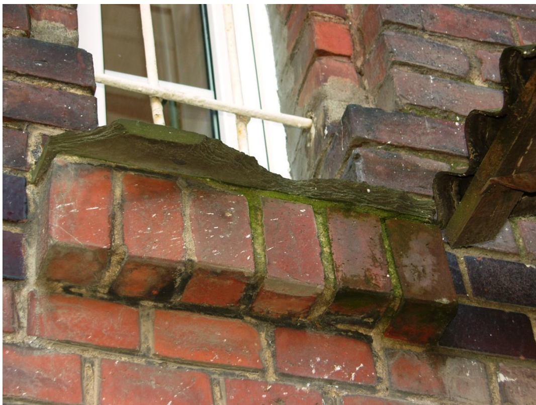
49. Zniszczony kamienny parapet okna.
