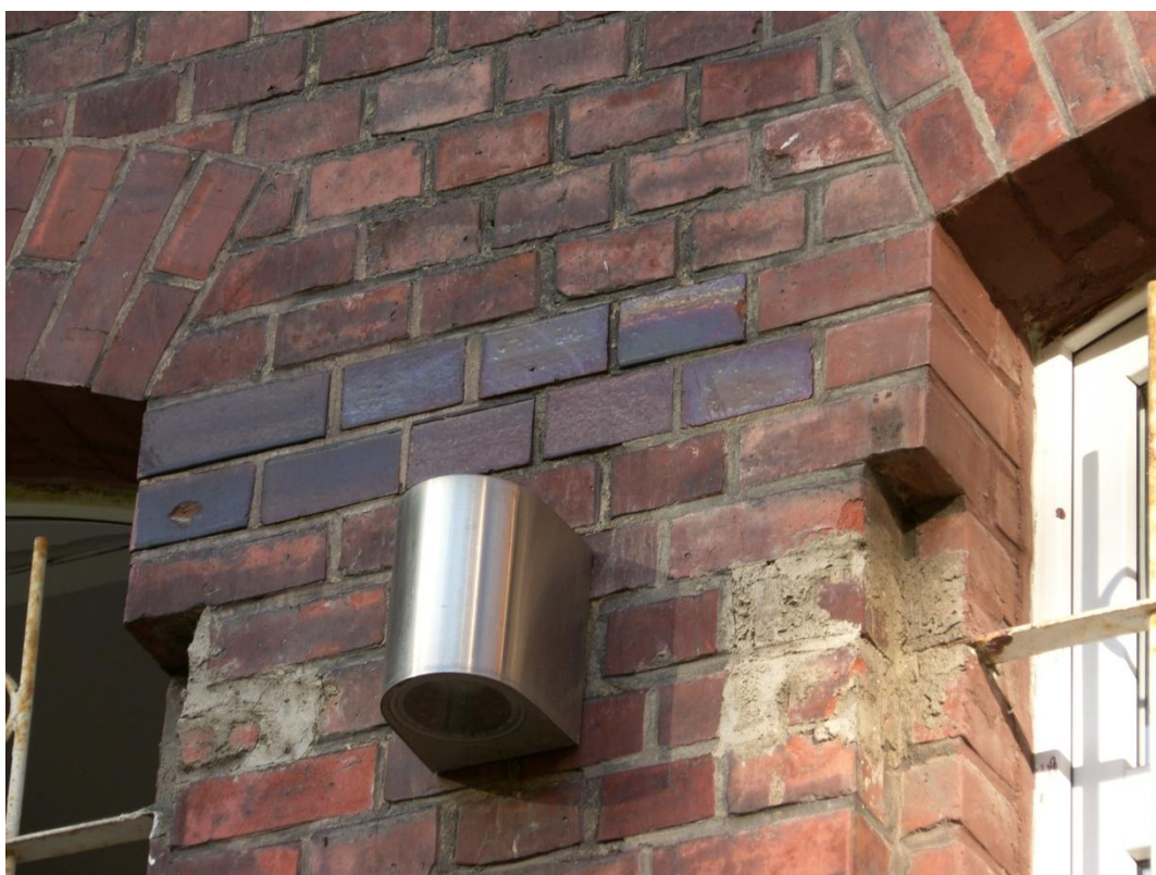
20. Iluminacja elewacji oraz ślady po wtórnym osadzeniu krat okiennych.
