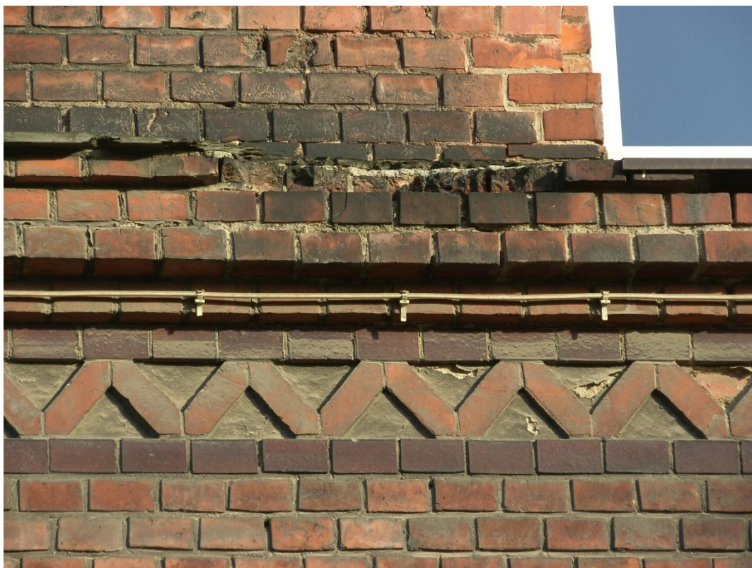
29. Fryz z pasami cegły glazurowanej. Widoczne ubytki tynku oraz zniszczenia w obrębie gzymsu i jego nakrywy.
