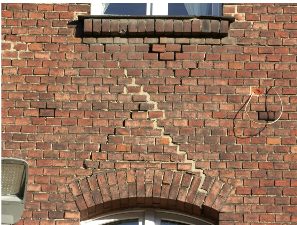
32. Ukośne spękania w elewacji - do zszycia i wypełnienia fugą.
