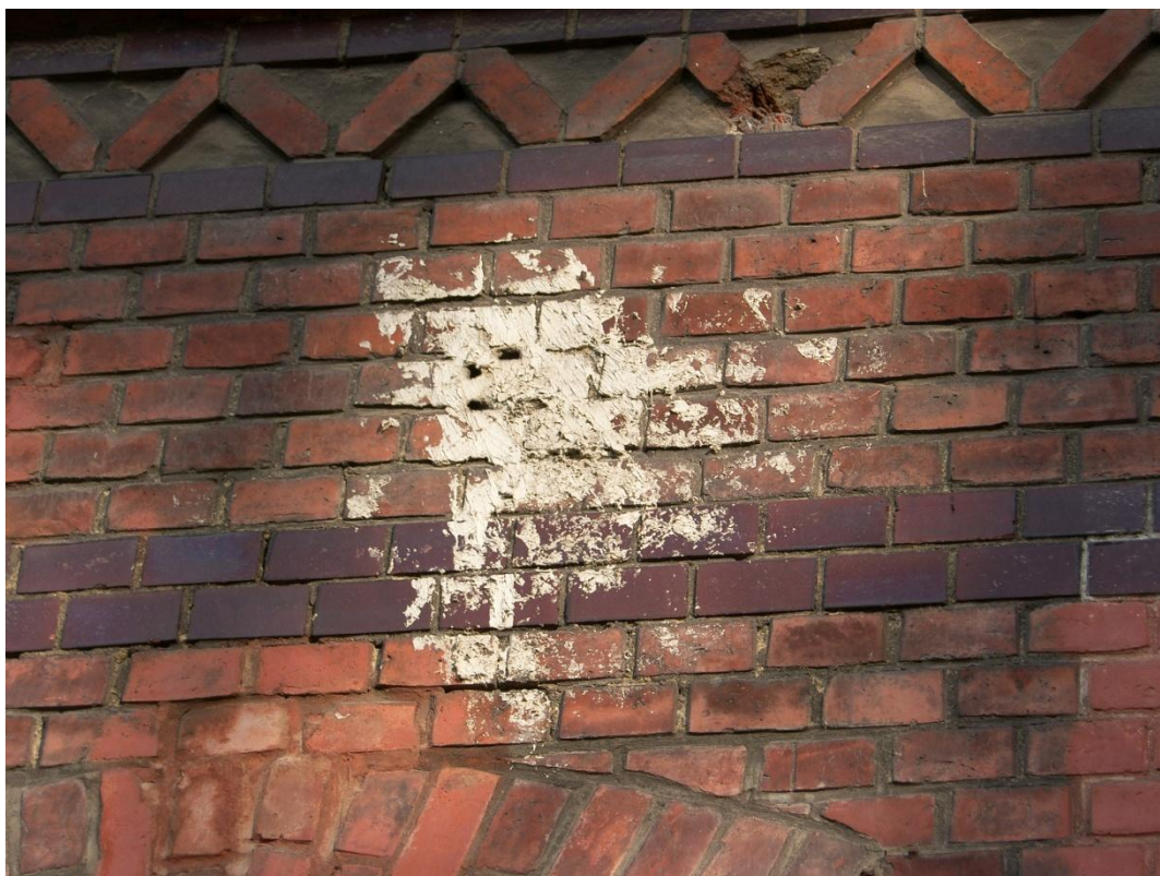
19. Zabrudzenia elewacji zaprawą oraz uszkodzenia cegieł.
