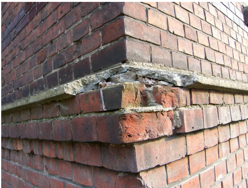
27. Wtórne pokrycie gzymsu parteru zaprawą cementową oraz uszkodzenie narożnika.
