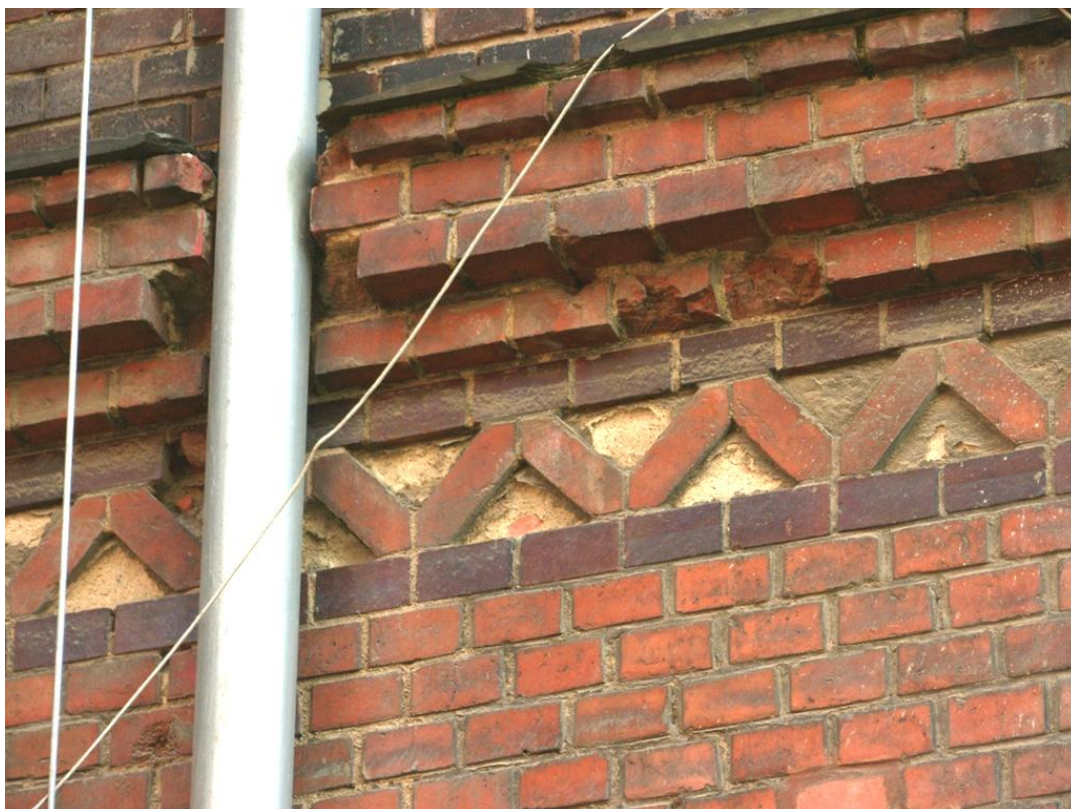
55. Uszkodzenia fryzu, m.in. spowodowane przeprowadzeniem rury spustowej.
