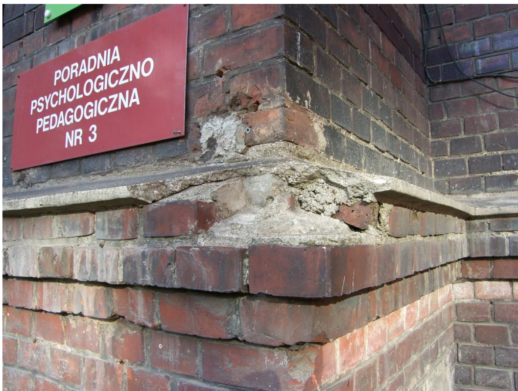
9. Zniszczony narożnik partii cokołowej po wschodniej stronie wejścia głównego.
