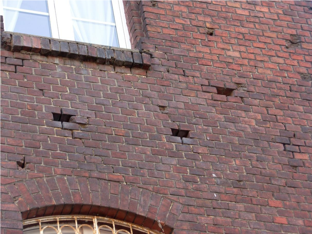
53. Ubytki cegieł w licu.
