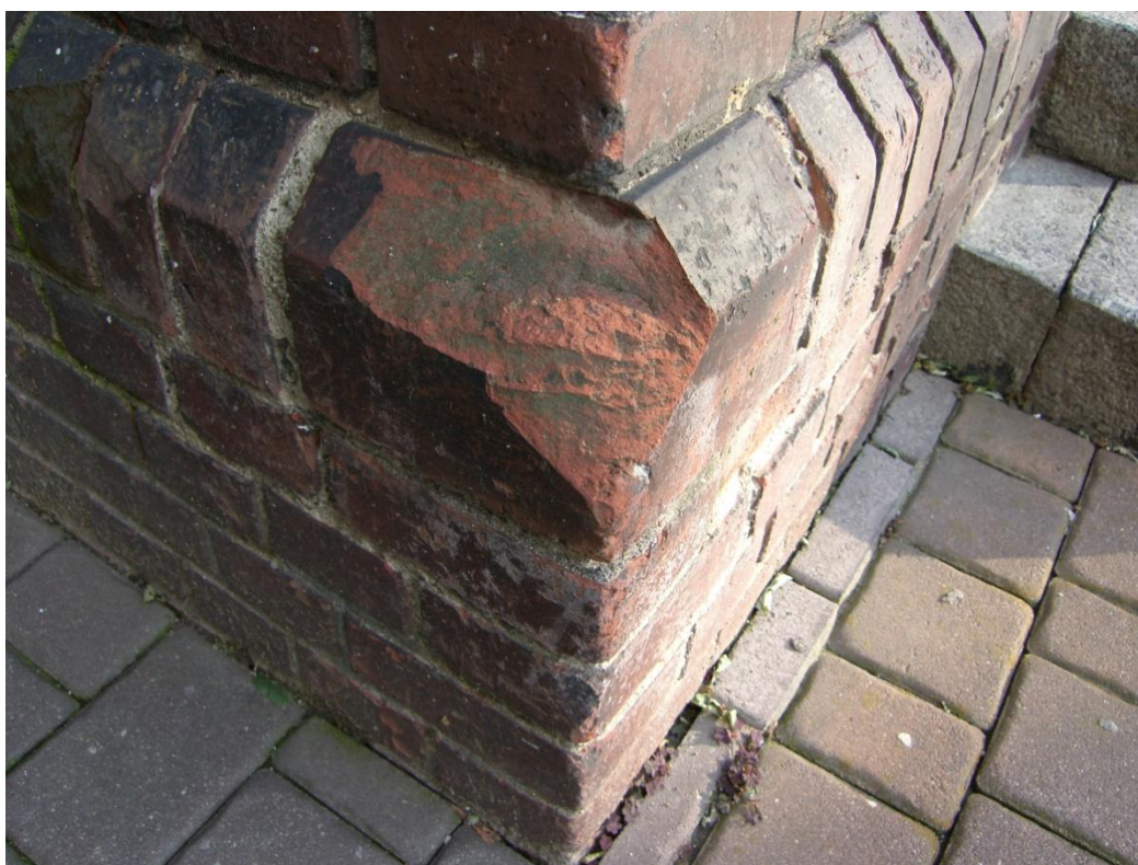
14. Uszkodzony narożnik zachodni cokołu.
