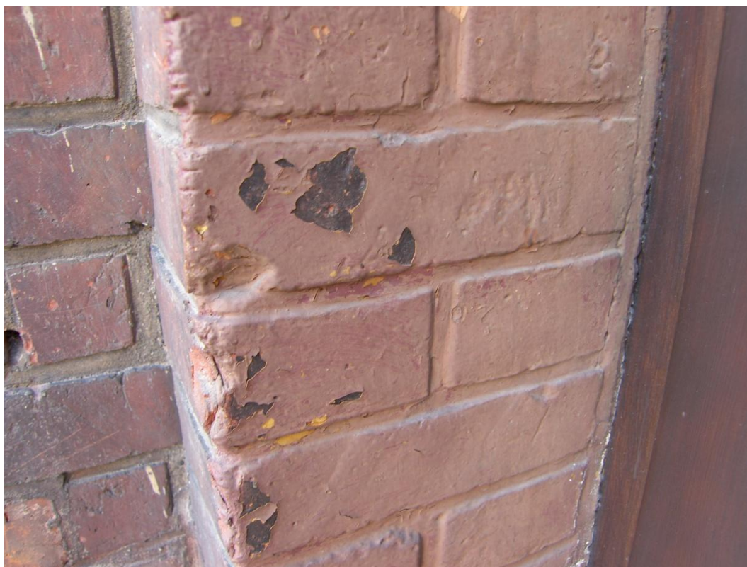
12. Malowanie ościeża drzwi - konieczne usunięcie.
