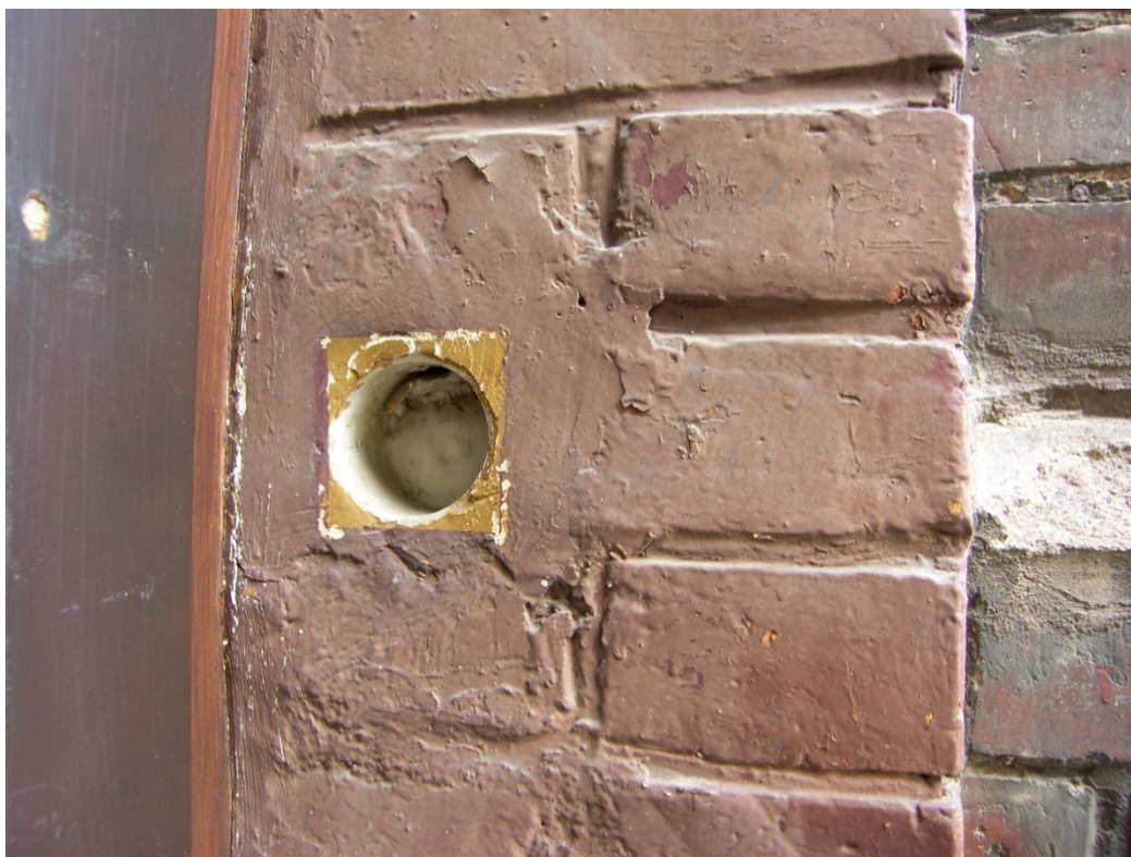
13. Malowanie ościeża drzwi i ślad po usuniętym włączniku dzwonka. Konieczne przemurowanie i usunięcie wymalowania.
