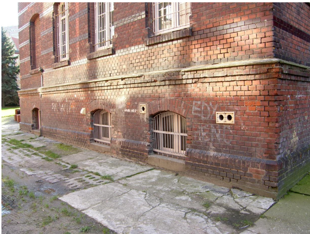
43. Część południowa, strefa przyziemia. Widoczne uszkodzenia gzymsu i nakryw oraz wtórnie osadzone instalacje wentylacji.
