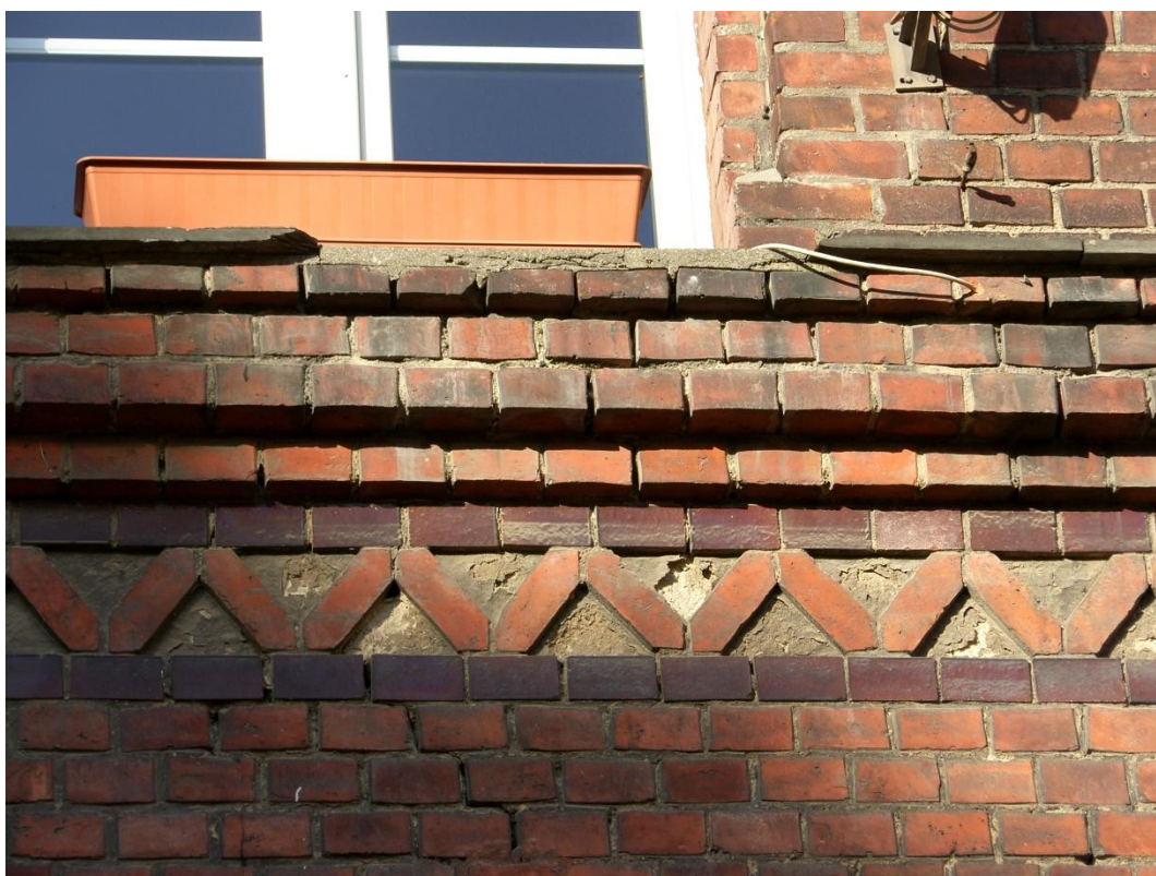
18. Stan zachowania fryzu oraz nakryw gzymsu.
