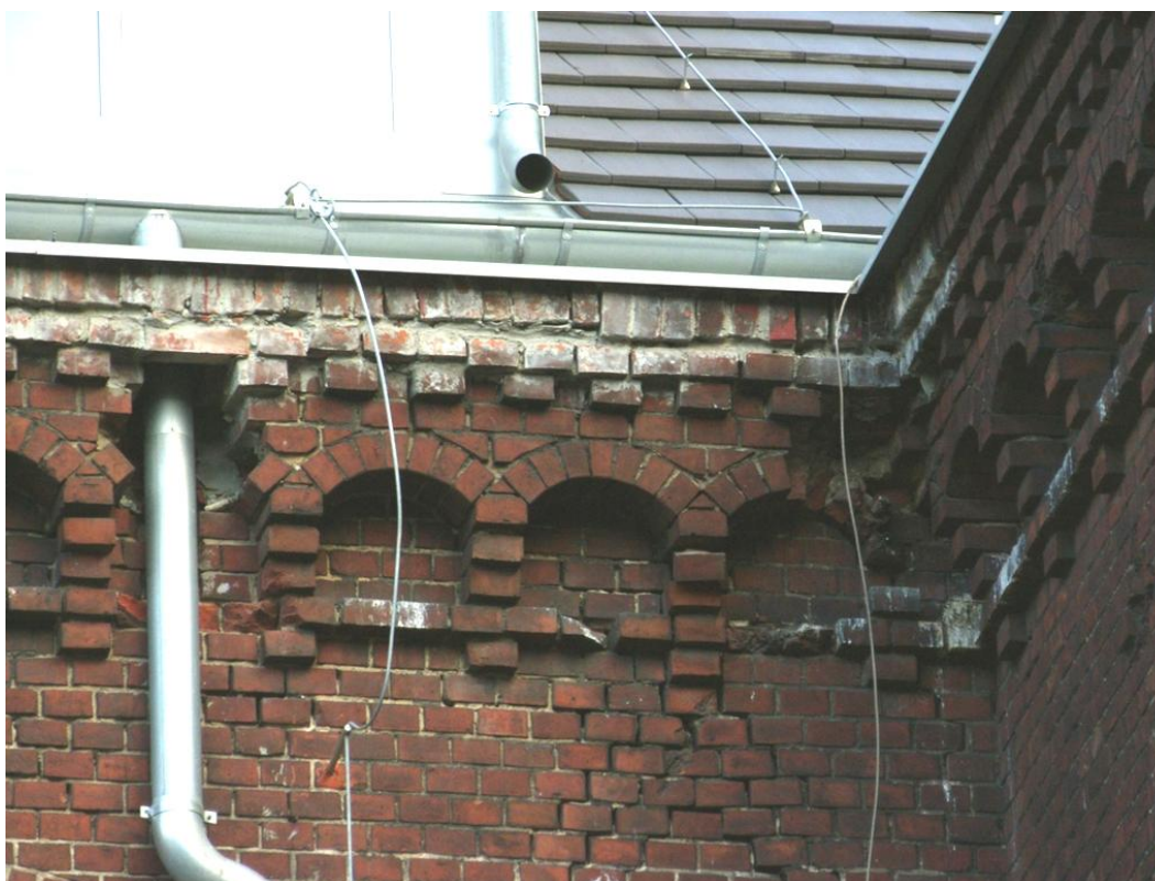
34. Zniszczenia i przemurowania w obrębie gzymsu podokapowego.
