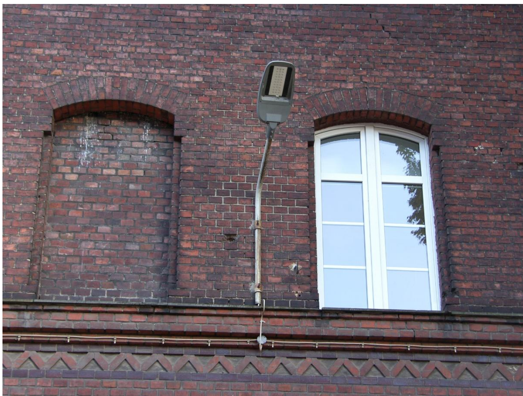
36. Okno i blenda na I piętrze. Widoczne rozprowadzenie instalacji do oświetlenia.
