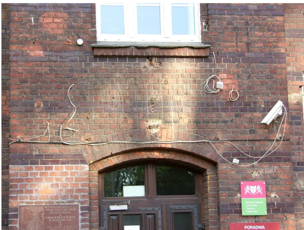
16. Nad wejściem głównym widoczne liczne instalacje, konieczne do uporządkowania i zamaskowania w licu.
