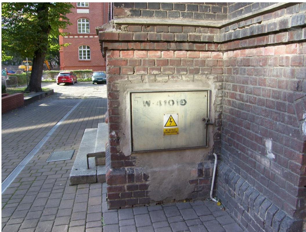
11. Rozdzielnia elektryczna po wschodniej stronie ryzalitu wejścia głównego. Konieczne wykonanie przemurowania oraz konserwacja antykorozyjna ramy i drzwi rozdzielni.
