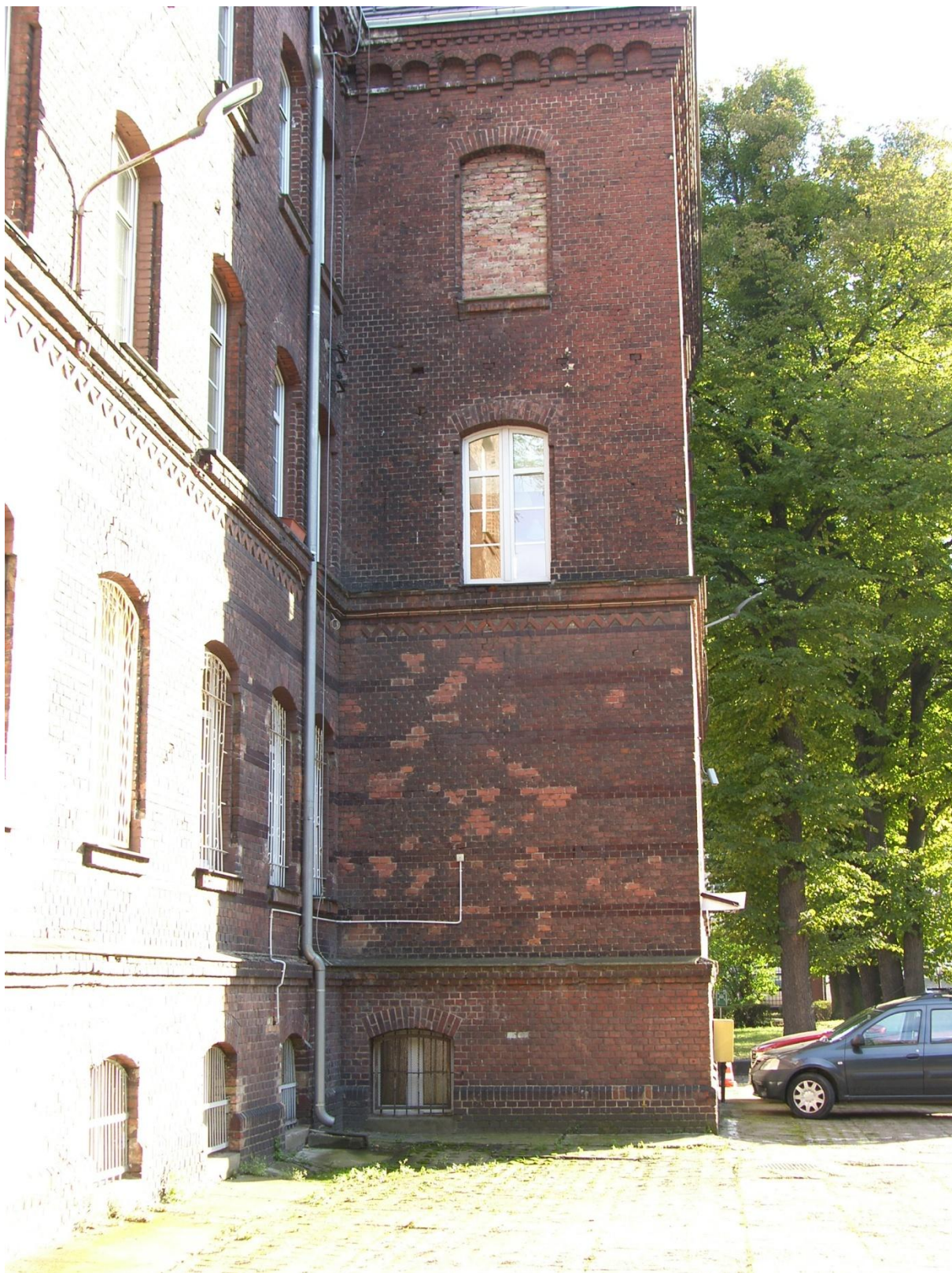
35. Elewacja północna południowej części elewacji zachodniej. Widoczne zamurowane okno. Proponowana wymiana fugowania i scalenie kolorystyczne cegieł.
