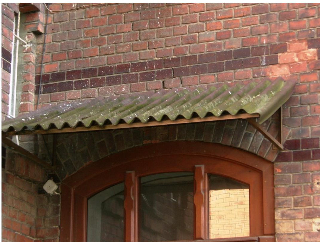
56. Zadaszenie wejścia wschodniego. Proponowana wymiana na szklane lub poliwęglanowe.
