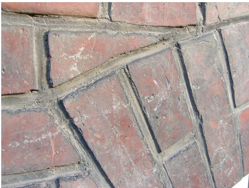
28. Stan lica ceglanego oraz widoczne płaskie kształtowanie fugi.
