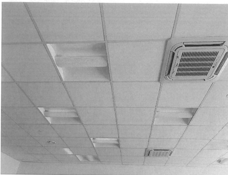
(fot. Ramy oświetlenia odbijają światło od dołu powodując rozproszenie światła)
