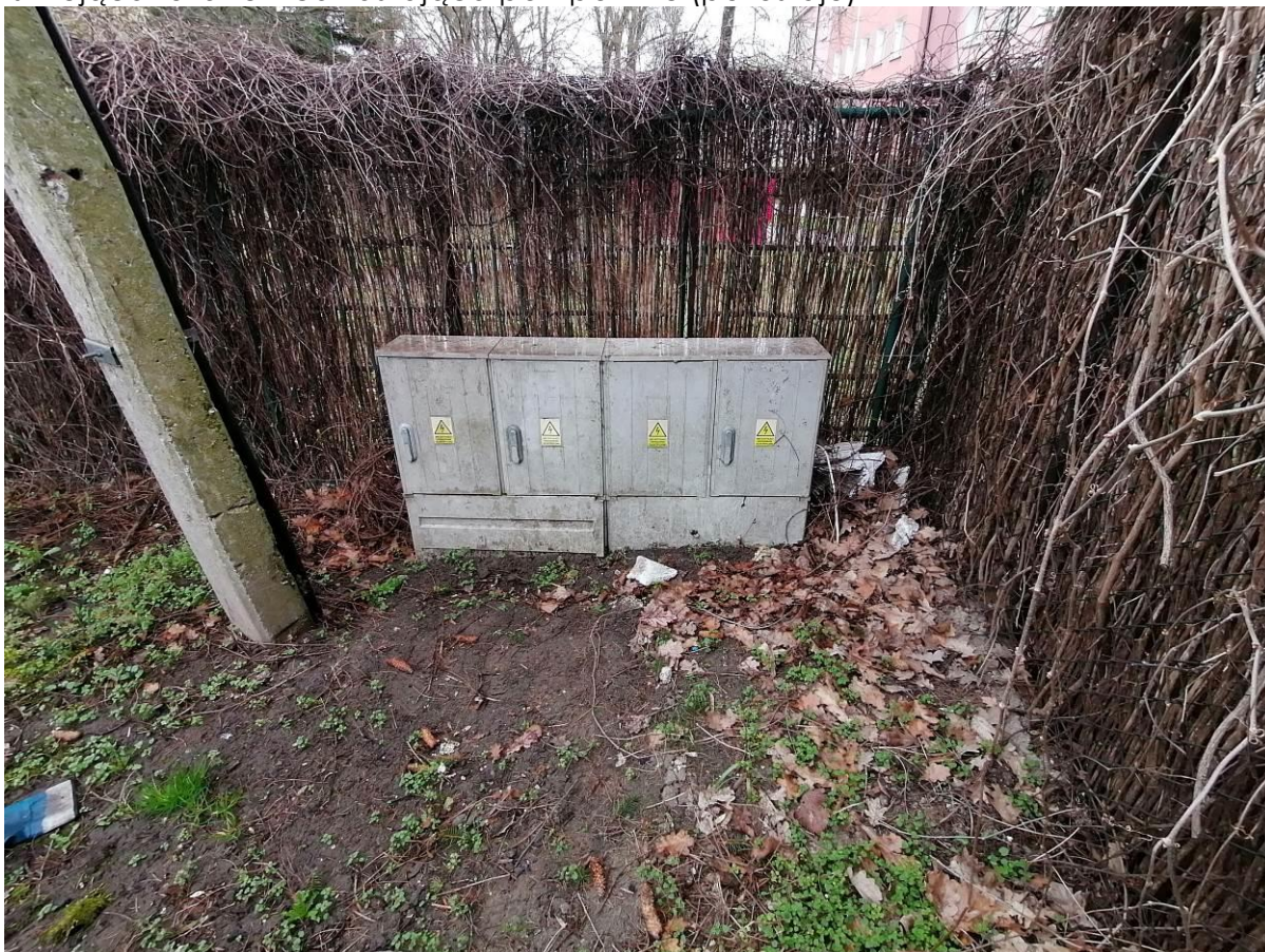
Istniejąca rozdzielnica zasilająca pompownię (pozostaje)
