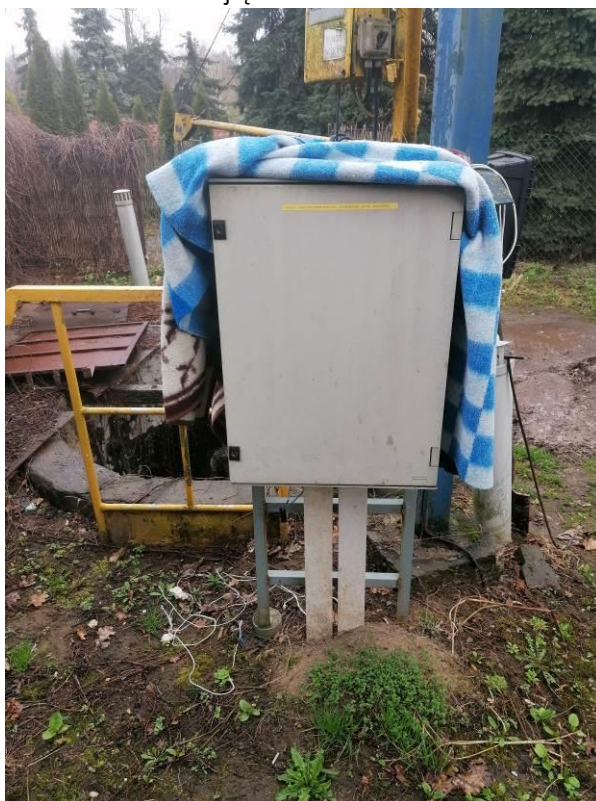
Szafka sterująca do demontażu
