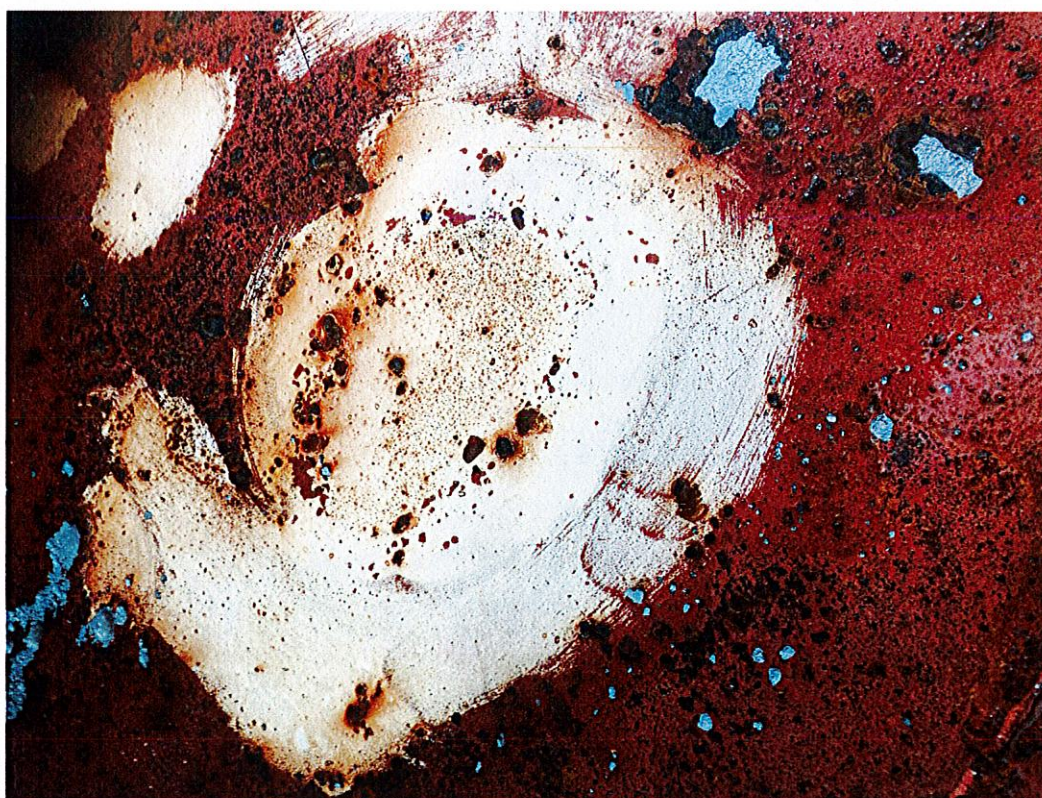
Zdj. 2. Dennica zbiornika – brak izolacji widoczna warstwa penetratora (podkładu)
