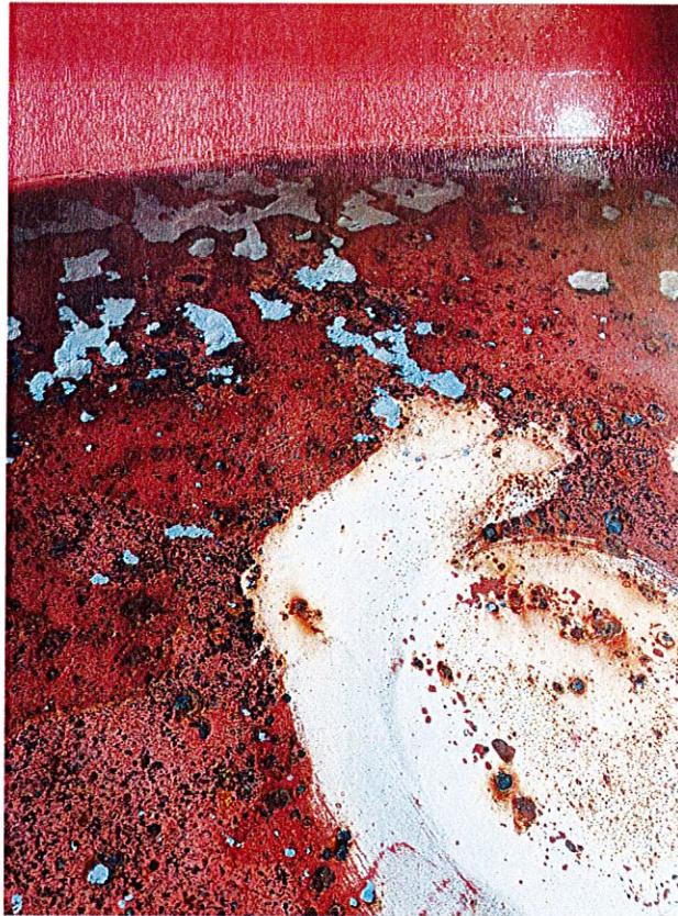
Zdj. 3. Dennica zbiornika – brak izolacji widoczna warstwa penetratora (podkładu), widoczne wżery do czystej stali.
