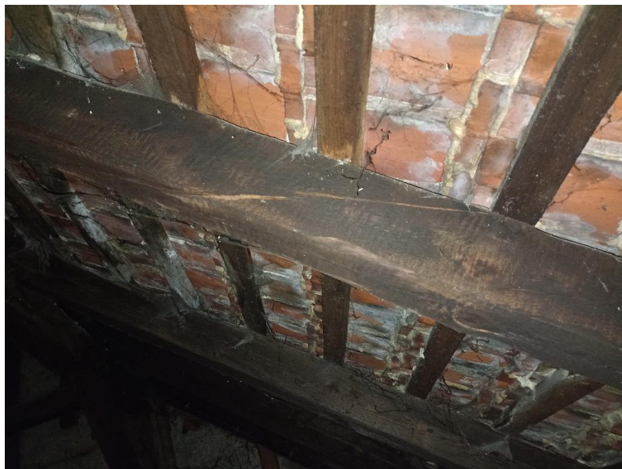
Rysunek 5 Pęknięcie krokwi
