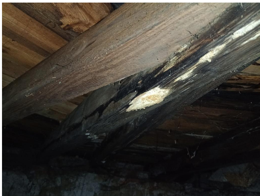
Rysunek 2 Zawilgocone końcówki krokwi oraz murłaty
