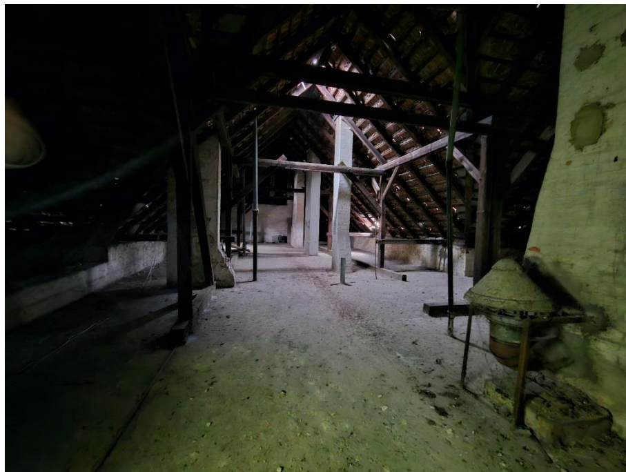
Rysunek 1 Grzyb na konstrukcji dachu narożników
