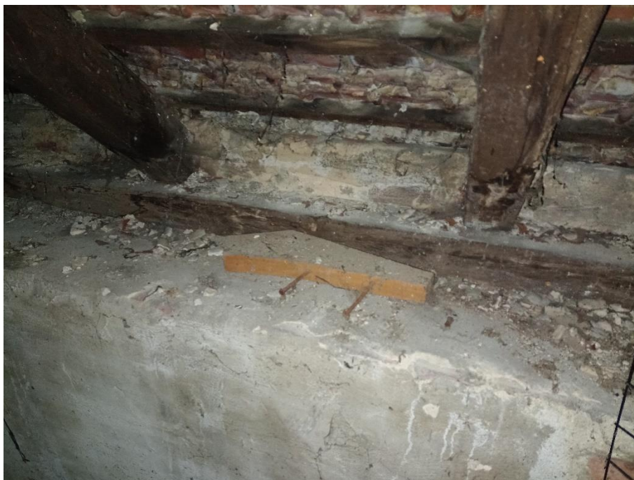
Rysunek 3 Zawilgocone końcówki krokwi oraz murłata
