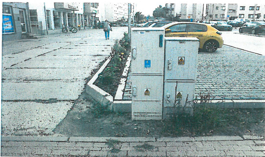
Złącze kablowe oświetleniowe przy sklepie AS, własność UM Wschowa.
