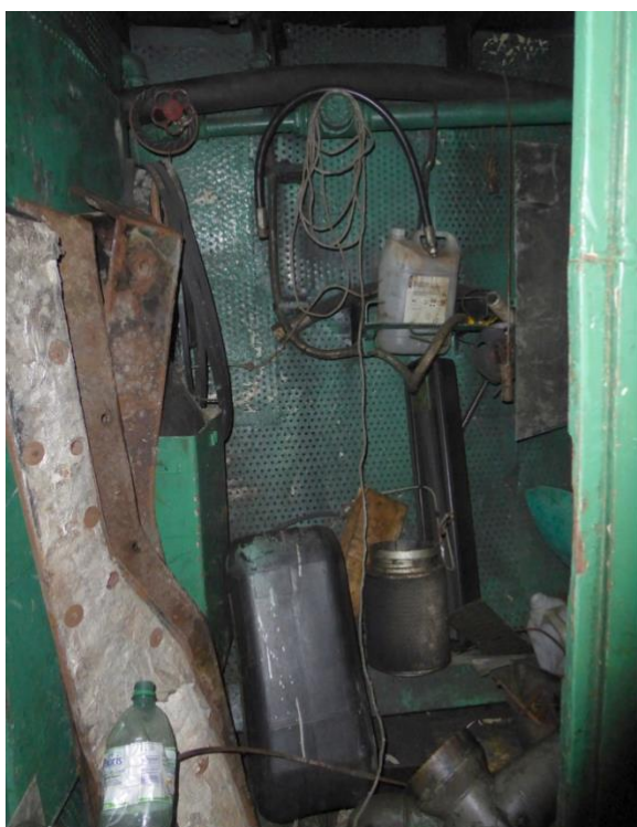
Il.17. Wnętrze pomieszczenia C.O.
