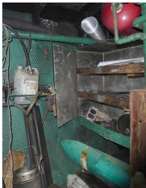
Il.18. Wnętrze pomieszczenia C.O.
