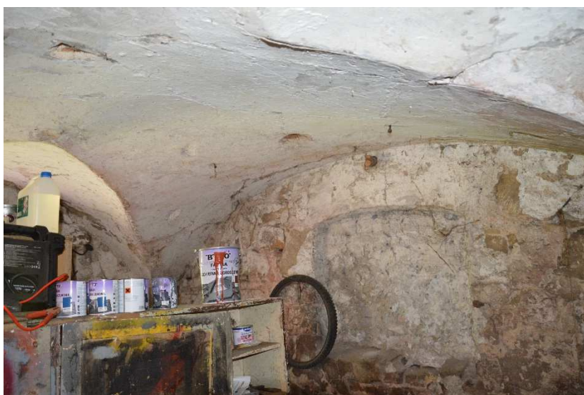
Fot. 9 – Spękania ukośne sklepień
