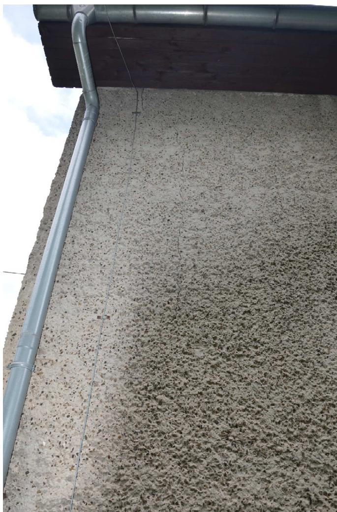
Fot. 4 – Pionowe pęknięcie w narożniku północno – zachodnim elewacji
