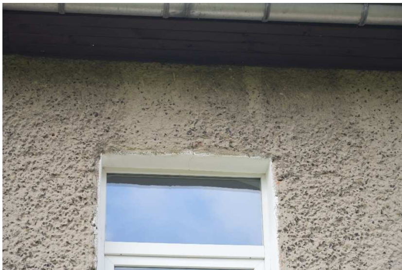
Fot. 3 – Pionowe pęknięcie w strefie nadprozowej ( elewacja południowa)
