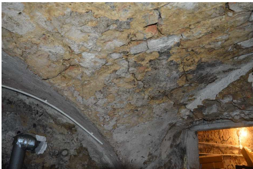
Fot. 8 – Poluzowana konstrukcja murowa sklepień w wyniku odprężenia podparć
