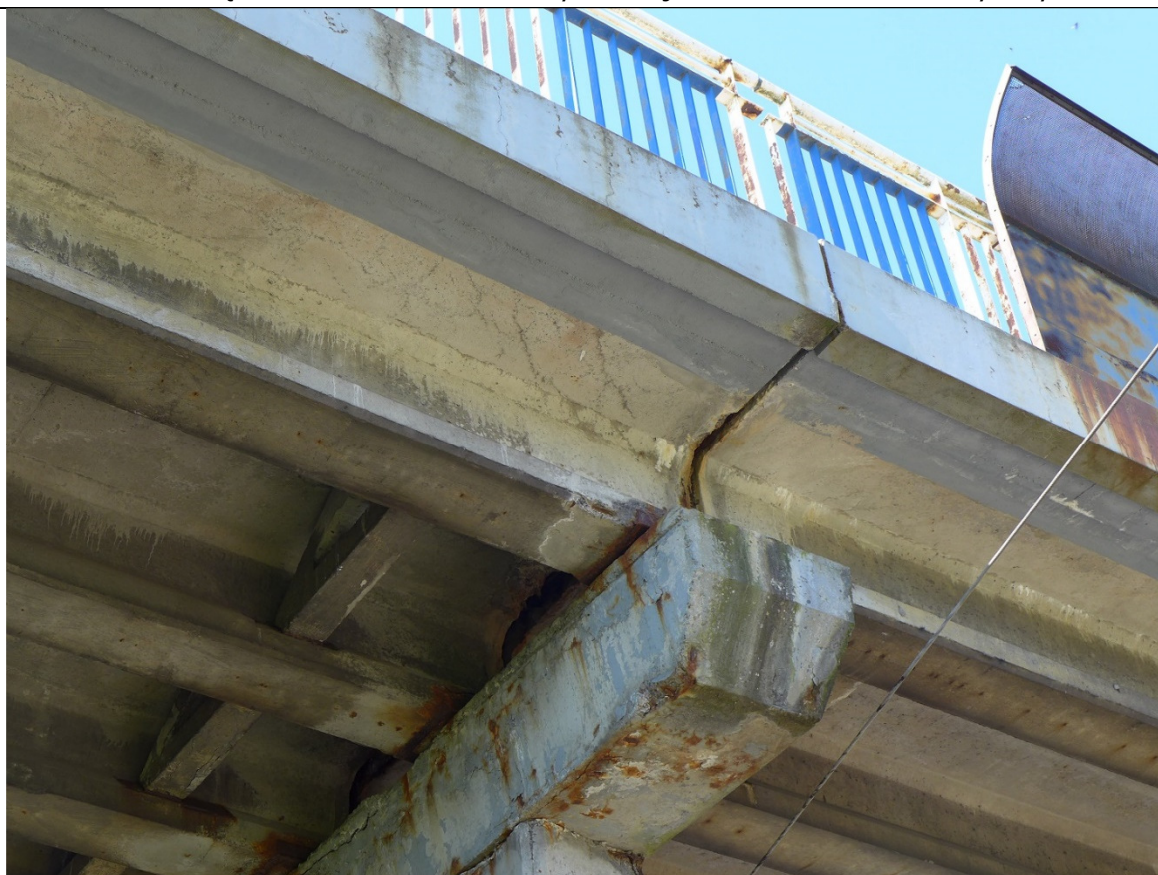
Fot. 8 Filar w osi 3 – widoczne osady, wykwyty, korozja zbrojenia, zarysowania
