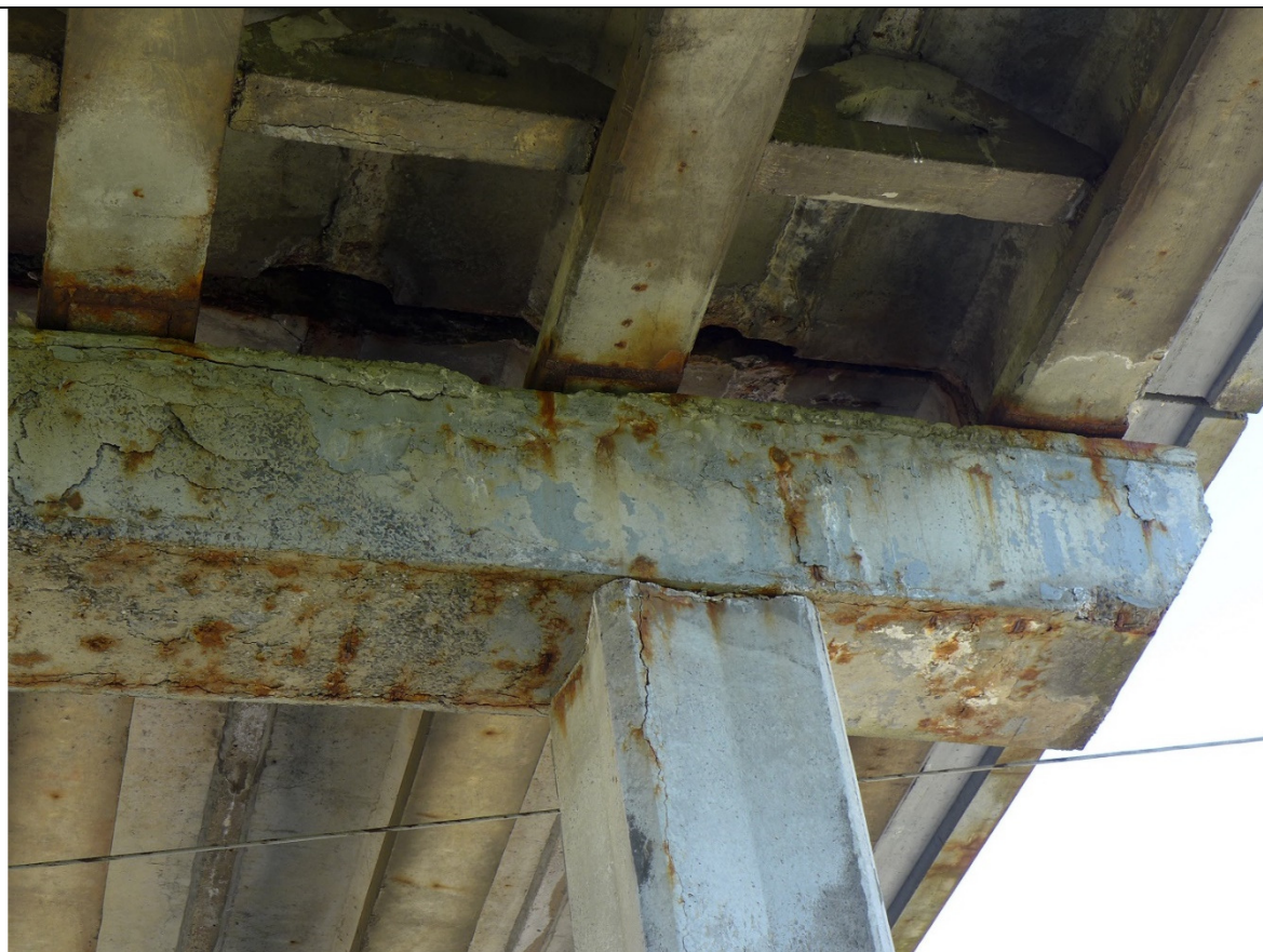
Fot. 5 Filar w osi 3 - zarysowania, ubytki betonu, osady, wykwit, korozja zbrojenia
