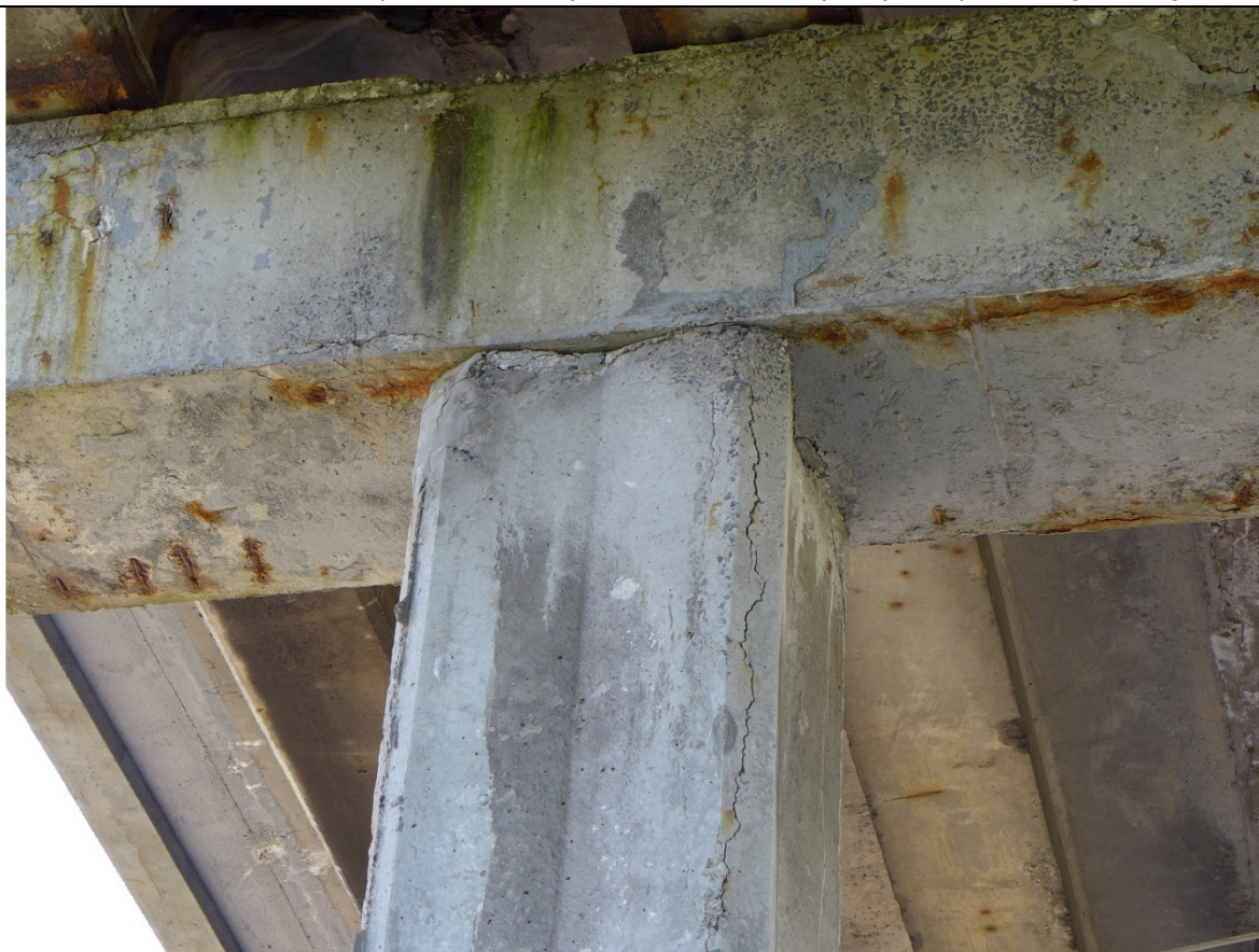
Fot. 6 Filar w osi 3 - widoczne zarysowania pionowe na słupie
