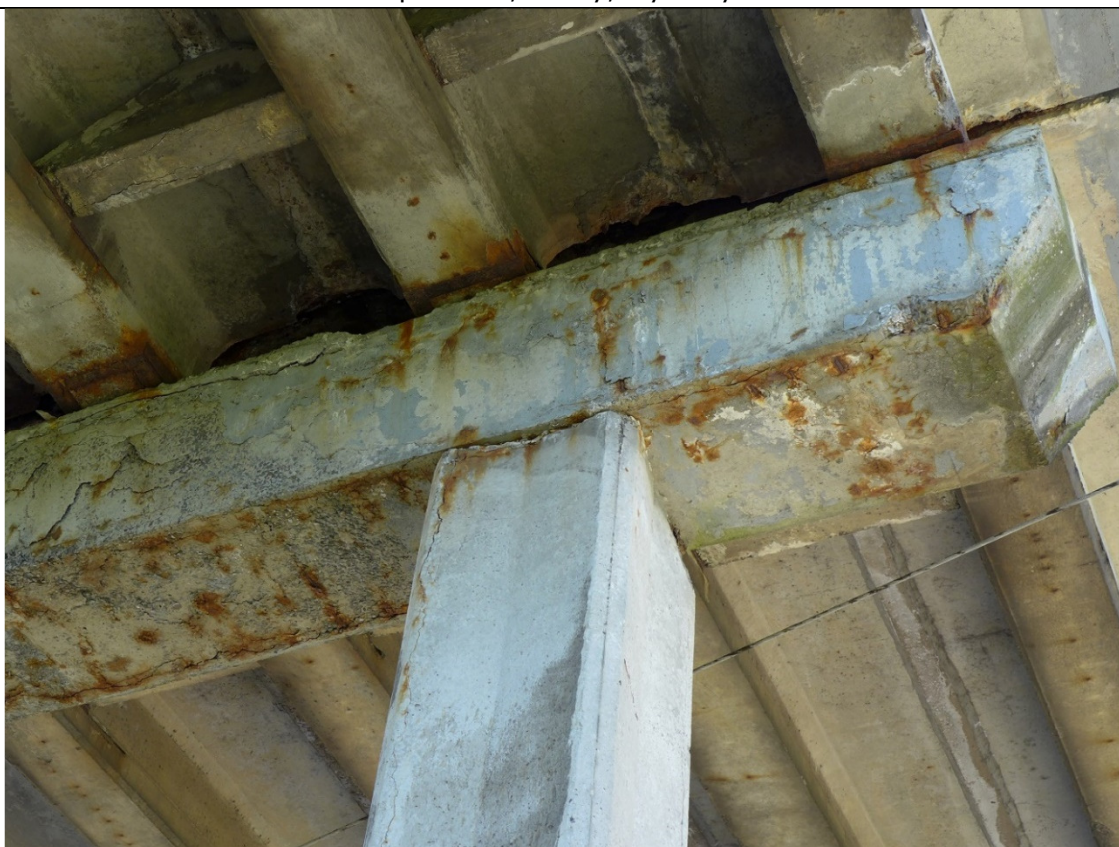
Fot. 10 Filar w osi 3 – widoczna rozległa korozja betonu, spękania i ubytki betonu, osady, wykwit, korozja zbrojenia
