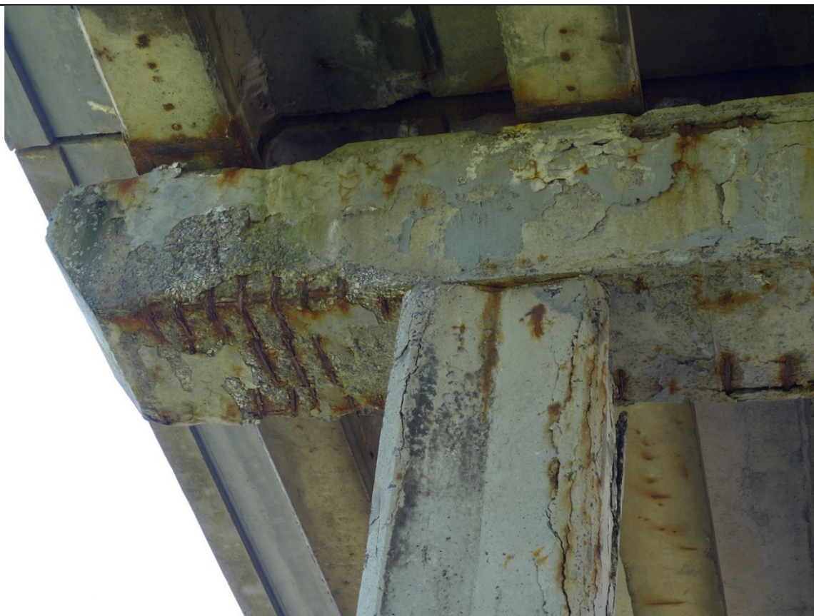
Fot. 21 Filar w osi 2 – widoczna rozległa korozja i ubytki betonu, korozja zbrojenia, osady
