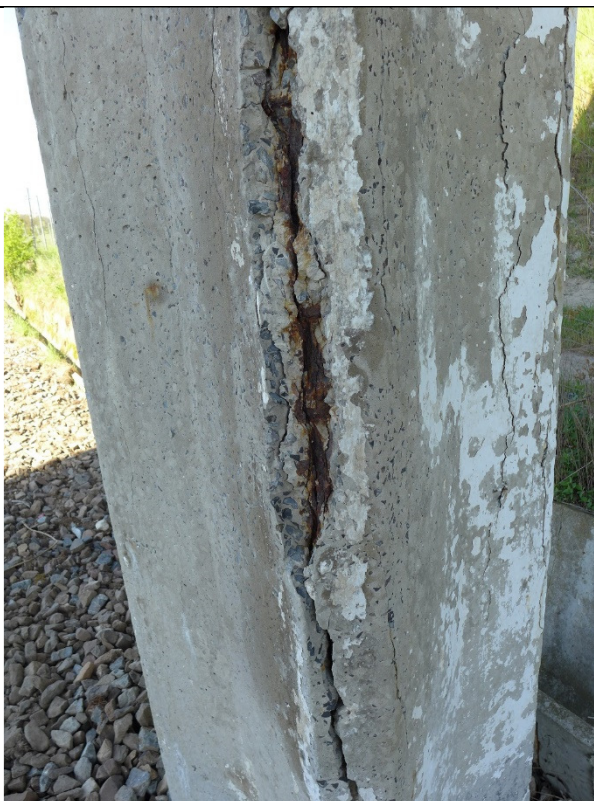
Fot. 19 Słup filara w osi 2 – widoczne pęknięcie i ubytki betonu, korozja zbrojenia
