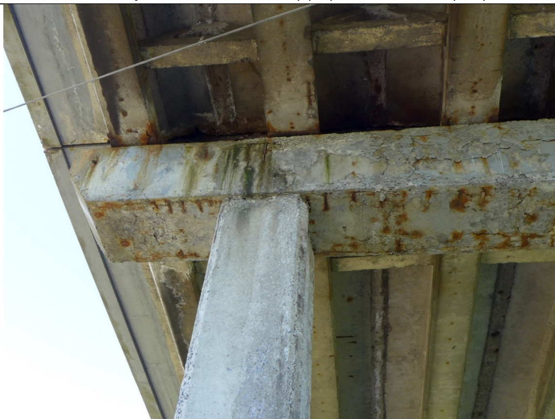
Fot. 14 Filar w osi 2 – widoczne odspojenia i spęknięcia betonu, osady, wykwity, korozja zbrojenia
