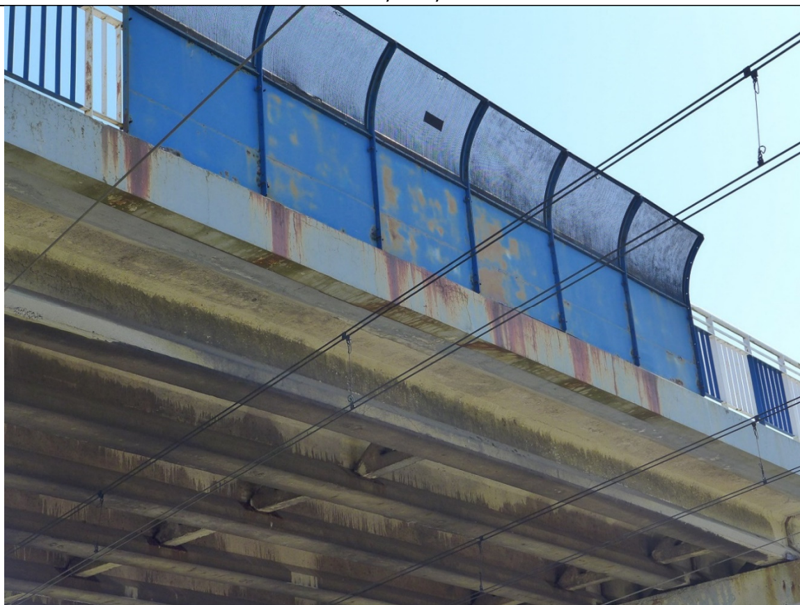
Fot. 24 Przęsło 2-3 nad torami kolejowymi – widoczne rdzawe osady na gzymsie
