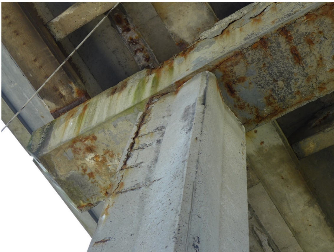
Fot. 11 Filar w osi 3 od strony torów kolejowych – widoczne ubytki i korozja betonu, zarysowania wzdłuż korodującego zbrojenia, korozja zbrojenia, osady, wykwit
