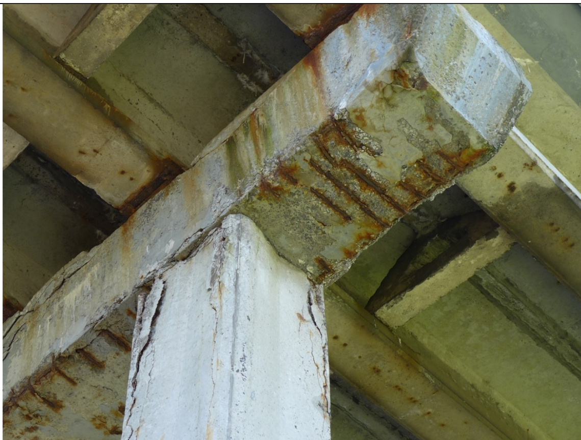
Fot. 17 Filar w osi 2 – widoczna rozległa korozja, spękania i odspojenia betonu, korozja odsłoniętego zbrojenia, osady i wykwity
