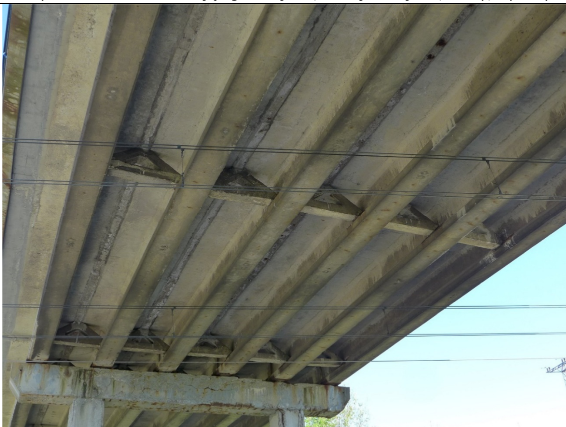
Fot. 12 Przęsło 2-3 nad torami kolejowymi – widoczne osady przy zamkach monolitycznych
