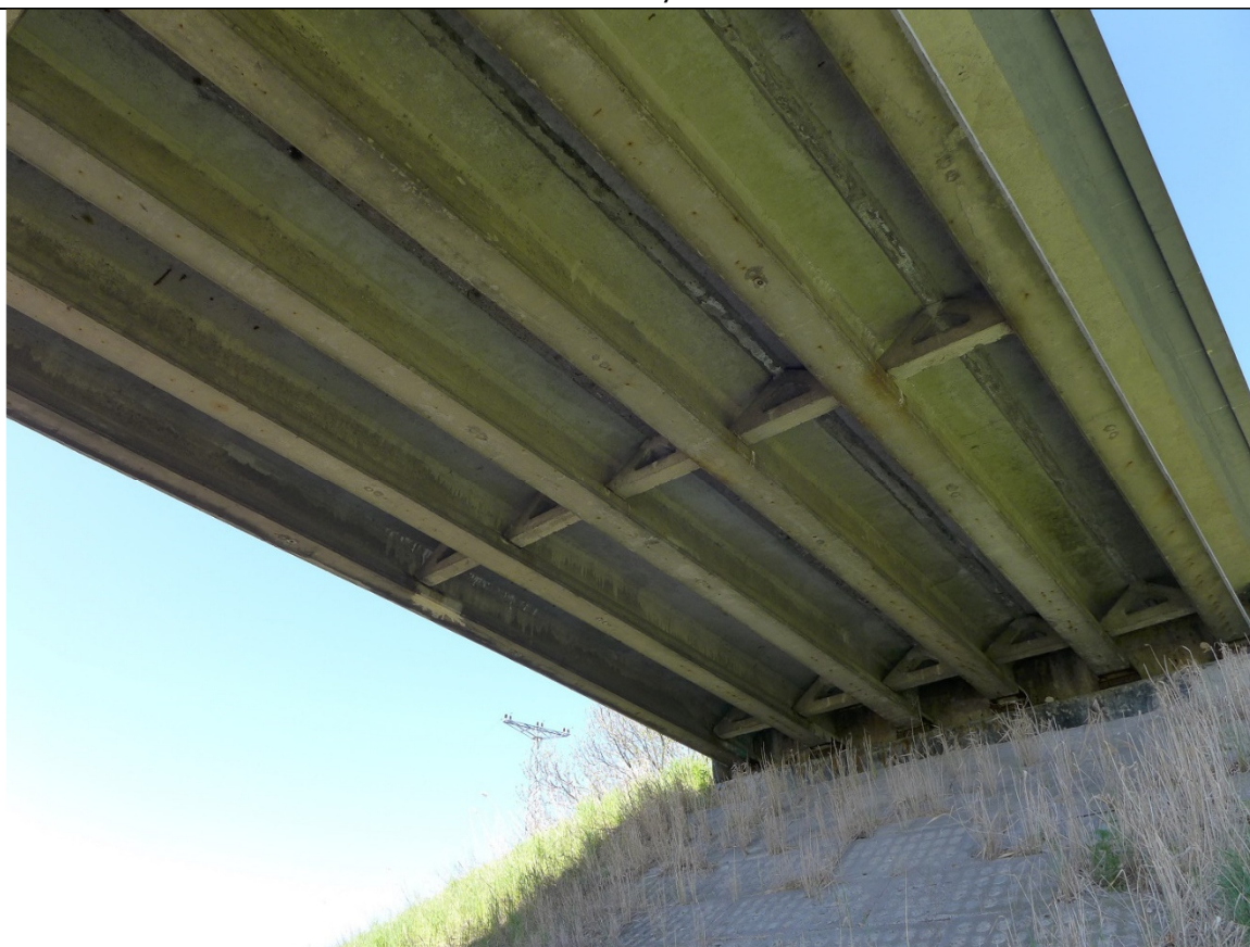
Fot. 22 Przęsło 1-2 – widoczne osady między zamkami
