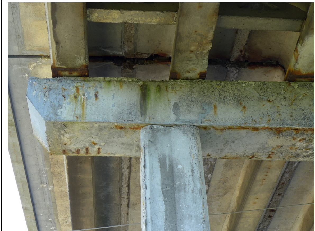
Fot. 4 Filar w osi 3 – zarysowania, ubytki betonu, osady, wykwyty, korozja zbrojenia
