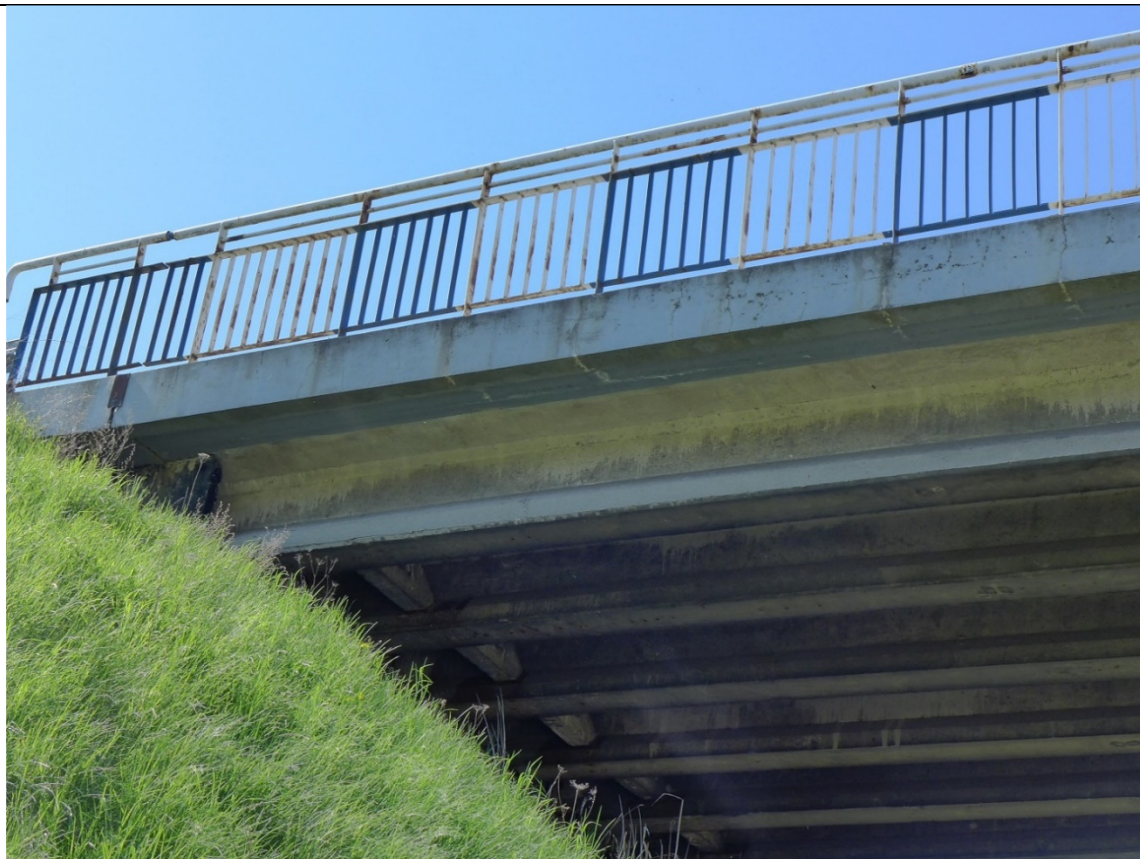
Fot. 9 Gzyms przęsła 3-4 od strony północnej – widoczne regularne zarysowania pionowe, osady, wykwit
