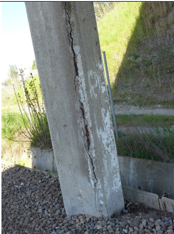
Fot. 16 Słup filara w osi 2 – widoczne podłużne pęknięcie wzdłuż korodującego zbrojenia
