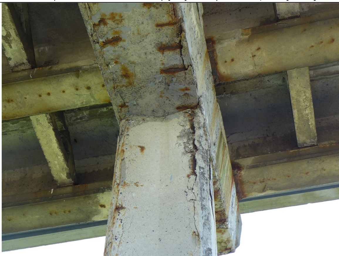
Fot. 20 Filar w osi 2 – widoczne zarysowania wzdłuż korodującego zbrojenia, korozja zbrojenia, odspojenia betonu, osady, wykwyty
