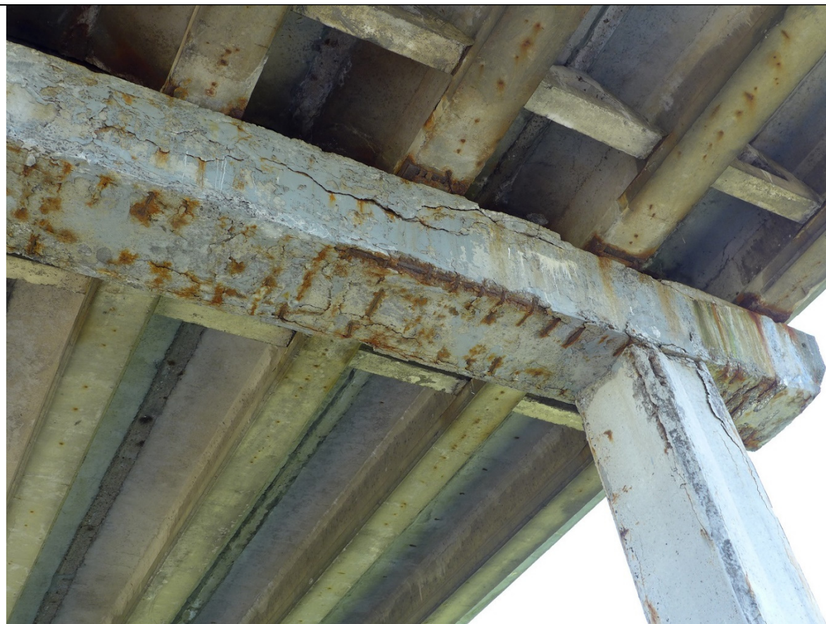
Fot. 15 Filar w osi 2 – widoczna korozja i spękania betonu, korozja zbrojenia, osady i wykwyty
