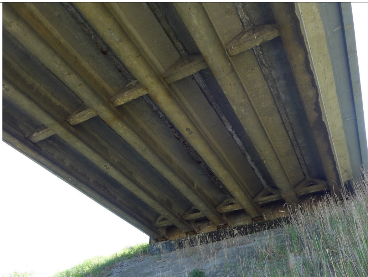
Fot. 7 Przęsło 3-4 – widoczne osady w miejscach zamków monolitycznych
