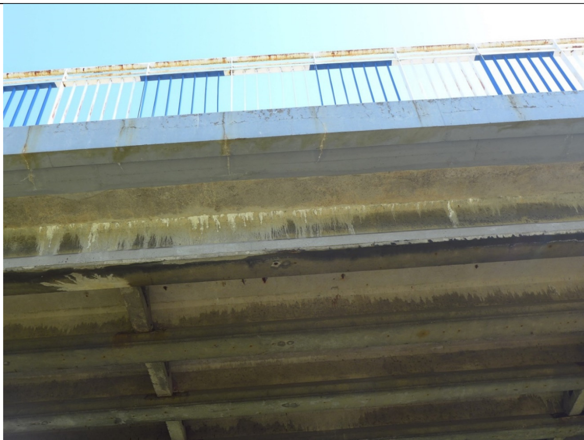
Fot. 23 Przęsło 1-2 – widoczne regularne zarysowania pionowe gzymsu, osady i wykwyty
