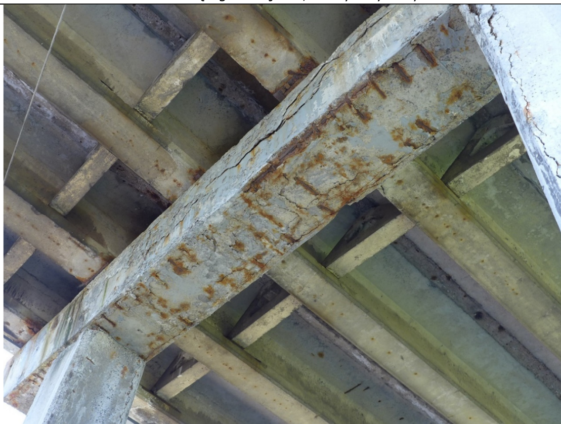
Fot. 18 Filar w osi 2 – widoczna rozległa korozja, spękania i odspojenia betonu, korozja odsłoniętego zbrojenia, osady i wykwity
