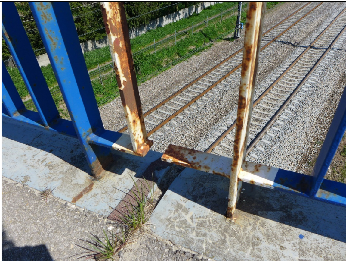
Fot. 27 Balustrada w miejscu szczeliny dylatacyjnej – brak ciągłości
