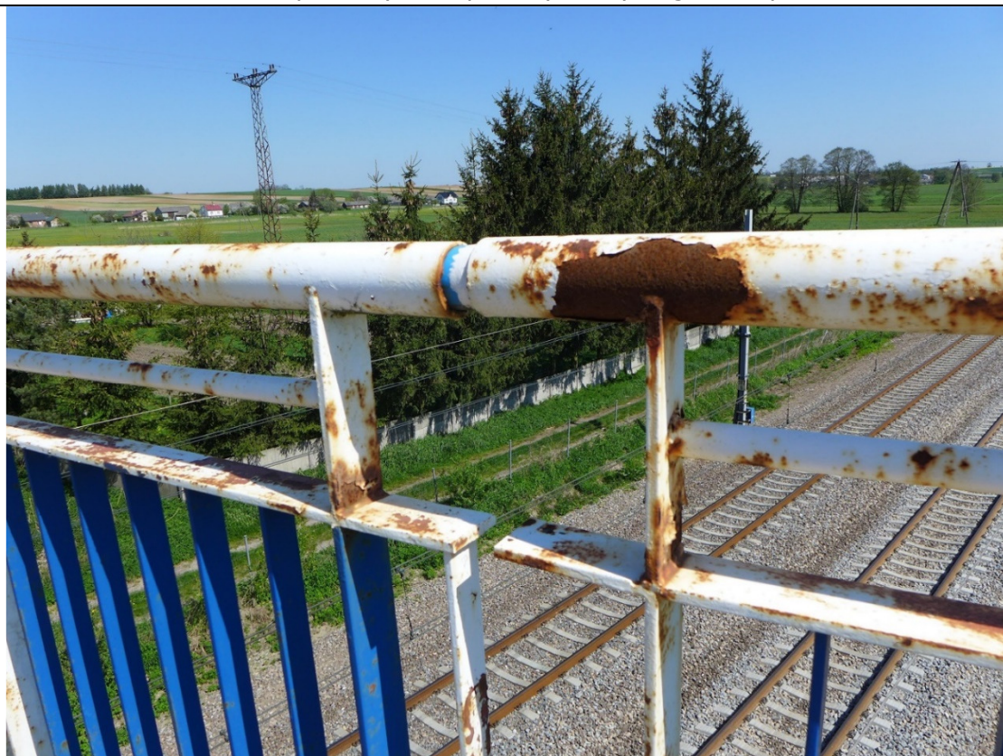
Fot. 26 Balustrada w miejscu szczeliny dylatacyjnej nad podporą – brak ciągłości w elemencie poziomym, w pochwyce prawidłowo.
