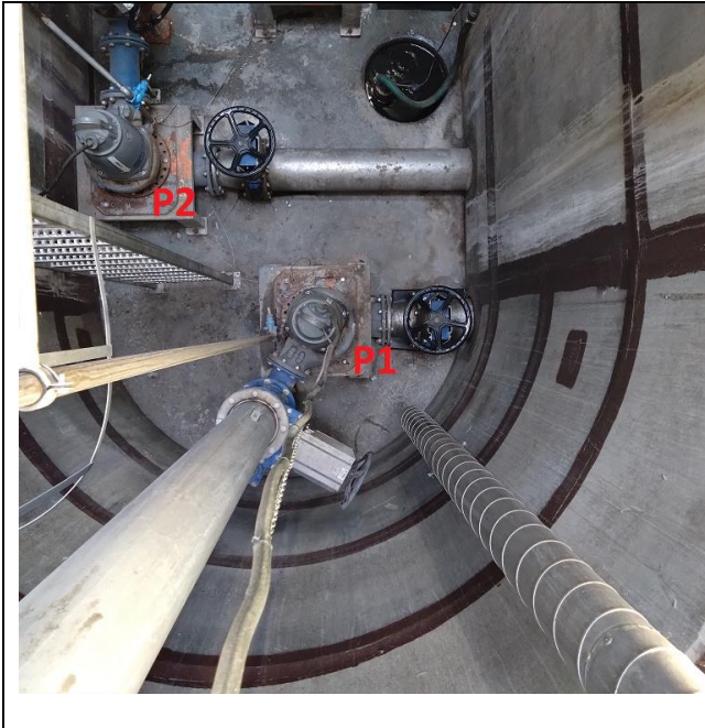
Fot-2. Fragment wnętrza pompowni (widok z poziomu pomostu serwisowego)
