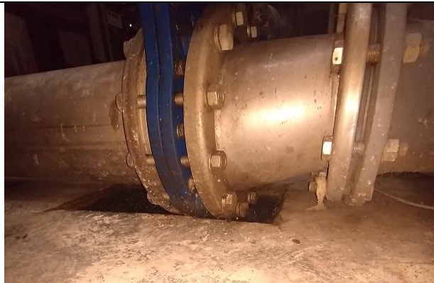
Fot-5. Fragment rurociągu ssawnego DN250mm, zasuwa nożowa DN250mm, zwężka niesymetryczna DN250/200mm oraz kołnierz kolana ssawnego pompy na stanowisku nr 2.
