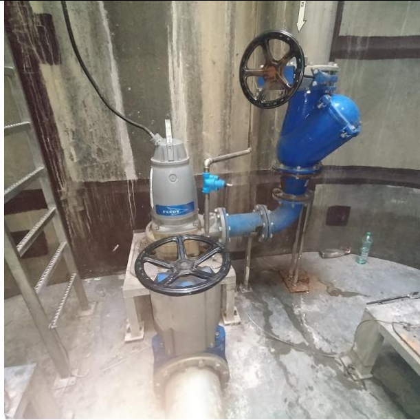
Fot-4. Pompa na stanowisku nr 2 – c.d.
