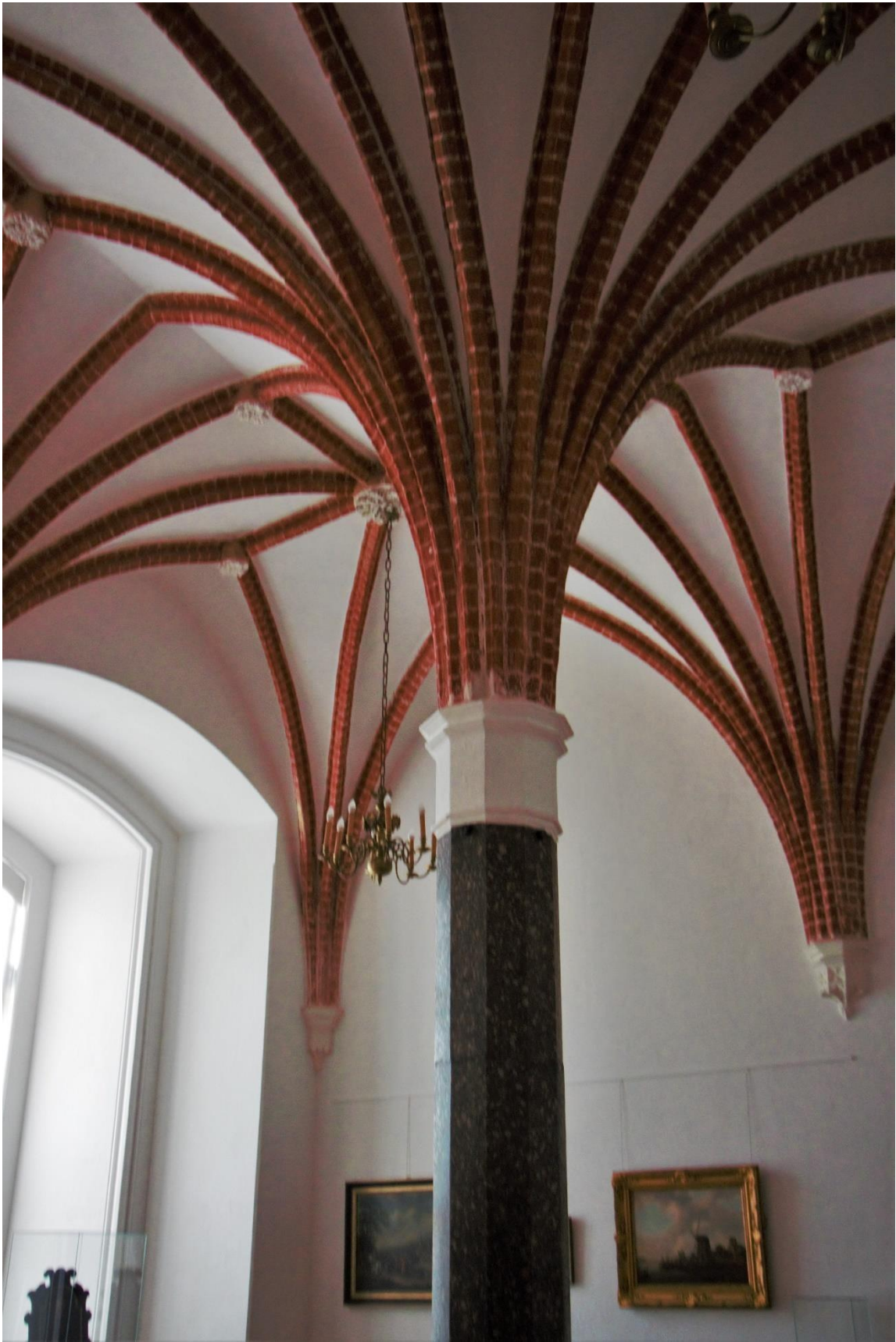
Ilustracja 29 Sala ekspozycyjna z licznymi przemalowaniami w obrębie ścian.
