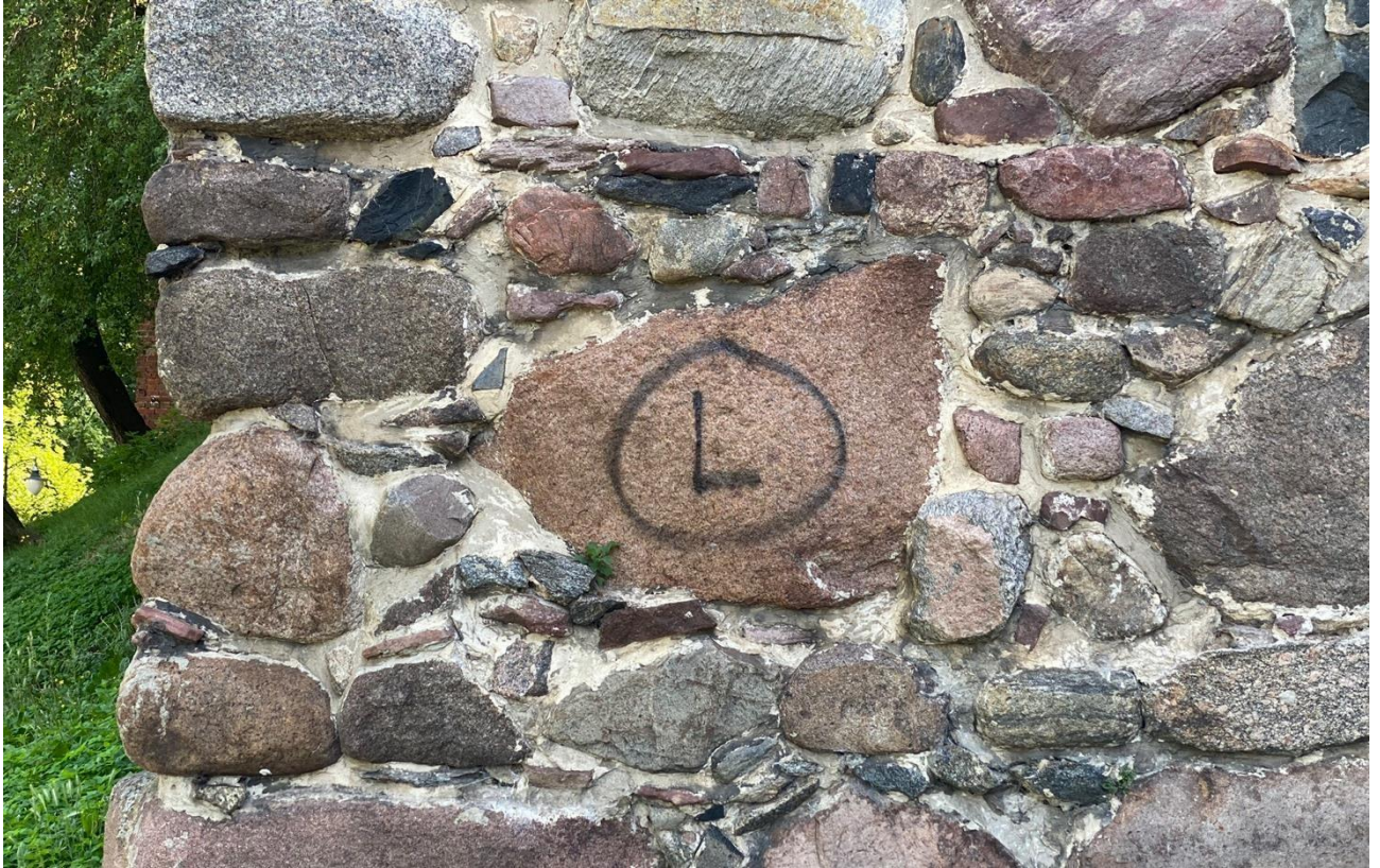
Ilustracja 12 Narożnik zachodnio-południowy, widoczne ślady aktu wandalizmu.
