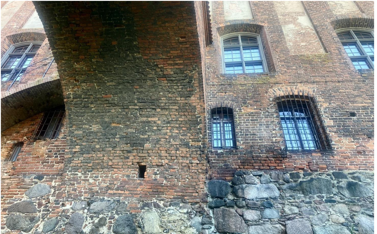
Ilustracja 10 Elewacja zachodnia, łęk od łącznika z gdaniskiem z widocznymi nawarstwieniami w postaci patyny fałszywej.
