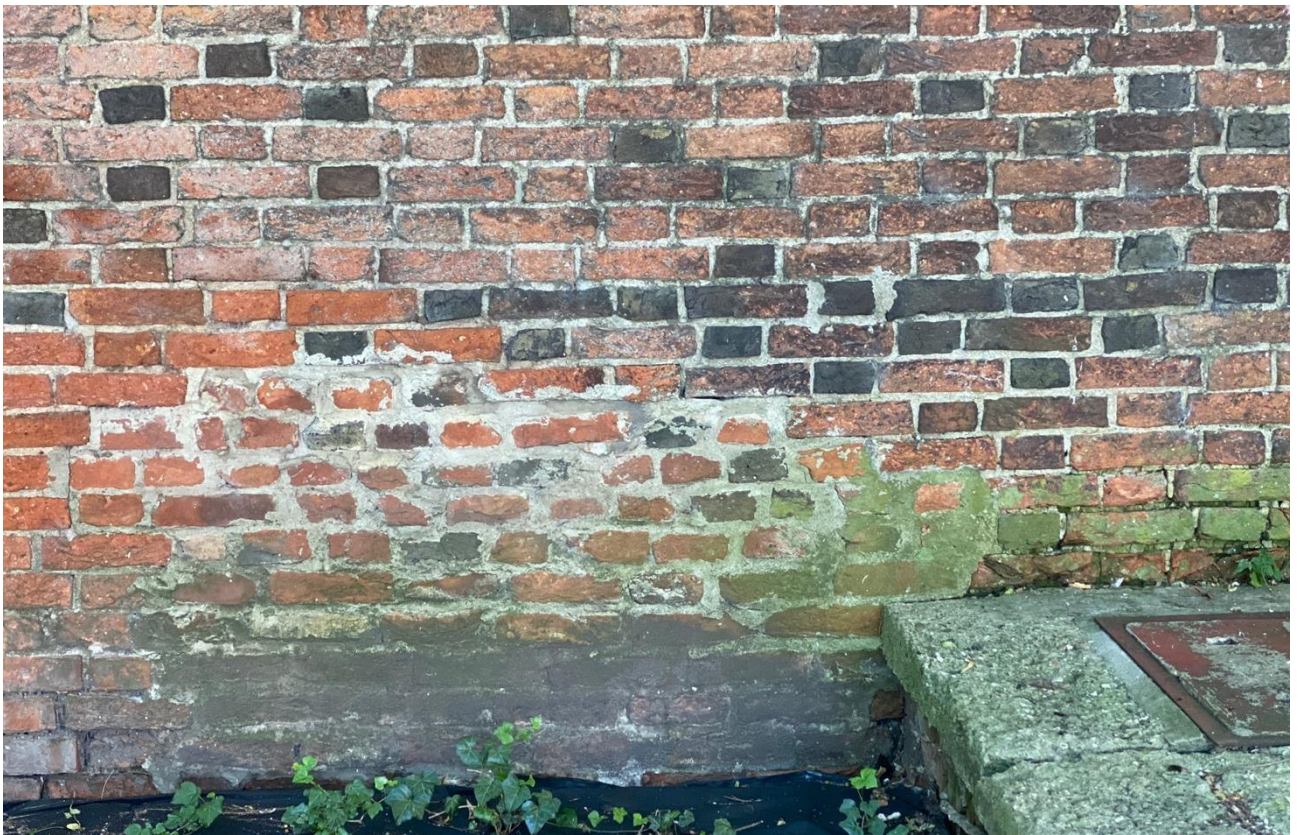
Ilustracja 11 Elewacja zachodnia, widoczne naprawy zaprawami cementowymi.
