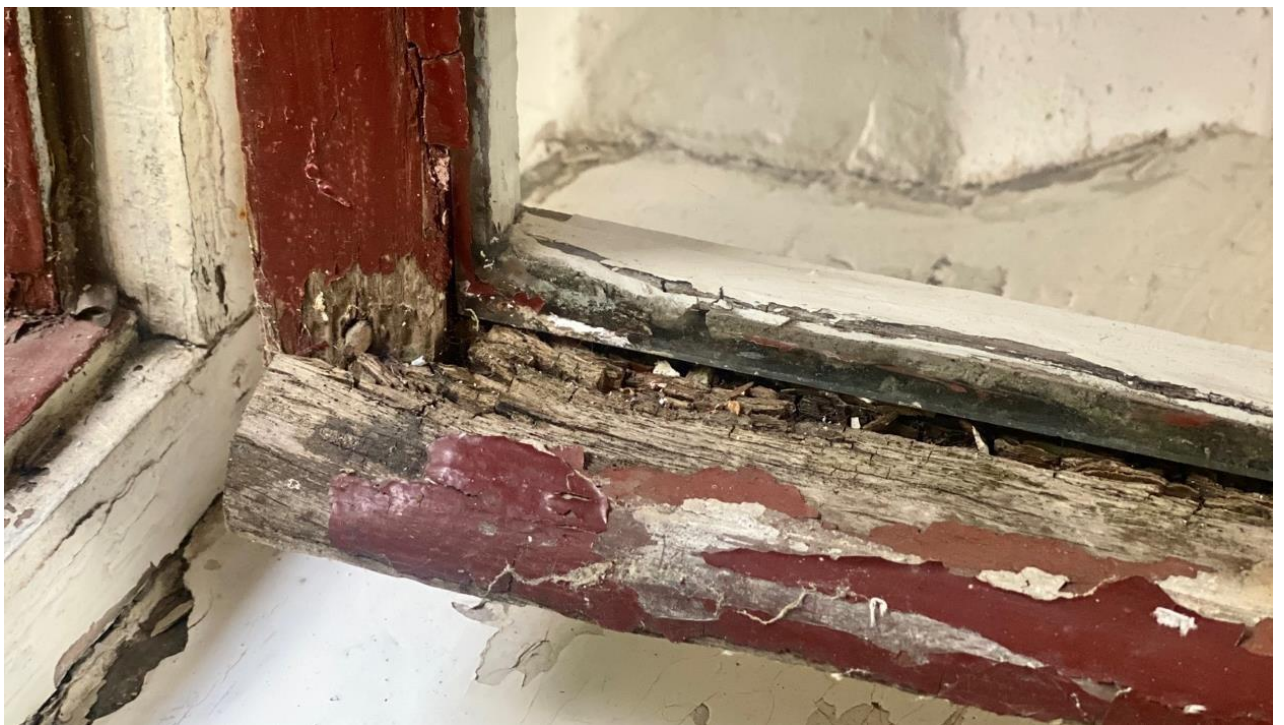
Ilustracja 27 Całkowita destrukcja konstrukcji drewnianej okien zlokalizowanych w korytarzu prowadzącym do wieży studziennej.
