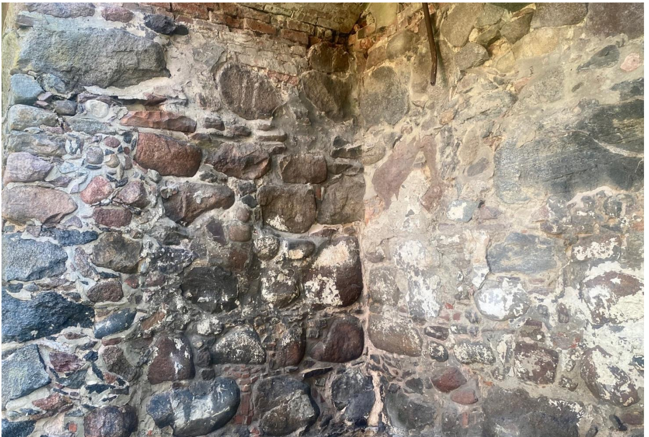
Ilustracja 19 Poważne zawilgocenia muru kamiennego.
