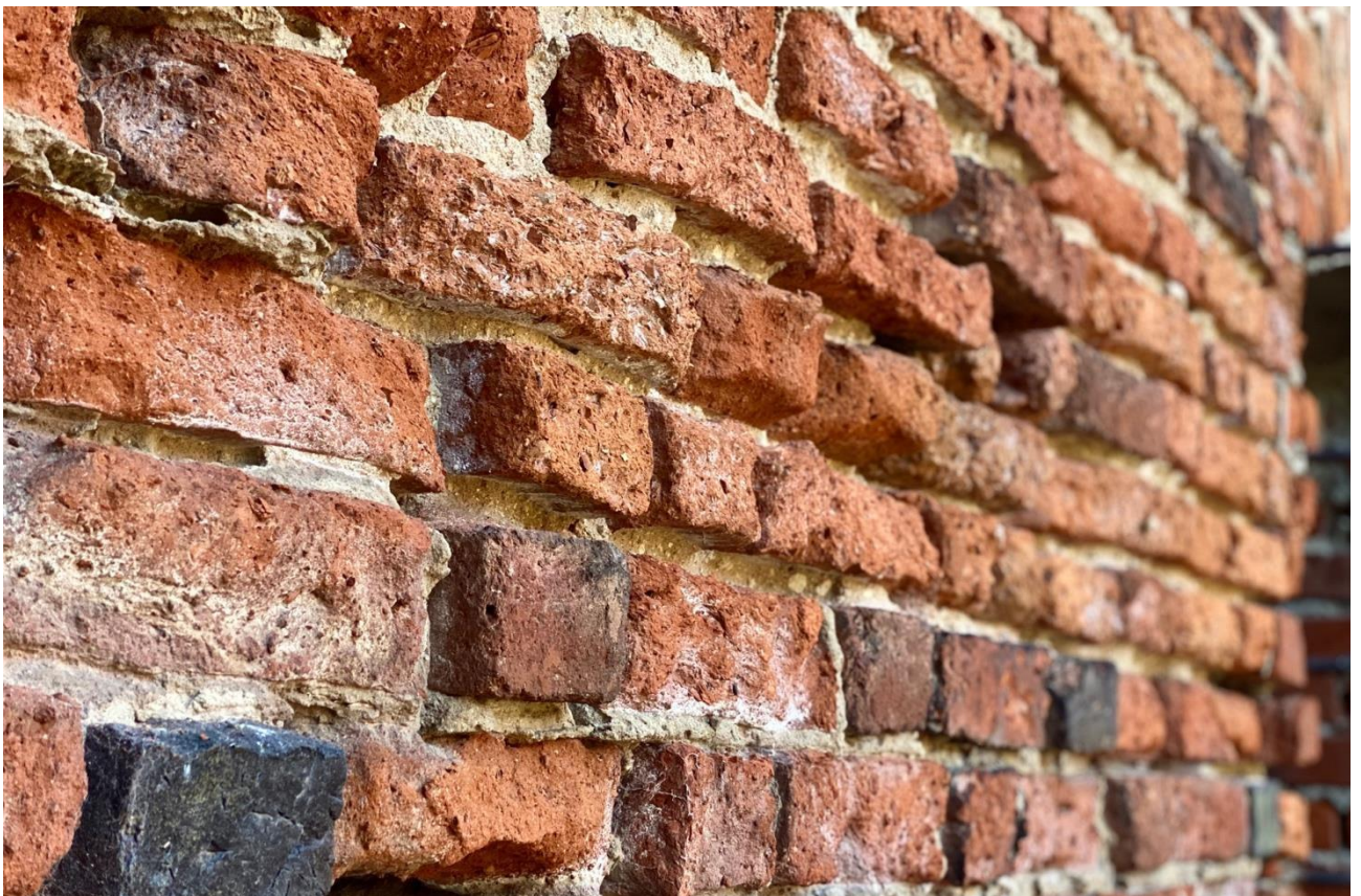
Ilustracja 15 Elewacja zachodnia, całkowita degradacja zaprawy spoinowej.
