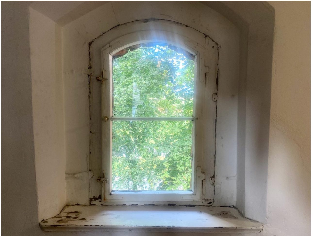
Ilustracja 26 Zły stan zachowania okien w korytarzu prowadzącym do wieży studziennej.
