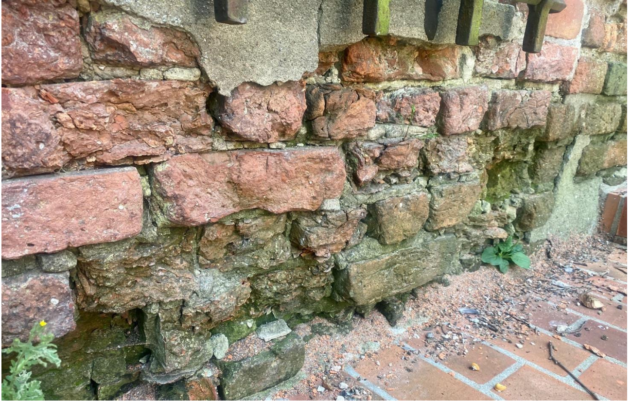
Ilustracja 18 Podwyższona wilgotność w obrębie elewacji północno-zachodniej doprowadziła do uszkodzeń materiału ceramicznego i zapraw oraz rozwoju mikroorganizmów.
