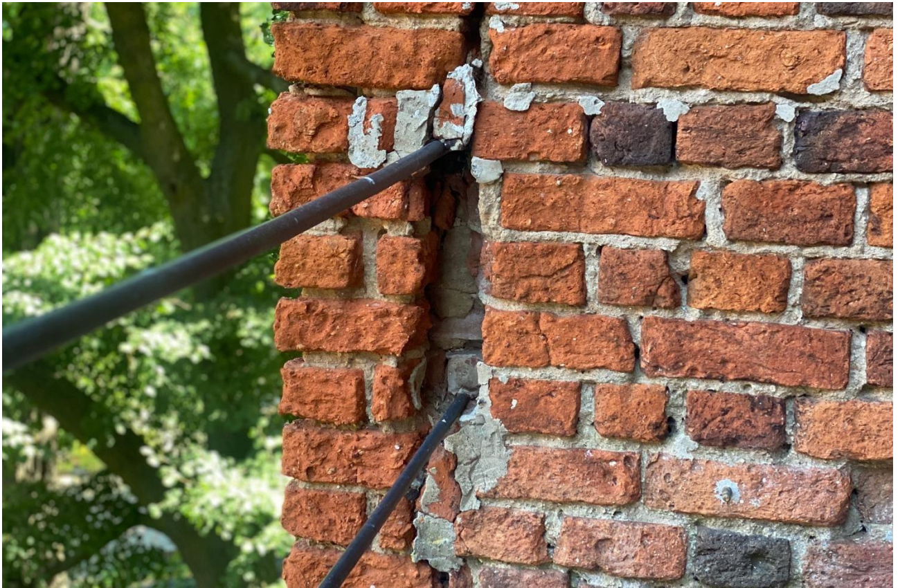
Ilustracja 14 Korozja elementów metalowych doprowadziła do zniszczeń lica ceglanego oraz zapraw.
