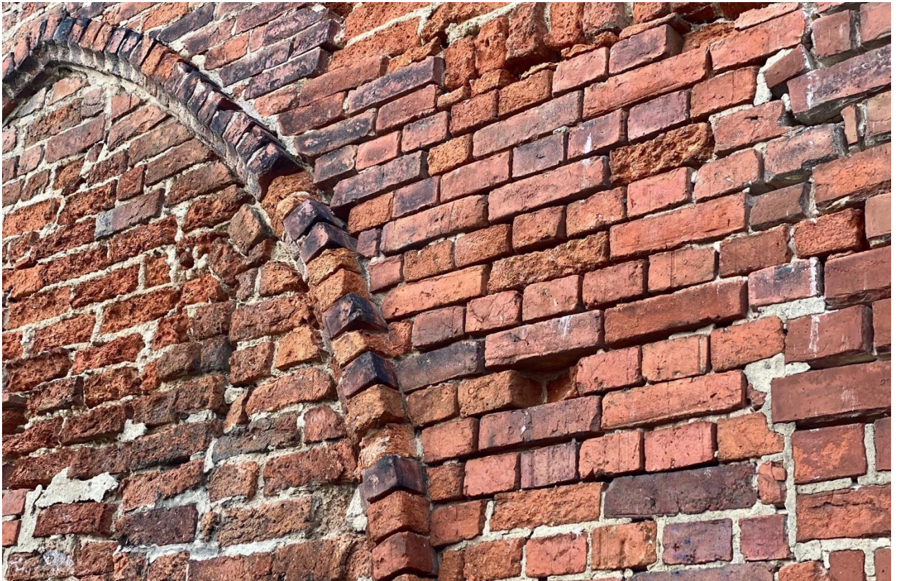
Ilustracja 22 Ubytki zaprawy spoinowej w obrębie elewacji dziedzińca.
