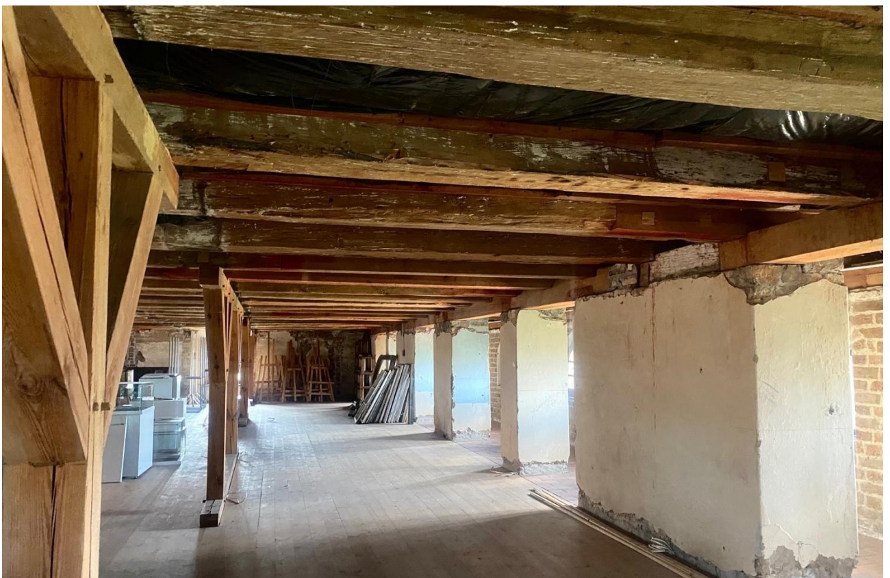
Ilustracja 25 Stan zachowania poddasza wyraźnie wskazuje na przeprowadzanie w jego obrębie licznych remontów.
