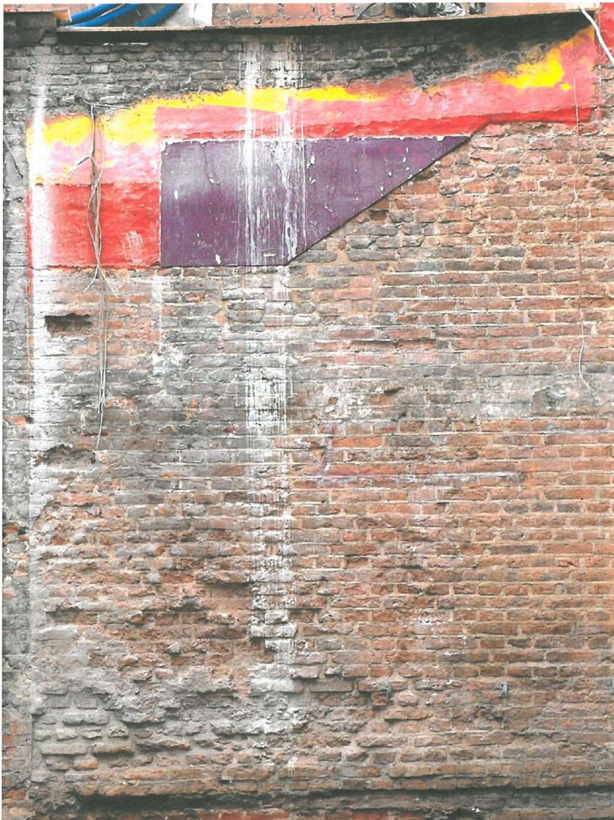
Fot.nr 17 Gdańsk, Stara Apteka – fragment muru kurtynowego pomiędzy elewacją południową a bramą. Widoczne zniszczenia muru. Stan obiektu przed konserwacją, luty 2015r., fot. E. Przebirowska
