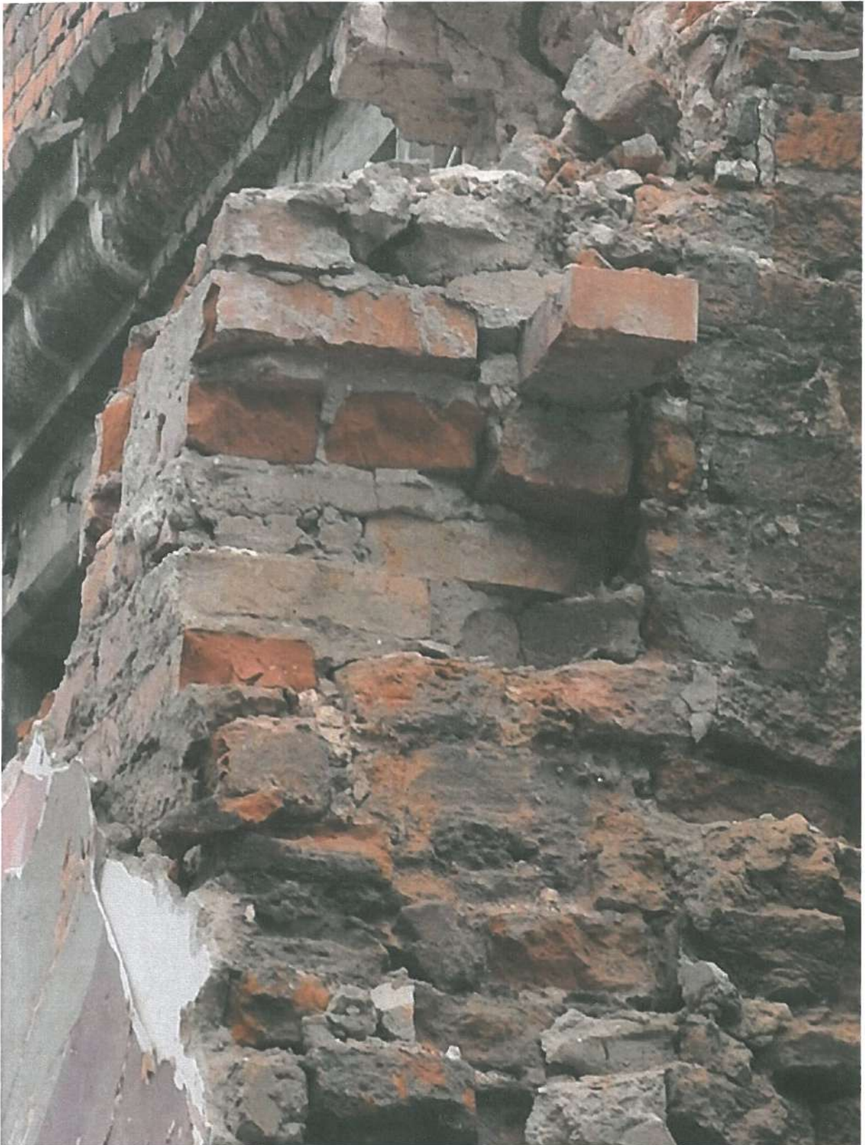
Fot.nr 15 Gdańsk, Stara Apteka – fragment muru obwodowego przy elewacji wschodniej od strony wschodniej. Widoczny fragment zamurowania otworu – być może blanki. Stan obiektu przed konserwacją, luty 2015r., fot. E. Przebirowska
