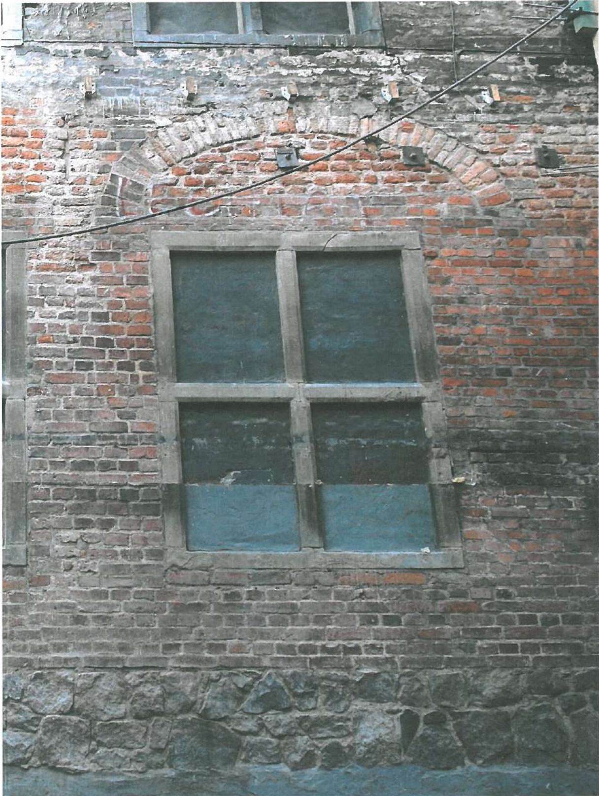
Fot.nr 11 Gdańsk, Stara Apteka- fragment elewacji południowej Okno parteru wraz z łukiem odciążającym. Widoczne nowe obmurowanie okna. Stan przed konserwacją, luty 2015r. , fot. E. Przebirowska
