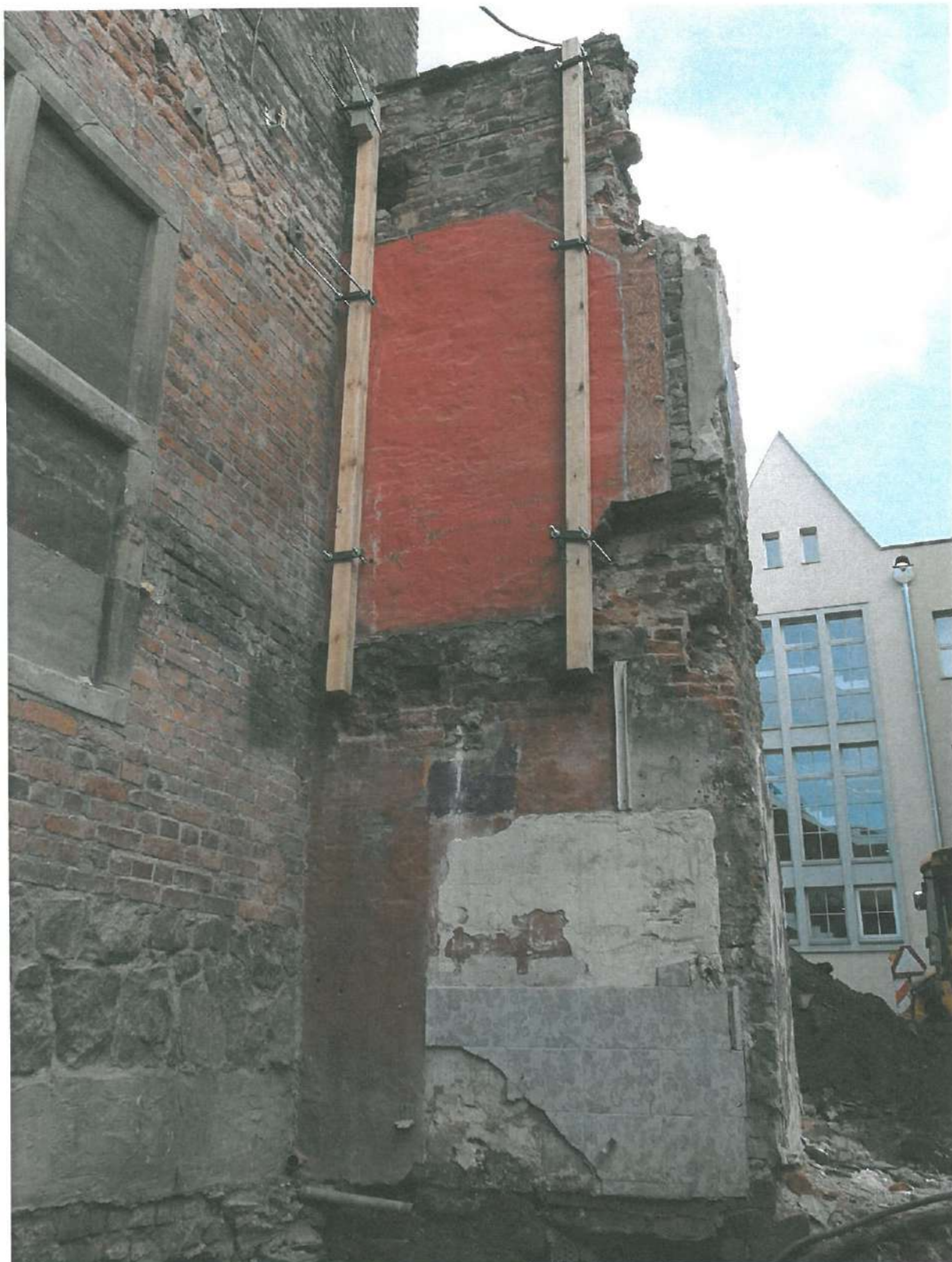
Fot.nr 13 Gdańsk, Stara Apteka – fragment muru obwodowego przy elewacji wschodniej od strony zachodniej, stan obiektu przed konserwacją, luty 2015r., fot. E. Przebirowska
