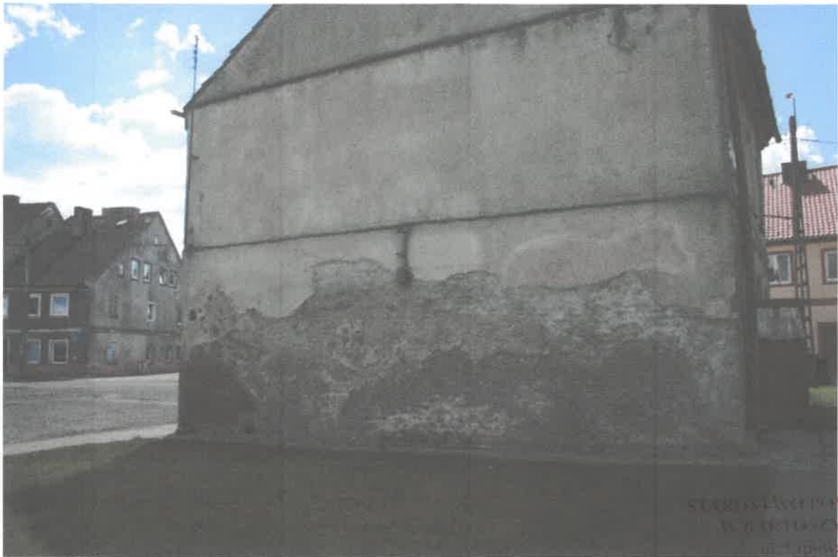
Fot. 7 Skutki działania wilgoci
