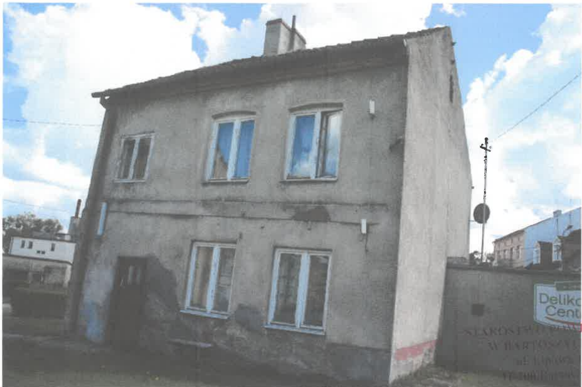
Fot. 5 Widok elewacji tylnej, silne zawilgocenie w strefie przyziemia
