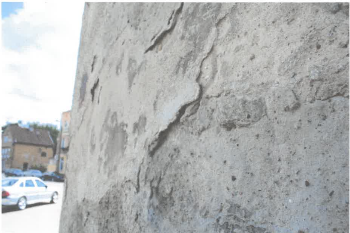
Fot. 6 Widoczne liczne odparzenia, osłabienie struktury wypraw tynkarskich
