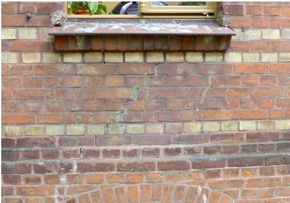
Fot. 17. Olsztyn, budynek przy ul. Prawocheńskiego 2, elewacja szczytowa wschodnia. Widoczne spękanie strukturalne muru biegnące od okna parteru do nadproża okienka piwnicznego.
