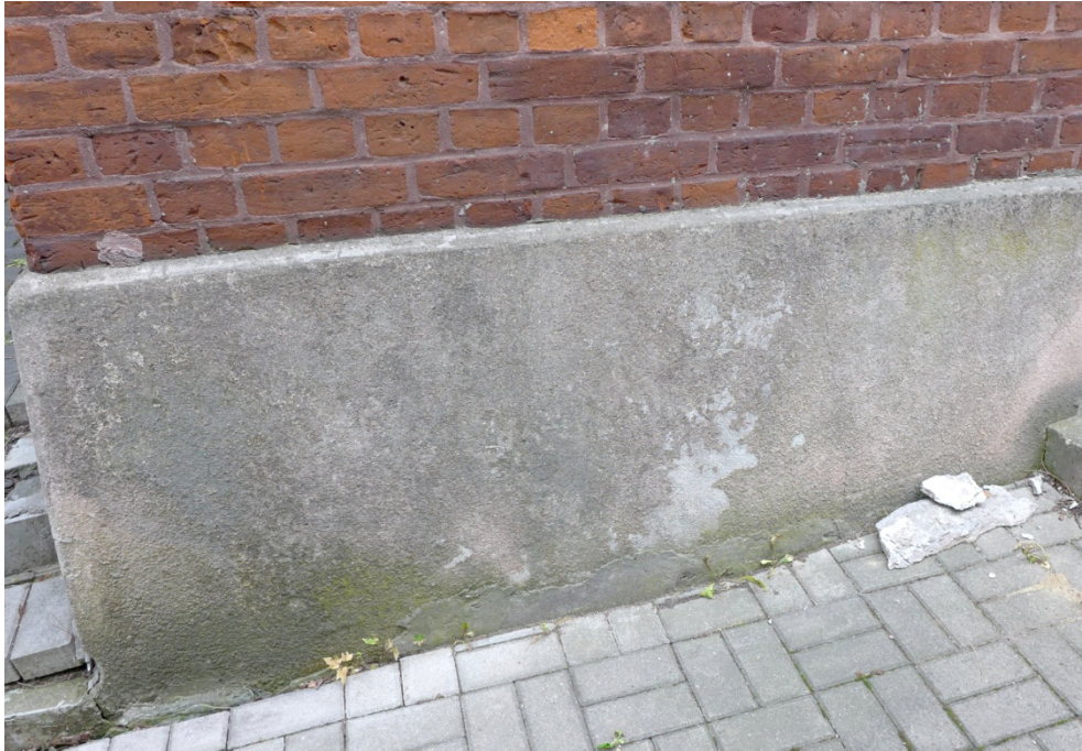
Fot. 23. Olsztyn, budynek przy ul. Prawocheńskiego 2, elewacja szczytowa – zachodnia. Widoczne wtórne wybetonowanie cokołu. Zaprawa betonowa utrzymuje wilgoć i nie pozwala na swobodne odparowywanie.
