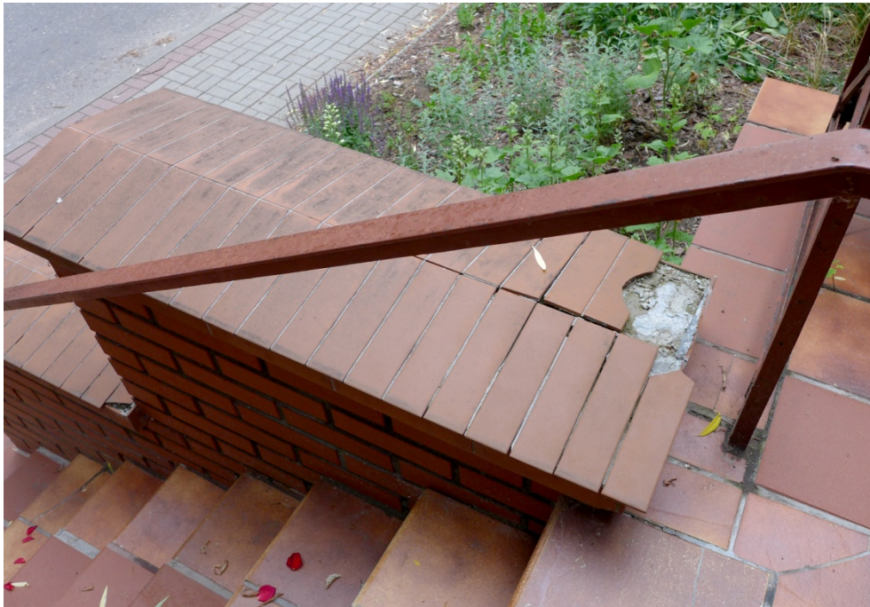
Fot. 3. Olsztyn, budynek przy ul. Prawocheńskiego 2, elewacja frontowa. Fotografia pokazuje uszkodzone nakrycie muru. Nakrycie wykonane z płytki klinkierowej nie posiadającej walorów zabytkowych.
