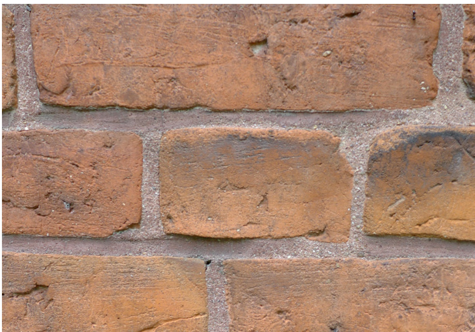
Fot. 20. Olsztyn, budynek przy ul. Prawocheńskiego 2, elewacja szczytowa wschodnia. Widoczna dobrze zachowana pierwotna czerwona spoina, opracowana na płasko wykończona gładko.
