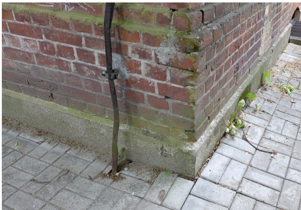
Fot. 14. Olsztyn, budynek przy ul. Prawocheńskiego 2, elewacja tylna – południowa. Zbliżenie pokazuje wykwyty mikroorganizmów na ceglanym cokole oraz wtórnej betonowej obrzutce.
