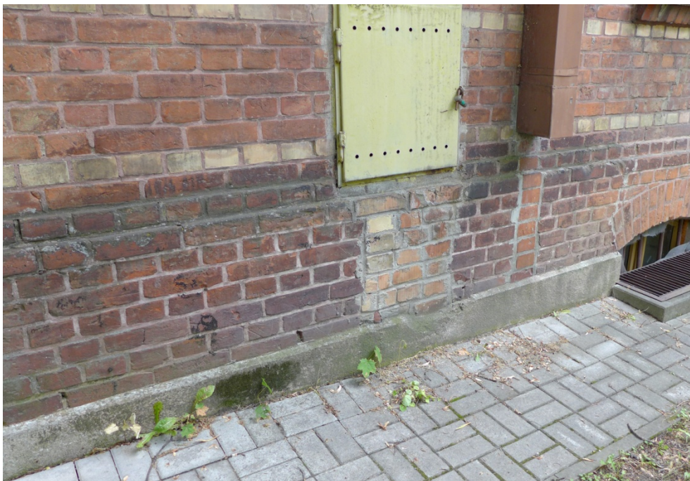
Fot. 16. Olsztyn, budynek przy ul. Prawocheńskiego 2, elewacja szczytowa wschodnia. Zbliżenie na cokół pokazuje silnie spatynowane lico ceglane, przemurowanie pod skrzynką oraz porażenie mikroorganizmami w strefie nad kostką brukową.
