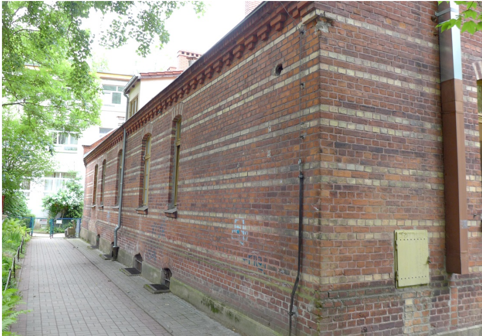
Fot. 9. Olsztyn, budynek przy ul. Prawocheńskiego 2, elewacja tylna – południowa. Widok ogólny. Pośrodku połaci dachowej widoczna nieestetyczna lukarna, która nie wpisuje się w zabytkowy charakter obiektu.
