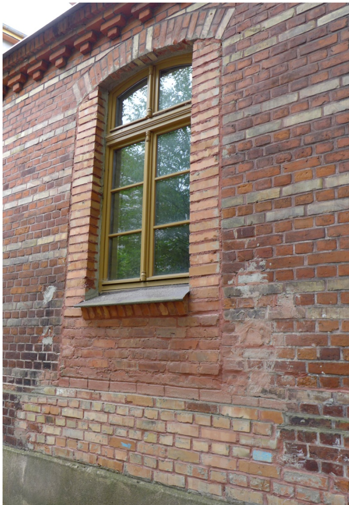
Fot. 11. Olsztyn, budynek przy ul. Prawocheńskiego 2, elewacja tylna – południowa. Widoczne nieestetyczne zamurowanie otworu drzwiowego, który został przekształcony w otwór okienny. Cegła nie nawiązuje pod względem koloru i struktury lica do oryginału, spoina także odbiega znacznie kolorem i opracowaniem.
