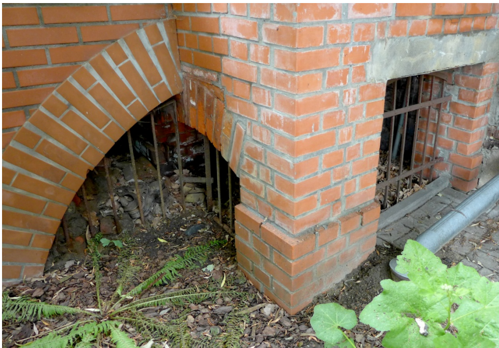
Fot. 4. Olsztyn, budynek przy ul. Prawocheńskiego 2, elewacja frontowa. Fotografia pokazuje podmurówkę podestu i schodów wykonane z cegły klinkierowej, cegła zabrudzona i zasolona. Widoczne także z prawej strony nieestetyczne nadproże.
