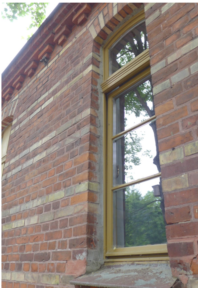
Fot. 13. Olsztyn, budynek przy ul. Prawocheńskiego 2, elewacja tylna – południowa. Fotografia pokazuje nieestetyczne wykończenie obróbki wokół okien. Zasmarowano klejem część ceglanego wążku. Blaszane parapet y pokryto farbą, która obecnie łuszczy się i odpada.
