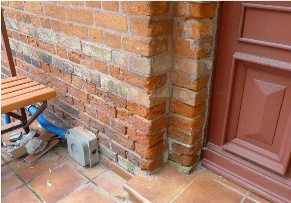
Fot. 5. Olsztyn, budynek przy ul. Prawocheńskiego 2, elewacja frontowa. Fotografia pokazuje destruowane ceglane lico oraz wyptukane spoiny przy wejściu głównym do budynku.
