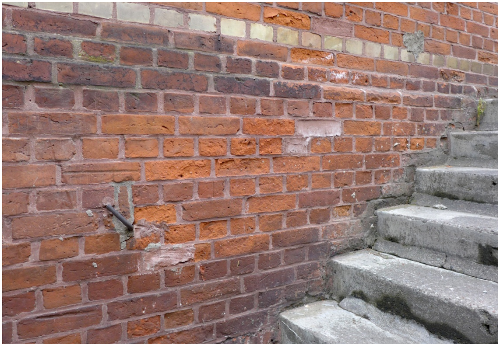
Fot. 24. Olsztyn, budynek przy ul. Prawocheńskiego 2, elewacja szczytowa – zachodnia. Widoczne uszkodzone lico ceglane w obrębie strefy przyziemia. Uszkodzenia wynikają prawdopodobnie z zasolenia i podciągania kapilarnego wody opadowej. Lico ceglane jest destruowane i osłabione.
