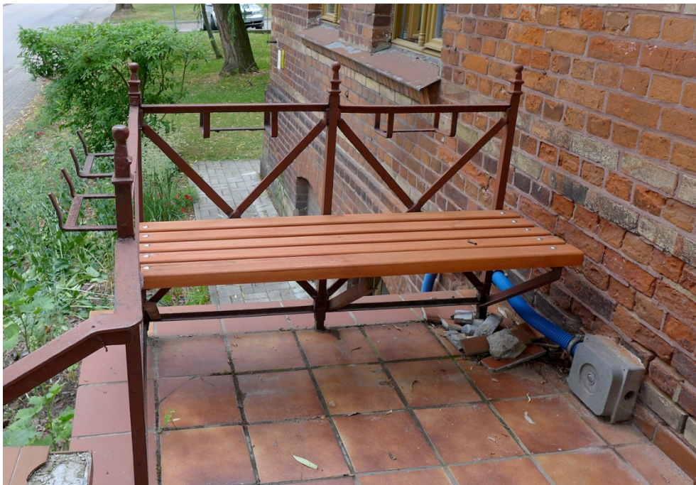
Fot. 2. Olsztyn, budynek przy ul. Prawocheńskiego 2, elewacja frontowa. Fotografia pokazuje pierwotną metalową balustradę oraz kafle podestu, które nie pasują do charakteru obiektu.
