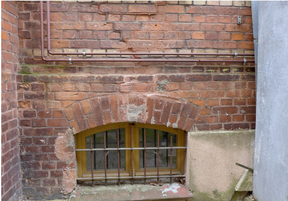
Fot. 27. Olsztyn, budynek przy ul. Prawocheńskiego 2, elewacja szczytowa – zachodnia. Fotografia pokazuje spekanie nad oknem piwnicznym wraz z przesunięciem muru. W wyniku spękania mur utracił swoje lico. Po prawej widoczny wtórna metalowa, szpecąca przybudówka.
