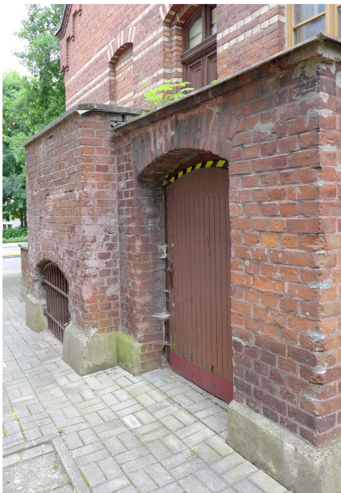
Fot. 26. Olsztyn, budynek przy ul. Prawocheńskiego 2, elewacja szczytowa – zachodnia. Zbliżenie pokazuje silnie spatynowane lico ceglane oraz wtórną stolarkę drzwiową zejścia do piwnicy.
