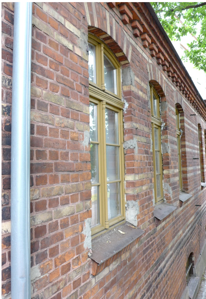
Fot. 6. Olsztyn, budynek przy ul. Prawocheńskiego 2, elewacja frontowa. Fotografia pokazuje nieestetyczne betonowe uzupełnienia w gładach okiennych powstałe zapewne po usunięciu krat.
