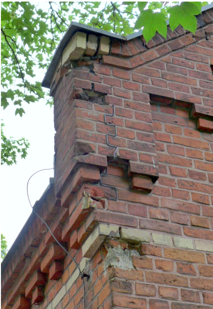
Fot. 22. Olsztyn, budynek przy ul. Prawocheńskiego 2, elewacja szczytowa wschodnia. Widoczne uszkodzenie sterczyny oraz nieestetyczne, częściowe uzupełnienie cegłą ceramiczną żółtą.
