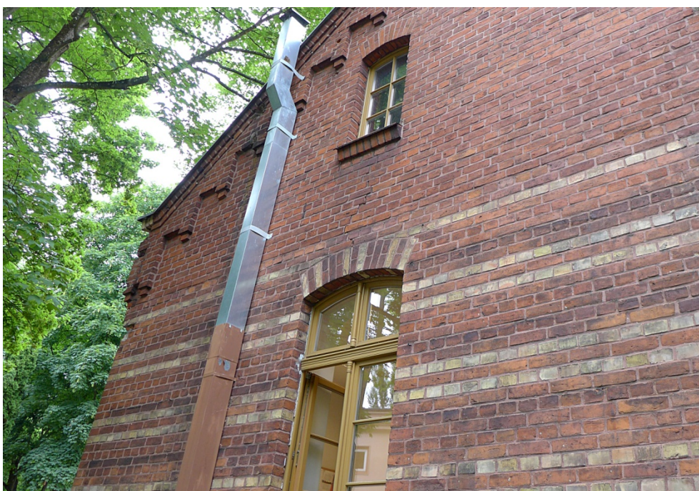
Fot. 18. Olsztyn, budynek przy ul. Prawocheńskiego 2, elewacja szczytowa wschodnia. Widoczny nieestetycznie poprowadzony komin wentylacyjny, który burzy układ i rozczłonkowanie całej elewacji.
