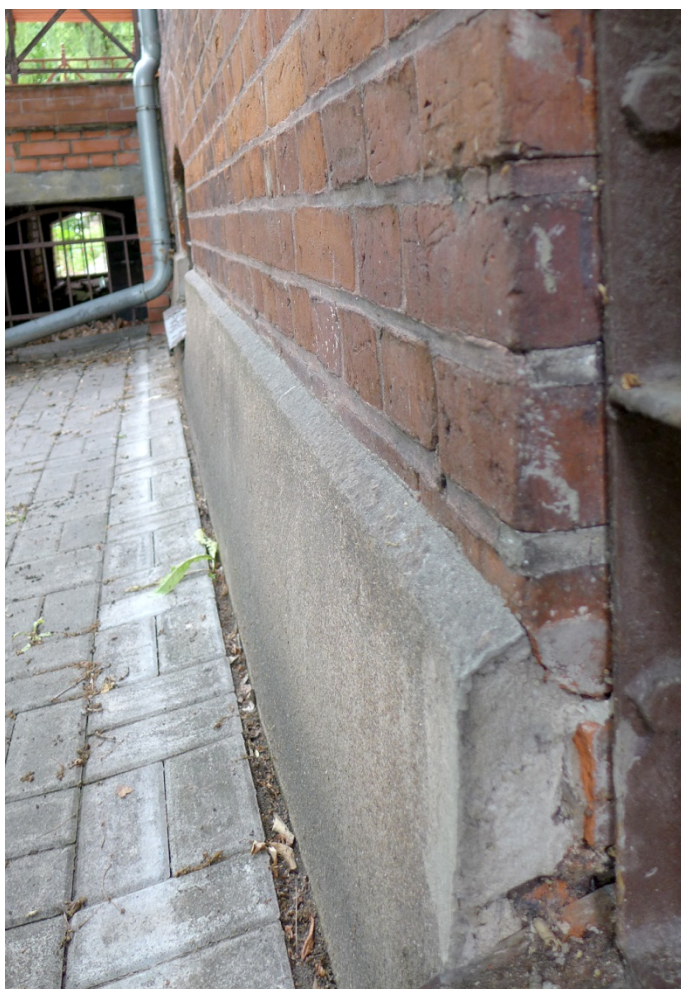
Fot. 8. Olsztyn, budynek przy ul. Prawocheńskiego 2, elewacja frontowa. Fotografia pokazuje cokół zaklejony mocną zaprawą cementową oraz wyłożenie opaski kostką brukową, która nie pasuje do zabytkowego charakteru obiektu.
