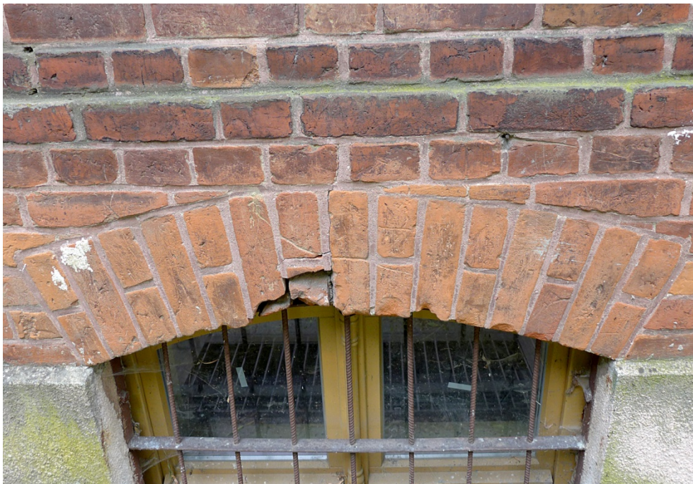
Fot. 19. Olsztyn, budynek przy ul. Prawocheńskiego 2, elewacja szczytowa wschodnia. Widoczne drobne ubytki lice ceglanego w naprożu okienka piwnicznego.
