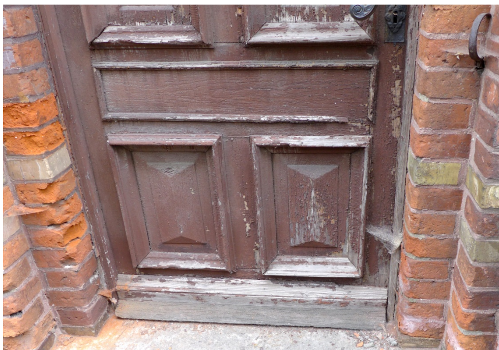
Fot. 30. Olsztyn, budynek przy ul. Prawocheńskiego 2, elewacja szczytowa – zachodnia. Zbliżenie pokazuje łuszczenie się nawarstwień malarskich oraz drobne ubytki mechaniczne ozdobnych listewek.
