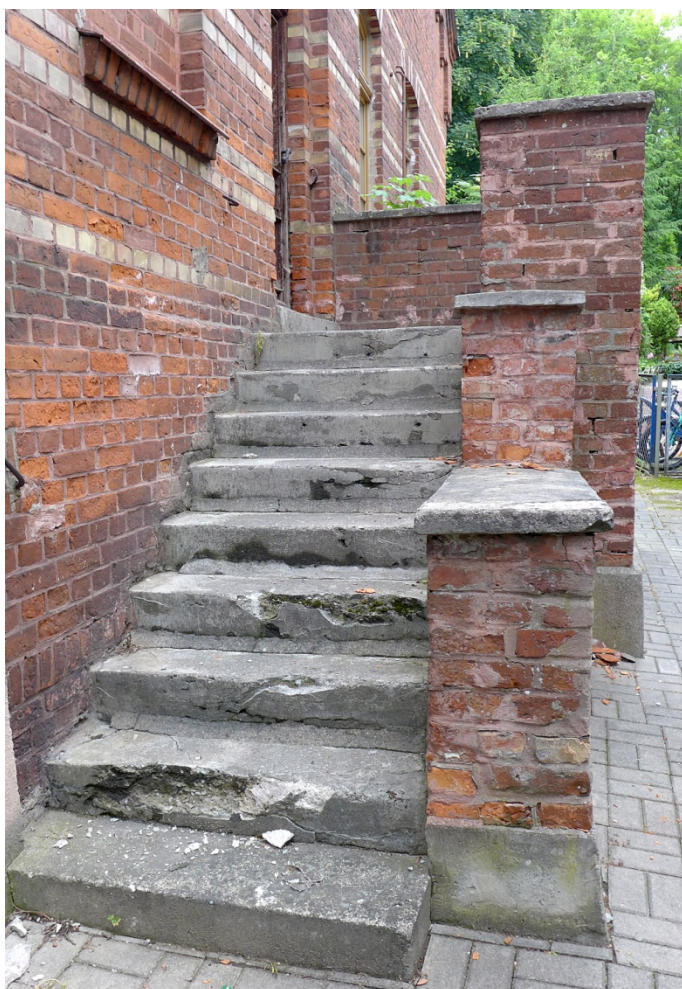
Fot. 25. Olsztyn, budynek przy ul. Prawocheńskiego 2, elewacja szczytowa – zachodnia. Widok pokazuje wtórne stopnie schodów wykonane z betonu. Schody są w bardzo złym stanie, zaprawa jest spękana i kruszy się. Cegły muru po prawej stronie w złym stanie. Późniejsze naprawy spowodowały, że wygląda on nieestetycznie.
