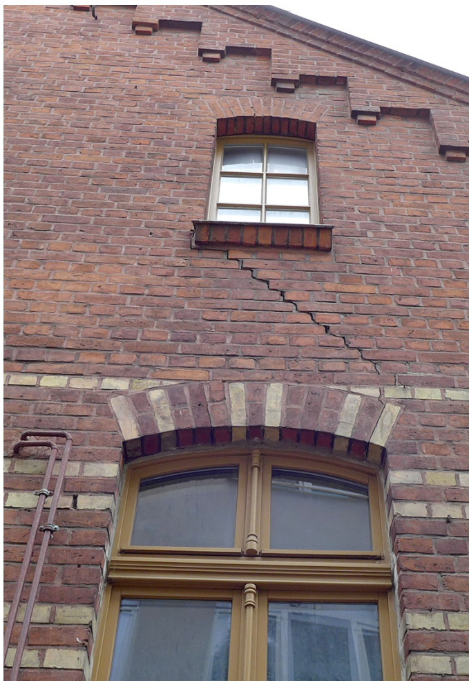
Fot. 28. Olsztyn, budynek przy ul. Prawocheńskiego 2, elewacja szczytowa – zachodnia. Widoczne rozległe spekanie strukturalne biegnące od okna w szczycie do nadproża okna strefy parteru.
