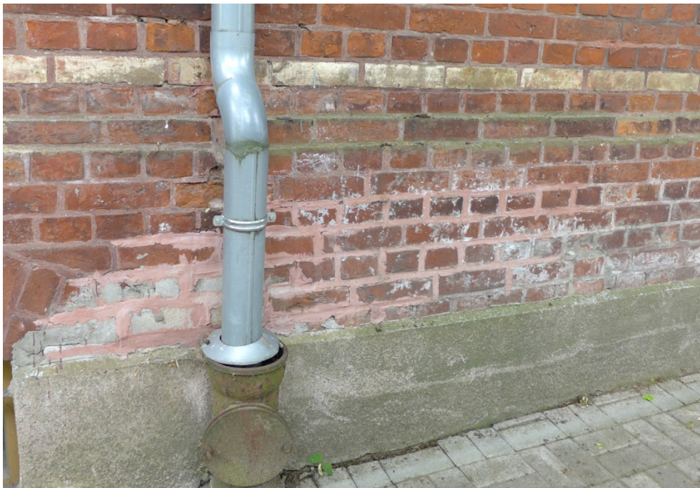
Fot. 12. Olsztyn, budynek przy ul. Prawocheńskiego 2, elewacja tylna – południowa. Widoczne nieestetyczne wtórne spoinowanie fragmentu muru. Spoina nie odpowiada sposobem opracowania ani kolorem do oryginału.
