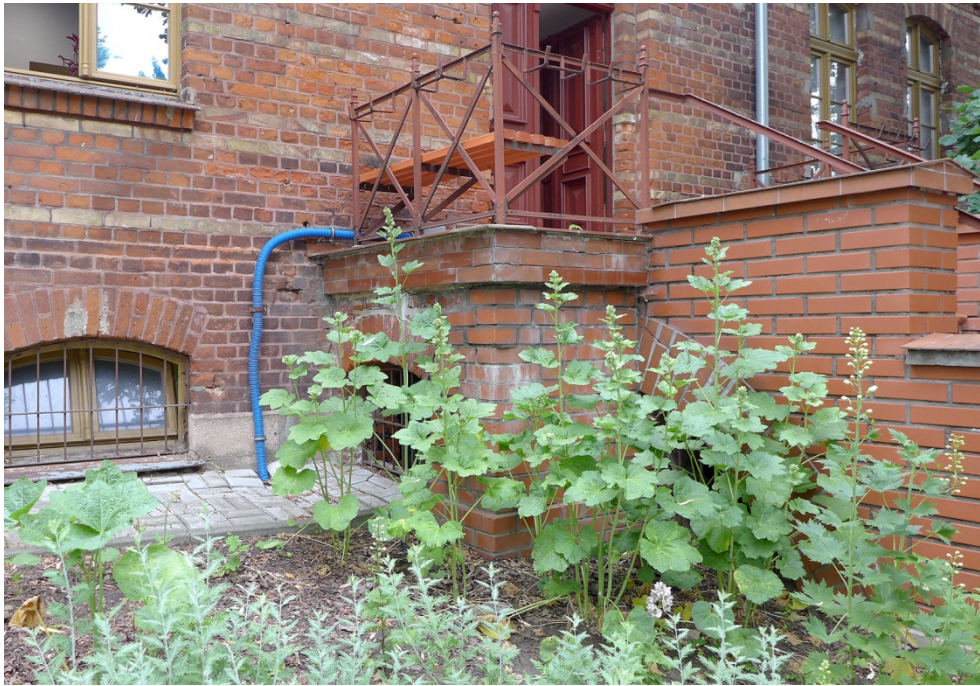
Fot. 1. Olsztyn, budynek przy ul. Prawocheńskiego 2, elewacja frontowa. Widok pokazuje podest i schody wykonane – oblicowane cegłą klinkierową. Klinkier nie jest materiałem pasującym do historycznego charakteru obiektu. Widoczna także nieestetycznie przeprowadzona instalacja w niebieskiej otulinie.
