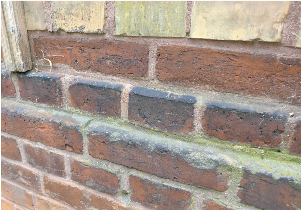
Fot. 21. Olsztyn, budynek przy ul. Prawocheńskiego 2, elewacja szczytowa wschodnia. Widoczna czarna patyna na wystających ceglach cokołu.
