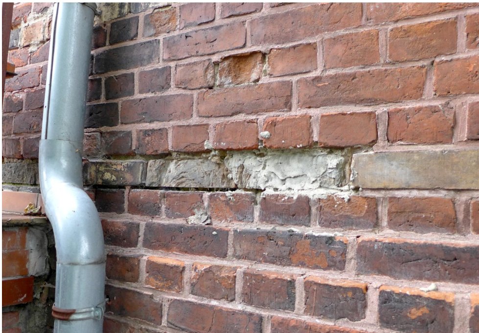
Fot. 7. Olsztyn, budynek przy ul. Prawocheńskiego 2, elewacja frontowa. Fotografia pokazuje ubytki lica ceglanego sięgające do ok. 2 cm głębokości. Widoczna także czarna patyna na zachowanych ceglanych licach.
