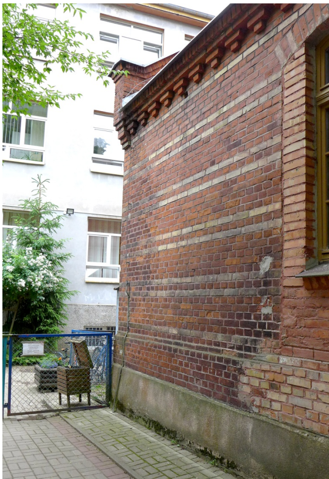
Fot. 10. Olsztyn, budynek przy ul. Prawocheńskiego 2, elewacja tylna – południowa. Fotografia pokazuje spatynowany wątek ceglany oraz omszałe partie cokołu. Wtórny betonowy cokół oraz opaska z kostki brukowej.
