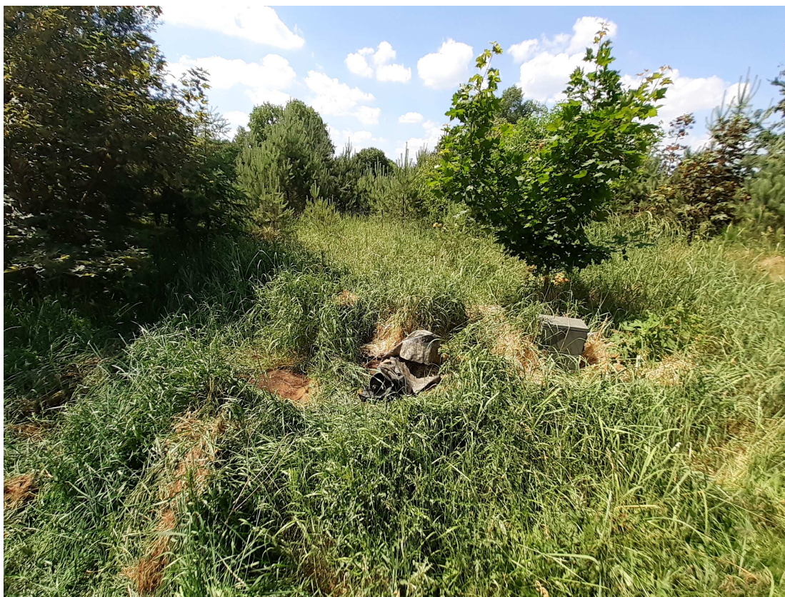
Ogólny widok oczyszczalni widoczna skrzynka rozdzielcza
