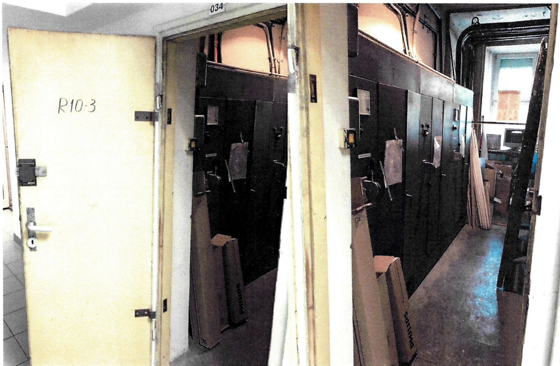
Widok pomieszczenia rozdzielnic R10-3
