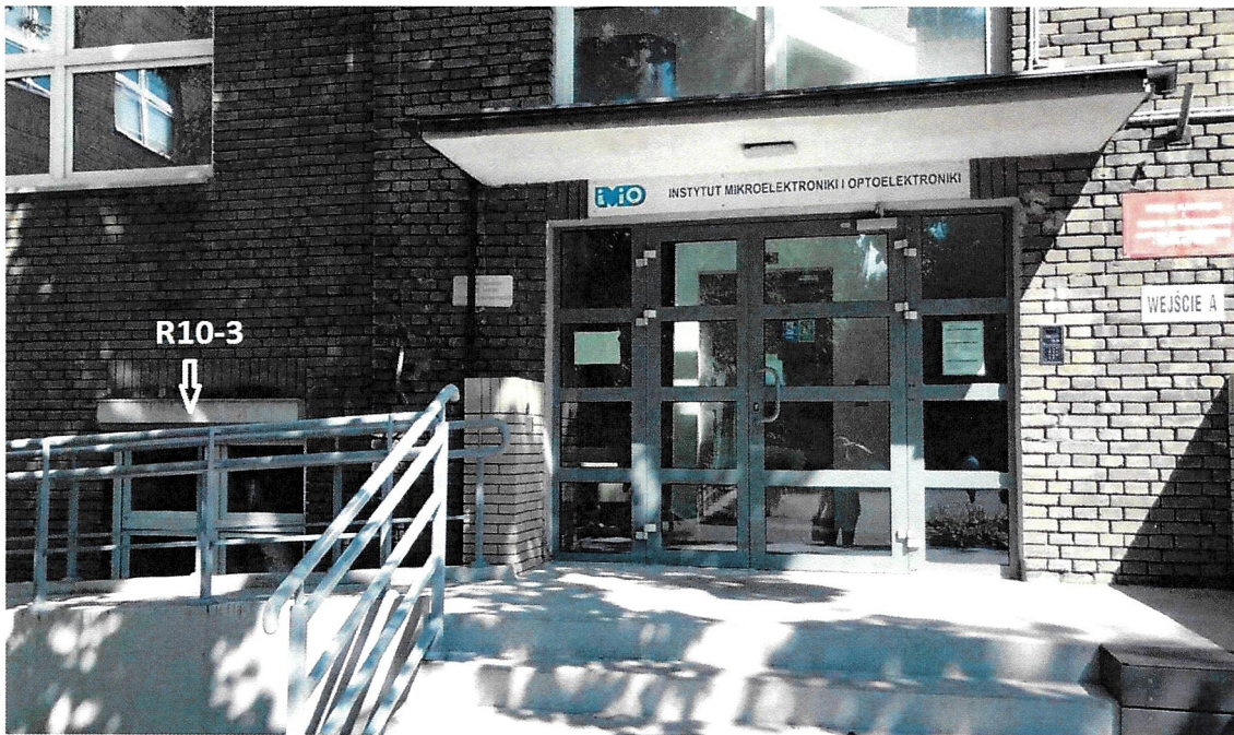
Rys. 4. Prezentacja lokalizacji rozdzielnic R10-3 od frontu budynku Wydziału Elektroniki i Technik Informatycznych, Instytut Mikroelektroniki i Optoelektroniki
