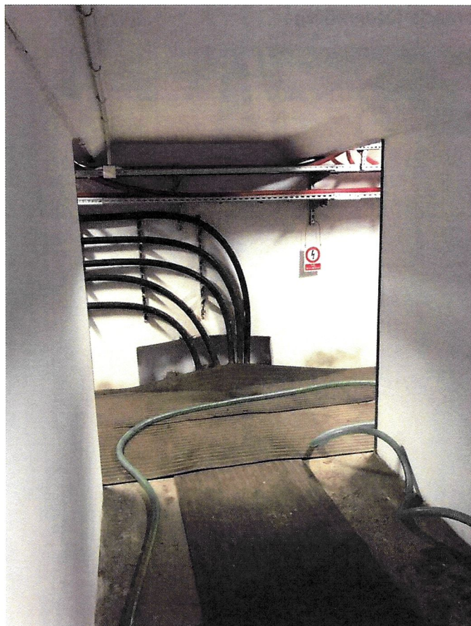
Widok kablowni R1-0 – fragment podpiwniczenia.
