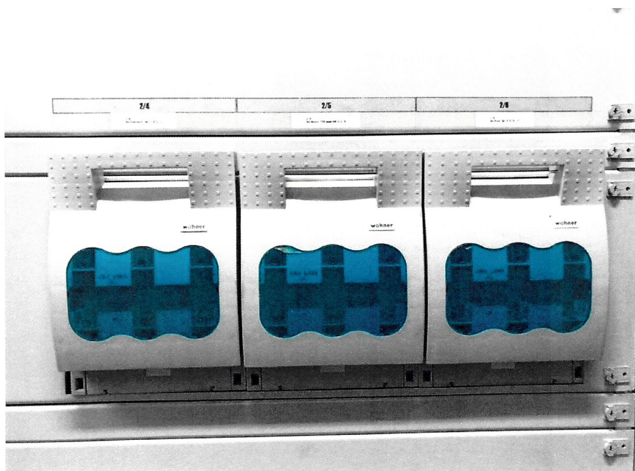
Widok aparatów w rozdzielnicy R1-0 – Sekcja 2/4 zabezpieczenie linii w kierunku R10-3.
