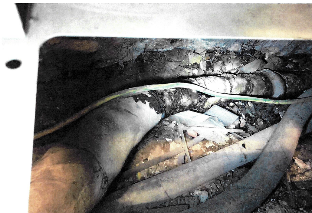
Linia kablowa K2 w kanale pod R10-4 – wyciek syciwa.
