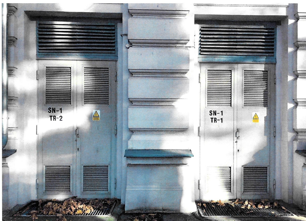
Widok komór transformatorowych przy R1-0.
