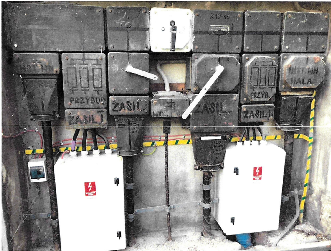
Widok rozdzielnicy R10-15.
