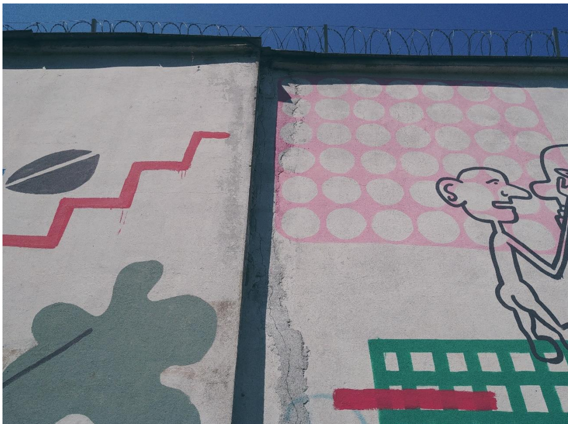
Fot. Nr 17, 18. Areszt Śledczy z1900 roku, mur obejmujący obszar więzienia, stan zachowania w 2019 r. Fragment muru od strony jeziora, mural zasłaniający wielokrotnie naprawiane tynki. Na górnej fotografii widoczny wyoblony narożnik ogrodzenia a także obróbka blacharska osłaniająca gzyms okapnikowy. Spękania muru i widoczne betonowe fundamentowanie z odbitym w zaprawie drewnianym szalunkiem. Nieregularne zatarcia tynków zachodzących na wylewkę. Uskok występu ogrodzenia dzielący mur na odcinki 4-5 metrowe.
