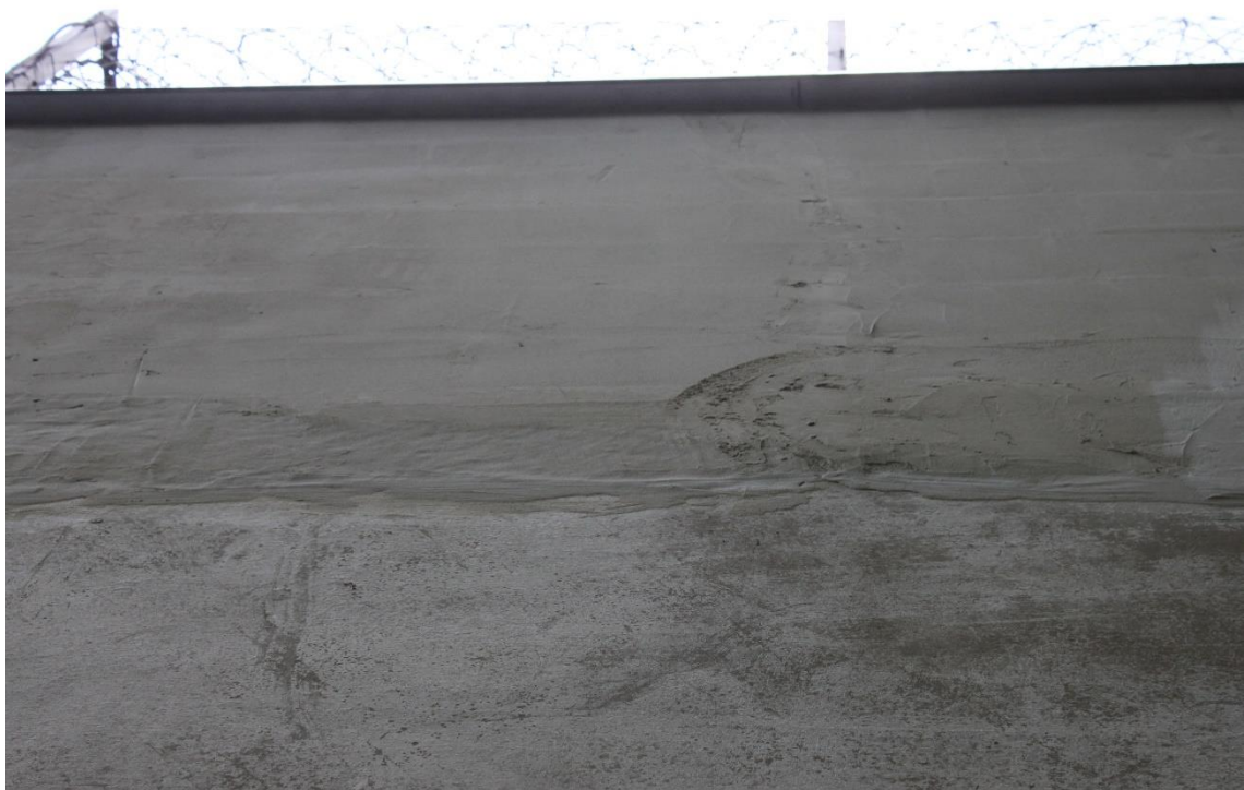
Fot. Nr 36, 37. Areszt Śledczy z1900 roku, mur obejmujący obszar więzienia, stan zachowania w 2019 r. Widok ogólny ostatni fragment muru od strony północno-zachodniej połączony z budynkiem. Ostatni odcinek muru współcześnie, uskokowo nadbudowany przy pomocy dużych bloczków silikatowych na które zatarto równomiernie współczesny tynk cementowy i klej do styropianu.
