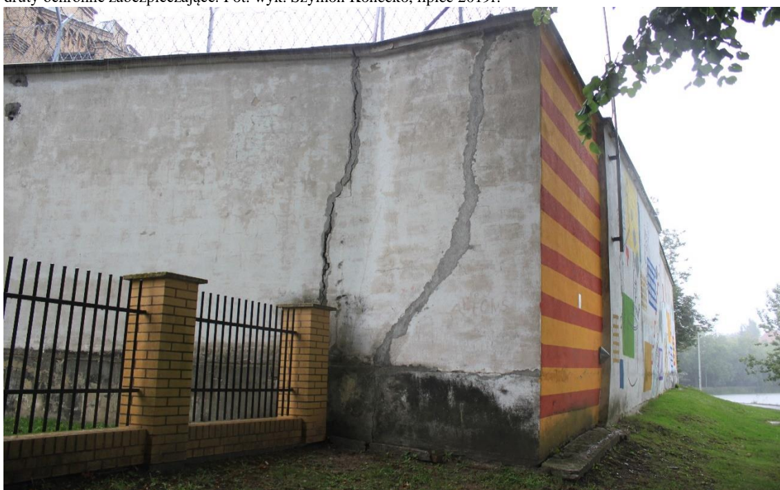
Fot. Nr 2. Areszt Śledczy z1900 roku, mur obejmujący obszar więzienia, stan zachowania w 2019 r. Widoczne zniszczenia pd-wsch narożnika muru od strony jeziora, Niebezpieczne spękania konstrukcyjne związane z ruchami podłoża. Pionowe rozwarstwienia biegnące przez całą wysokość muru i przez całą grubość. Część fundamentowa pokryta mikroorganizmami, korona muru nakryta nakrywą cementową z kapinosem o prostokątnym przekroju. W koronie zamontowane druty ochronne zabezpieczające. Ogrodzenie ozdobione murem w części wzdłuż jeziora i w kierunku pn-zach. Fot. wyk. Szymon Konecko, lipiec 2019r.
