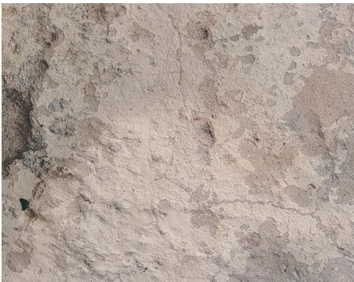
Fot. Nr 9, 10. Areszt Śledczy z1900 roku, mur obejmujący obszar więzienia, stan zachowania w 2019 r. Widoczne zniszczenia pd-wsch narożnika muru od strony jeziora, fragment oryginalnego drobnoziarnistego tynku z pobiałą przełamana ą ugiem.
