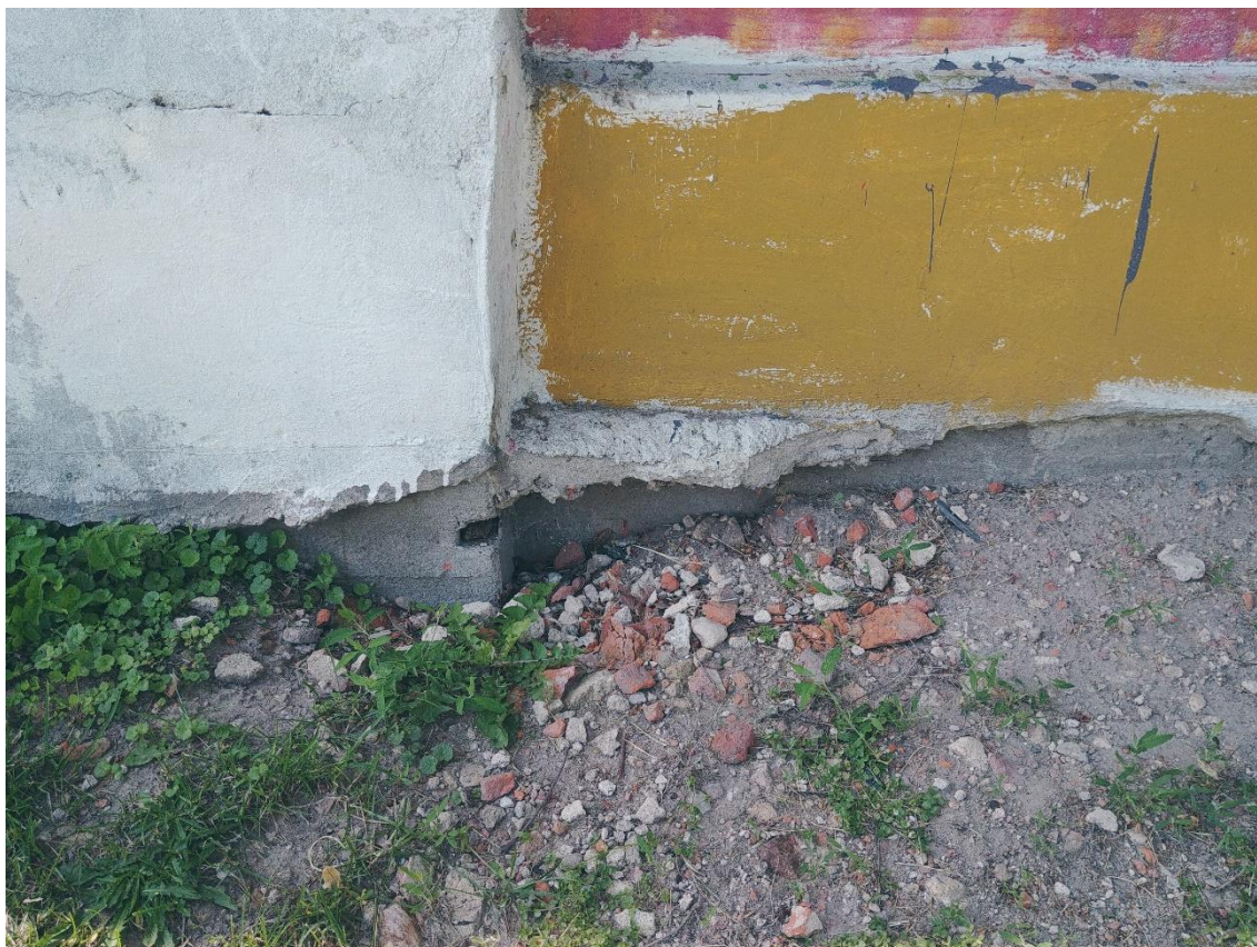
Fot. Nr 21, 22. Areszt Śledczy z1900 roku, mur obejmujący obszar więzienia, stan zachowania w 2019 r. Fragment muru od strony jeziora, mural zasłaniający wielokrotnie naprawiane tynki. Na górnej fotografii widoczna wieża strażnicza, betonowy podest osadzony na dwuteownikach, powiększony z dwóch stron dolewkami. W osi wieży mur jest cofnięty o 5-6cm. Obróbka blacharska osłania gzyms okapnikowy. Spękania muru związane z ruchami podłoża oraz zdylatowaniem się sztywnego ogrodzenia. Widoczne betonowe fundamentowanie z odbitym w zaprawie drewnianym szalunkiem. Nieregularne zatarcia tynków zachodzących na wylewkę.
