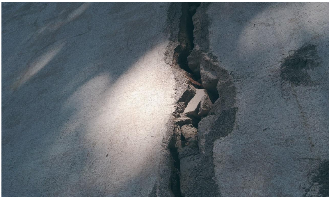
Fot. Nr 7. Areszt Śledczy z1900 roku, mur obejmujący obszar więzienia, stan zachowania w 2019 r. Widoczne zniszczenia pd-wsch narożnika muru od strony jeziora, Niebezpieczne spękania konstrukcyjne związane z ruchami podłoża. Pionowe rozwarstwienia biegnące przez całą wysokość muru i przez całą jego grubość. W szczeliny rozwarcia zauważalna pierwotna budowa muru z białych silikatowych cegieł spojonych słabą drobnoziarnistą zaprawą, wapienno-piaskowo-cementową, która straciła swoją wytrzymałość. Na zewnątrz mur pokryto 2-3cm warstwą silnego cementowego tynku i pobielono białą farbą emulsyjną. Fot. wyk. Szymon Konecko, lipiec 2019r.
