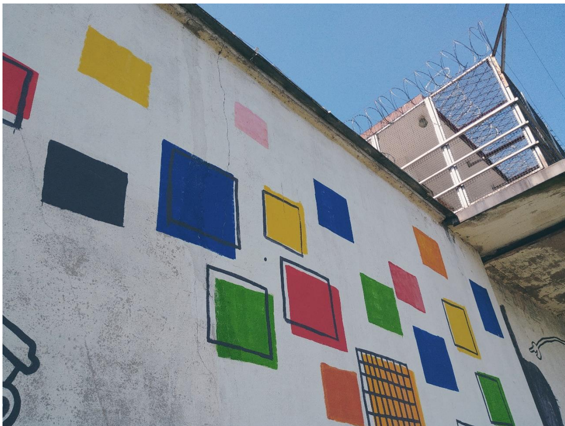
Fot. Nr 19, 20. Areszt Śledczy z1900 roku, mur obejmujący obszar więzienia, stan zachowania w 2019 r. Fragment muru od strony jeziora, mural zasłaniający wielokrotnie naprawiane tynki. Na górnej fotografii widoczna wieża strażnicza, podest betonowy osadzony na dwuteownikach, powiększony z dwóch stron dolewkami. W osi wieży mur jest cofnięty o 5-6cm. Obróbka blacharska osłania gzyms okapnikowy. Spękania muru i widoczne betonowe fundamentowanie z odbitym w zaprawie drewnianym szalunkiem. Nieregularne zatarcia tynków zachodzących na wylewkę. Wzdłuż muru ziemia nasypaana w kierunku fundamentów, brak ukształtowania odprowadzenia wody opadowej.
