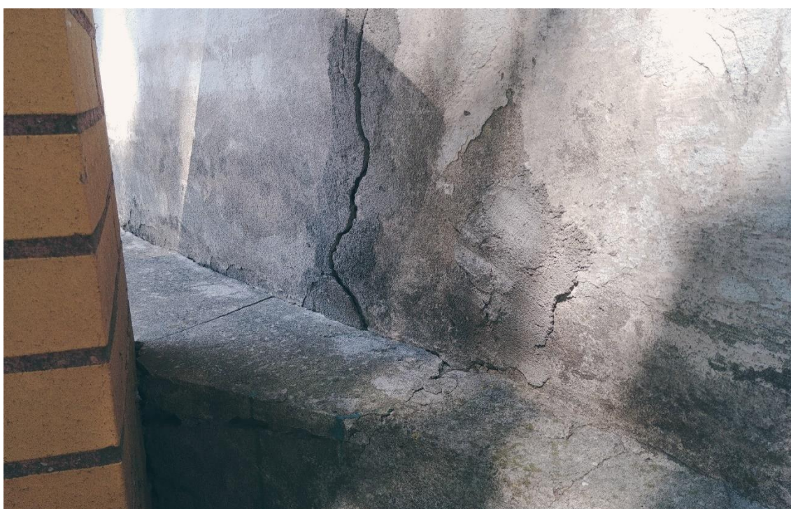
Fot. Nr 8. Areszt Śledczy z1900 roku, mur obejmujący obszar więzienia, stan zachowania w 2019 r. Widoczne zniszczenia pd-wsch narożnika muru od strony jeziora, Niebezpieczne spękania konstrukcyjne związane z ruchami podłoża. Szttywne cementowe tynki o współczesnym pochodzeniu, jakie założono nieestetycznie na powierzchnię muru utrzymują zawilgocenie, przemarzanie takiego podłoża sprawia, że dochodzi do rozsądzenia struktury zarówno murowanej ściany jak i słabszych tynków znajdujących się w spodnich warstwach. Dochodzi wówczas do odspojeń tynków, rozluźnienia i zachwiania parametrów wytrzymałościowych muru. Fot. wyk. Szymon Konecko, lipiec 2019r.
