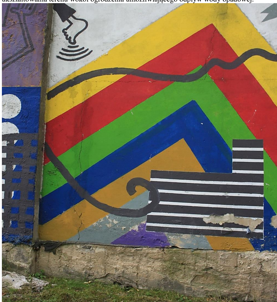
Fot. Nr 31. Areszt Śledczy z1900 roku, mur obejmujący obszar więzienia, stan zachowania w 2019 r. Fragment muru od strony jeziora, mural zasłaniający wielokrotnie naprawiane tynki ogrodzenia. Widoczne spękania ogrodzenia w różnych kierunkach. Większość z nich są związane z ruchami podłoża oraz przemarzania. Po mimo nasypanej ziemi zasłaniającej fundament, brak regularnego ukształtowania terenu wokół ogrodzenia umożliwiającego odpływ wody opadowej. Spod warstw farb spoziera nieregularność i nieestetyczność wykonywanych doraźnych napraw tynków. W wewnętrznym narożniku uskoku zauważalny fragment izolacji papą części fundamentowej. Wystająca betonowa ława o nieregularnej powierzchni jest zniszczona, pokryta glonami. Utrzymujące się zawilgocenie ściany powoduje niszczenie cienkowarstwowych ostatnich zatarć związanych z odnowieniem podłoża i pomalowaniem muralu. Widoczne łuszczenie się wierzchnich warstw.
