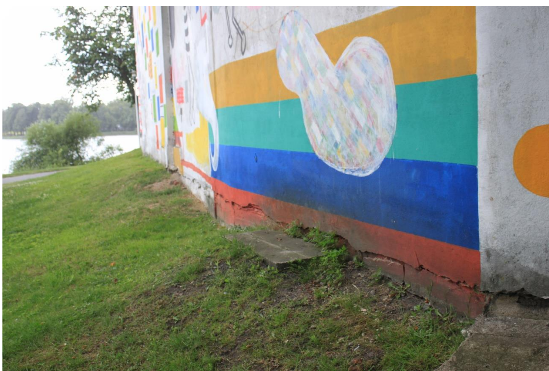
Fot. Nr 26, 27. Areszt Śledczy z1900 roku, mur obejmujący obszar więzienia, stan zachowania w 2019 r. Fragment muru od strony jeziora, mural zasłaniający wielokrotnie naprawiane tynki. Na górnej fotografii wadliwie połączona i wyprofilowana obróbka blacharska osłaniająca gzyms okapnikowy jest przyczyną zalewania korony muru. Spękania muru związane z ruchami podłoża oraz przemarzania strefy przyziemia. Po mimo nasypanej ziemi zasłaniającej fundament, brak regularnego ukształtowania terenu wokół ogrodzenia umożliwiającego odpływ wody opadowej.
