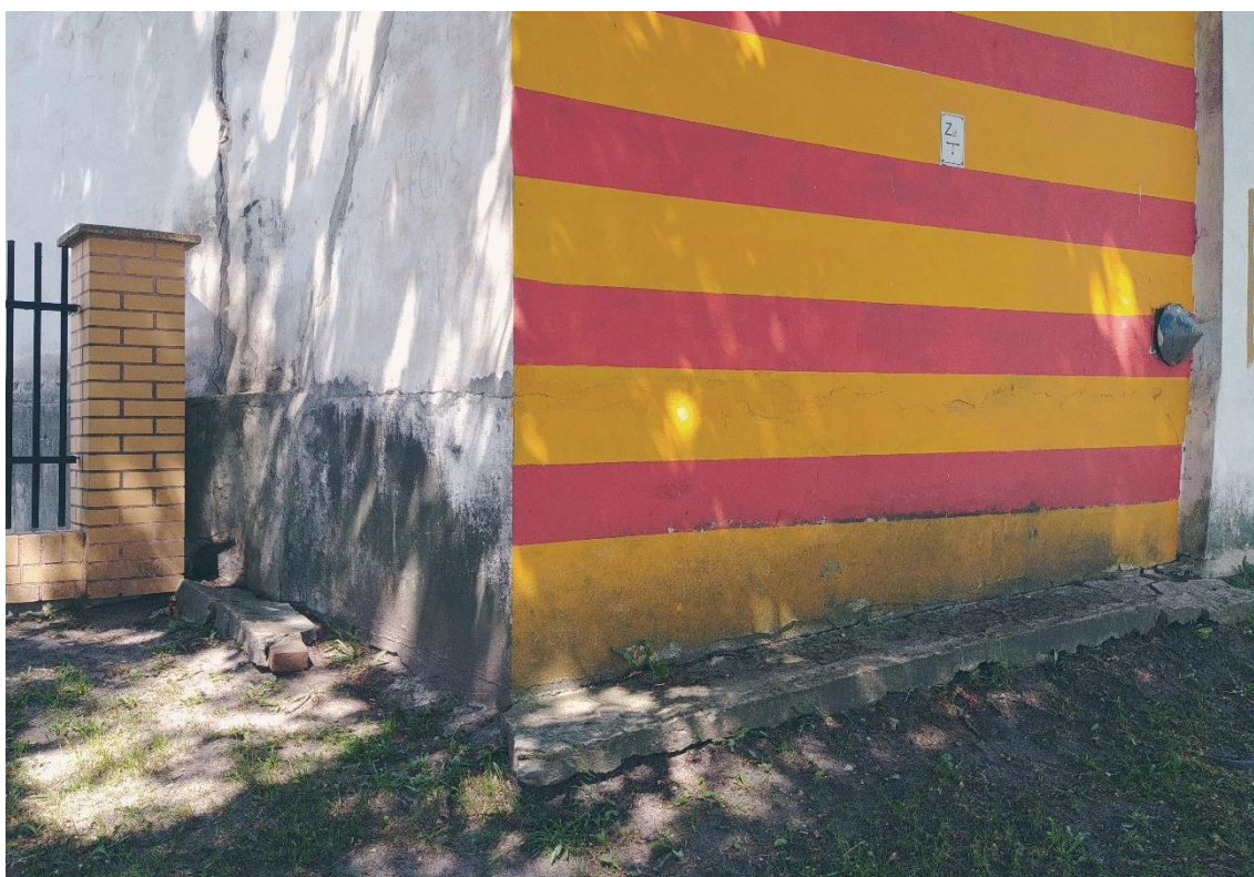
Fot. Nr 5,6. Areszt Śledczy z1900 roku, mur obejmujący obszar więzienia, stan zachowania w 2019 r. Widoczne zniszczenia pd-wsch narożnika muru od strony jeziora, Niebezpieczne spękania konstrukcyjne związane z ruchami podłoża. Pionowe rozwarstwienia biegnące przez całą wysokość muru i przez całą jego grubość. Cementowe tynki osłaniające fundament spękane i odspojone, rozwarstwiają się od wybudowanej ceglami silikatowymi ściany. Część fundamentowa pokryta mikroorganizmami, korona muru nakryta nakrywą cementową z kapinosem o prostokątnym przekroju. W koronie zamontowane druty ochronne zabezpieczające. Ogrodzenie ozdobione murałem w części wzdłuż jeziora i w kierunku pn-zach. W przyziemiu fragmenty betonowych krawężników i odspojonych sztywnych wylewek pełniących funkcje opasek, utrzymujących narożnik. Fot. wyk. Szymon Konecko, lipiec 2019r.
