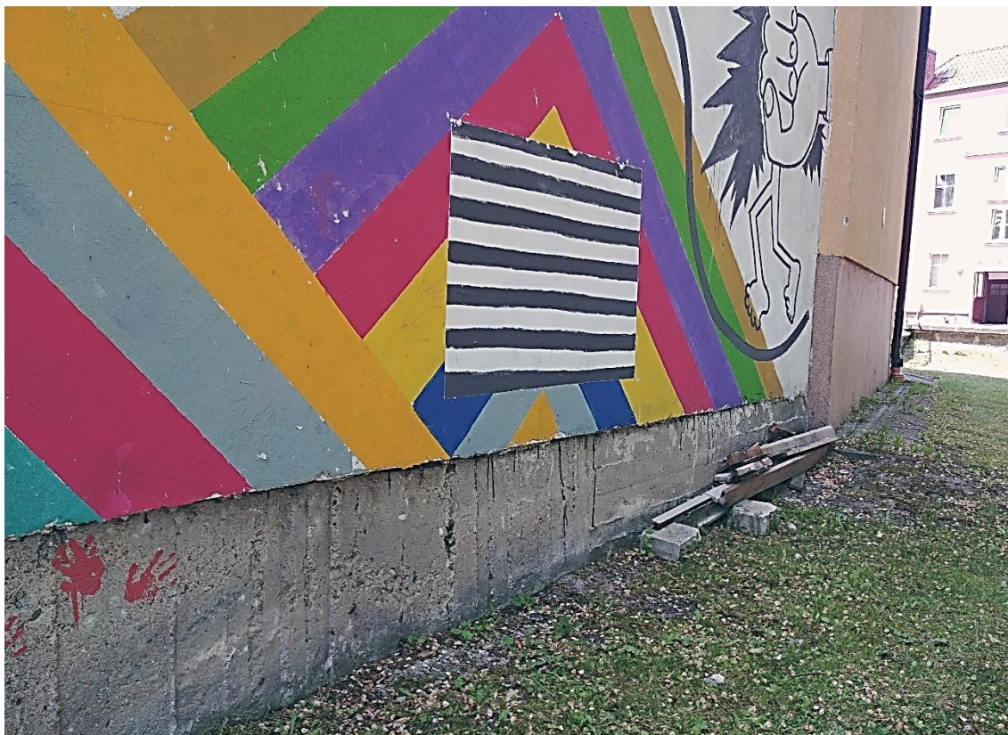
Fot. Nr 34, 35. Areszt Śledczy z 1900 roku, mur obejmujący obszar więzienia, stan zachowania w 2019 r. Widok ogólny ostatni fragment muru od strony północno-zachodniej połączony z budynkiem. Mural zasłaniający wielokrotnie naprawiane tynki ogrodzenia. Wystająca betonowa ława o nieregularnej powierzchni jest zniszczona, wierzchnia warstwa odlewu, otuliny pokryta glonami. Widoczna izolacja fundamentu papą, zacieki smoły. Zauważalne jest odcinkowe wykonywanie fundamentu. Utrzymujące się zawilgocenie ściany powoduje niszczenie cienkowarstwowych ostatnich zatarć związanych z odnowieniem podłoża i pomalowaniem muralu. Widoczne tuszczenie się wierzchnich zatarć. Ostatni odcinek muru nadbudowany współcześnie przy pomocy dużych bloczków silikatowych na które zatarto równomiernie współczesny tynk cementowy.
