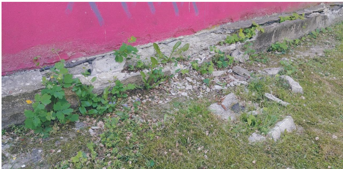
Fot. Nr 30. Areszt Śledczy z1900 roku, mur obejmujący obszar więzienia, stan zachowania w 2019 r. Fragment muru od strony jeziora, mural zasłaniający wielokrotnie naprawiane tynki ogrodzenia. Spękania związane z ruchami podłoża oraz przemarzania. Po mimo nasypanej ziemi zasłaniającej fundament, brak regularnego ukształtowania terenu wokół ogrodzenia umożliwiającego odpływ wody opadowej.
