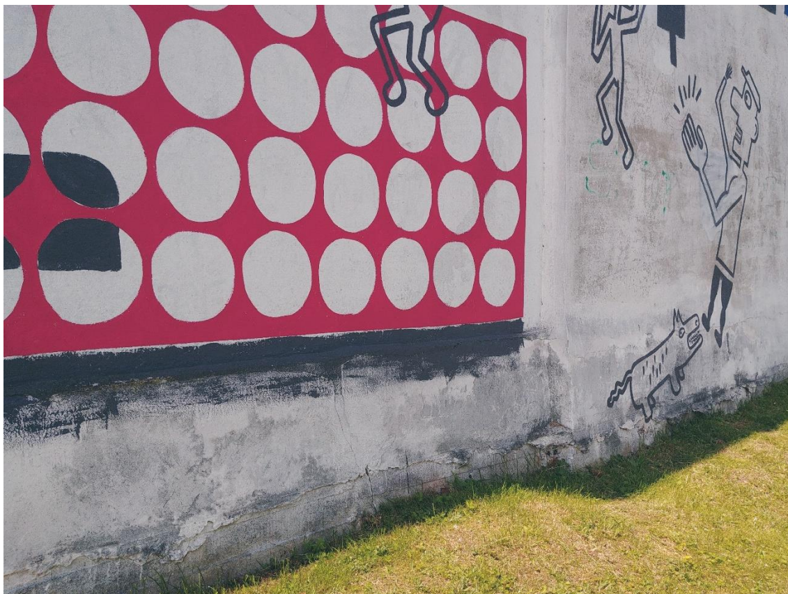
Fot. Nr 15, 16. Areszt Śledczy z1900 roku, mur obejmujący obszar więzienia, stan zachowania w 2019 r. Fragment muru od strony jeziora, mural zasłaniający wielokrotnie naprawiane tynki. Na górnej fotografii widoczny wyoblony narożnik ogrodzenia a także obróbka blacharska osłaniająca gzyms okapnikowy . Na dolnej fotografii spękania muru i widoczne betonowe fundamentowanie z odbitym w zaprawie drewnianym szalunkiem. Nieregularne zatarcia tynków zachodzących na wylewkę. Uskok występu ogrodzenia dzielący mur na odcinki 4-5 metrowe.
