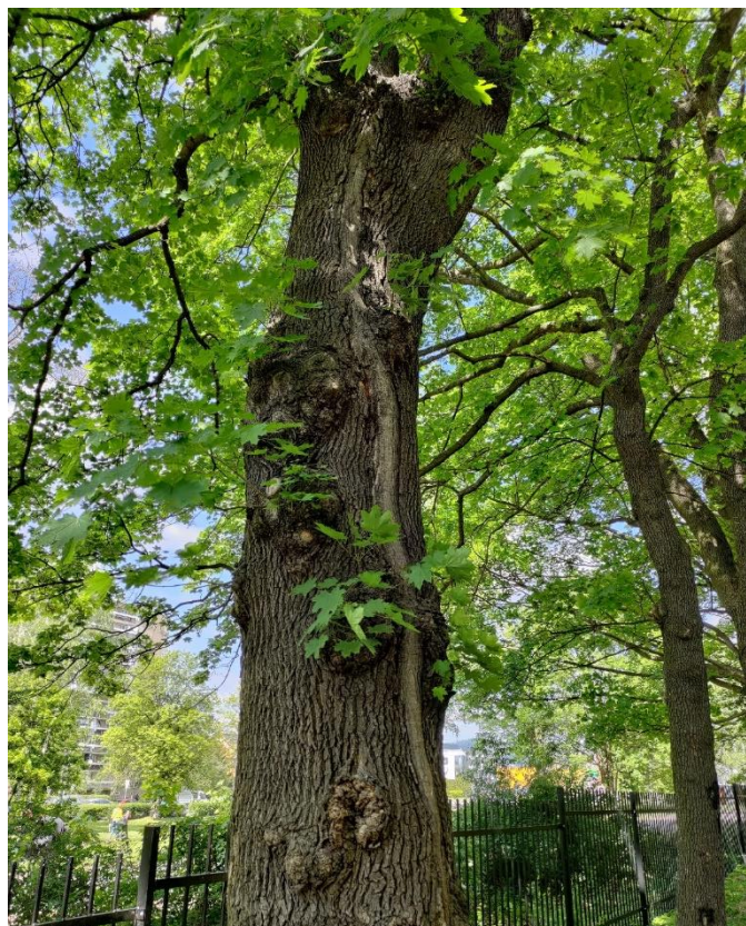
Ryc. 20. Stare uszkodzenie pionowe drzewa zalane miazgą.
