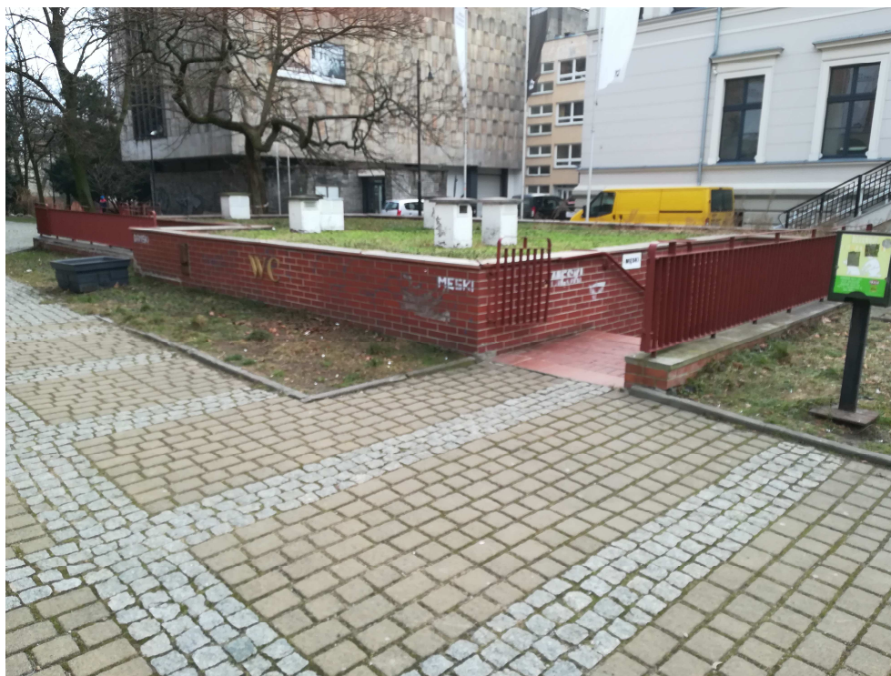
Zdjęcie 1 Toaleta miejska do remontu elewacji
