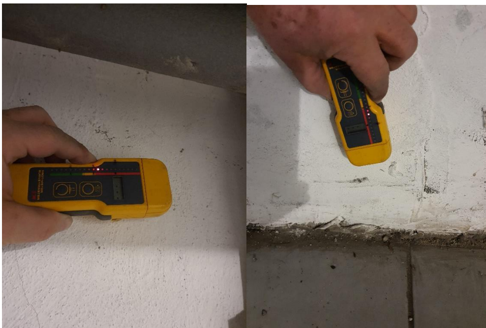
Fot. 57, 58 Ściana południowa: pomiar wilgotności strukturalnej przy użyciu sondy radiowej (Protimeter SurveyMaster SM, krzywa kalibracji wg miernika karbidowego CM-Gerat): na wysokości ok. +1,2m ppp, w bezpośrednim sąsiedztwie pacy sklepiennej, wynik 8% - ściana zawilgocona. Po prawej: ściana południowa w części cokołowej, wynik: 9% - ściana zawilgocona.
