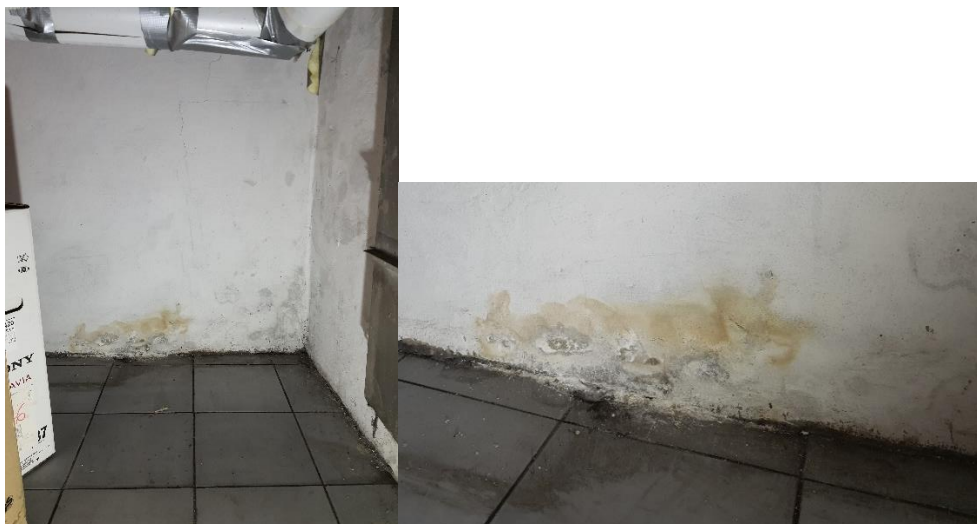
Fot. 51, 52 Ściana wschodnia i narożnik płd-wsch.: przebarwienie pod wpływem zawilgocenia dolnych fragmentów ściany i narożnika, destrukcja powłok malarskich w narożniku, wykwit soli budowlanych. Po prawej: powiększenie na dolny fragment ściany zachodniej: wykwit solne na ścianie i w narożniku na połączeniu z okładziną ceramiczną.
