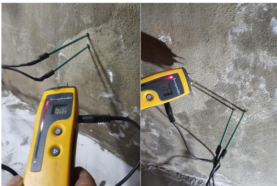
Fot. 37, 38 Ściana północna: pomiar wilgotności strukturalnej ściany ceglanej przy użyciu sond wgłębnych w wykonanych odwiertach (Protimeter SurveyMaster SM, krzywa kalibracji wg miernika karbidowego CM-Gerat), wyniki: >20% - ściana bardzo silnie zawilgożona.
