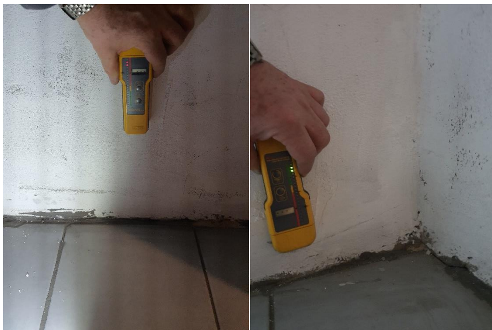
Fot. 23, 24 Ściana zachodnia (rys. 3: okolice pkt. 7): pomiar wilgotności strukturalnej ściany ceglanej przy użyciu sondy radiowej (Protimeter SurveyMaster SM, krzywa kalibracji wg miernika karbidowego CM-Gerat), wynik: po lewej na wysokości ok. +0,3m ppp: 16% - ściana bardzo silnie zawilgocona, po prawej na wysokości +1,00m ppp: 11% - ściana silnie zawilgocona.
