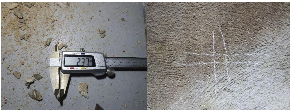
Fot. 9, 10 Pomiar grubości zewnętrznej wyprawy z zaprawy cementowej o wysokiej wytrzymałości – wynik: 2,37mm. Po prawej: zarysowana powierzchnia zewnętrznej wyprawy – widoczna bardzo wysoka twardość.
