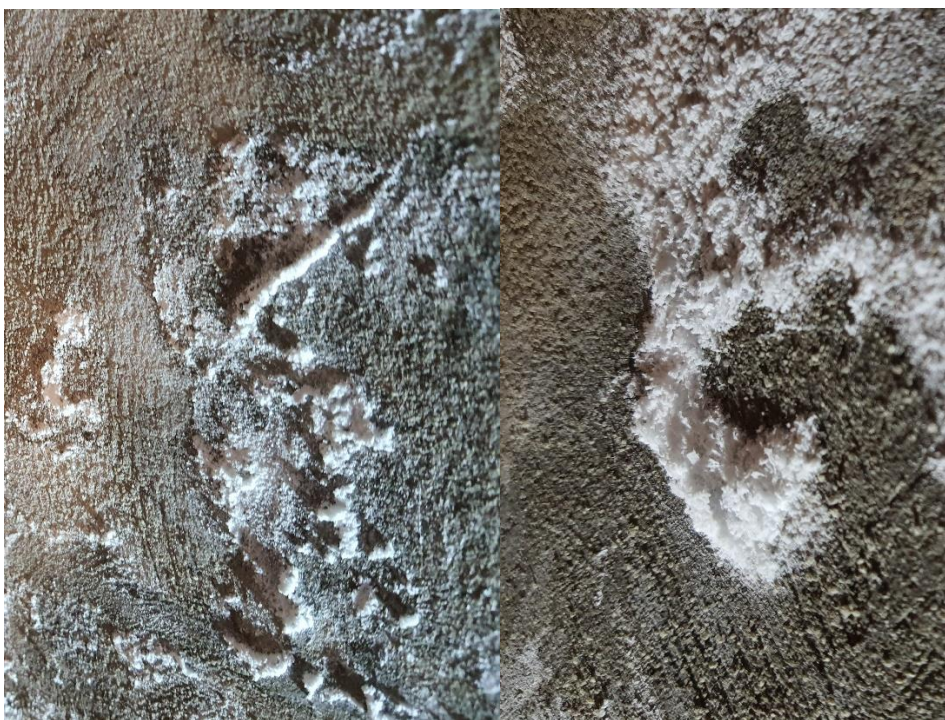
Fot. 5, 6 Ściana północna: nabudowane kryształki soli budowlanych na powierzchni wyprawy tynkarskiej.
