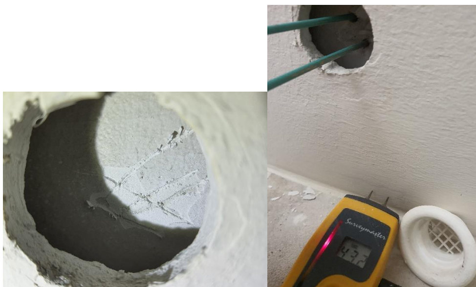
Fot. 76, 77 Ściana północna parteru pod zabudową pokryta powłoką z farby olejnej (lamperia). Powłoka ułożona na szpachli gipsowej o niskiej twardości – widoczne rysy wykonane rylcem. Po prawej: pomiar wilgotności powierzchniowej szpachli po usunięciu warstwy lamperii olejnej – wilgotność 14%.
