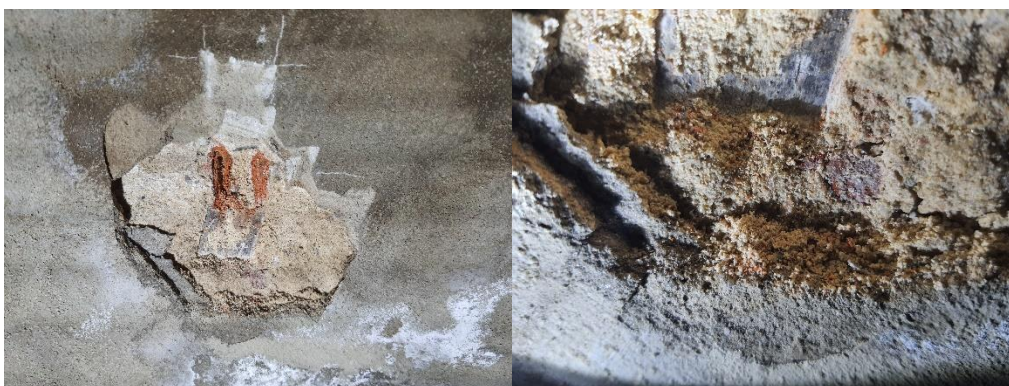
Fot. 7, 8 Ściana północna: odkrywka (rys. 3, pkt. 4). Ściana z cegły ceramicznej pełnej pokryta silnie skorodowanym tynkiem cem-wap. Na jego powierzchni wykonano cienkowarstwową wyprawę z zaprawy cementowej, tynk cementowy i kolejną warstwę tynku cementowego. Spoiny w murze ceglany silnie skorodowane na głębokość >3cm. Po prawej: zbliżenie na tynk cem-wap – widoczne kruszywo kwarcowe, spoiwo wypłukane.
