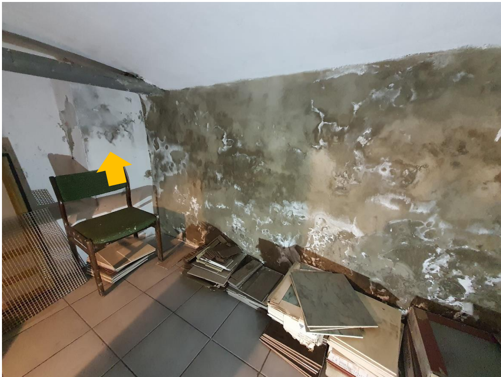
Fot. 1 Ściana południowa i narożnik półn-wsch.: przebarwiona w wyniku zawilgoceń ściana półn, widoczne intensywne wysolenia, korozja wypraw tynkarskich w narożniku.
