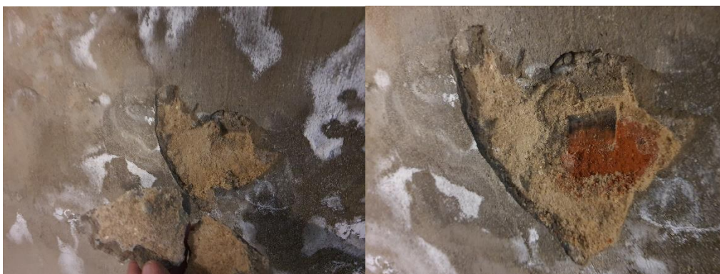
Fot. 33, 34 Ściana północna – głucha, wybrzuszona wyprawa tynkarska. W odkrywcę widoczna silna destrukcja pierwotnej wyprawy tynkarskiej i silna krystalizacja soli budowlanych na spodniej stronie zerwanej warstwy z zapraw cementowych
