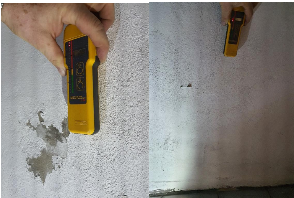
Fot. 21, 22 Ściana zachodnia (rys. 3: pomiędzy punktami 6 i 7): pomiar wilgotności strukturalnej ściany ceglanej przy użyciu sondy radiowej (Protimeter SurveyMaster SM, krzywa kalibracji wg miernika karbidowego CM-Gerat), wynik: po lewej na wysokości ok. +0,30m ppp: 20% - ściana bardzo silnie zawilgocona, po prawej na wysokości +0,70m ppp: 11% - ściana silnie zawilgocona.
