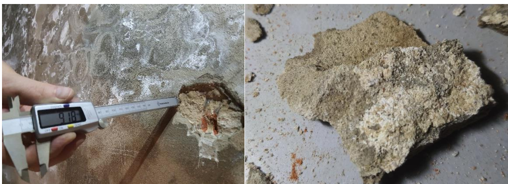
Fot. 11, 12 Pomiar grubości trzech warstw nakładanych kolejno cienkowarstwowych wypraw z zapraw cementowych wykonanych na powierzchni tynku cem-wap. – wynik: 9,18mm. Po prawej: spodnia powierzchnia odkutej wyprawy z zaprawy cementowej – widoczna silna koncentracja wykrystalizowanych soli budowlanych.
