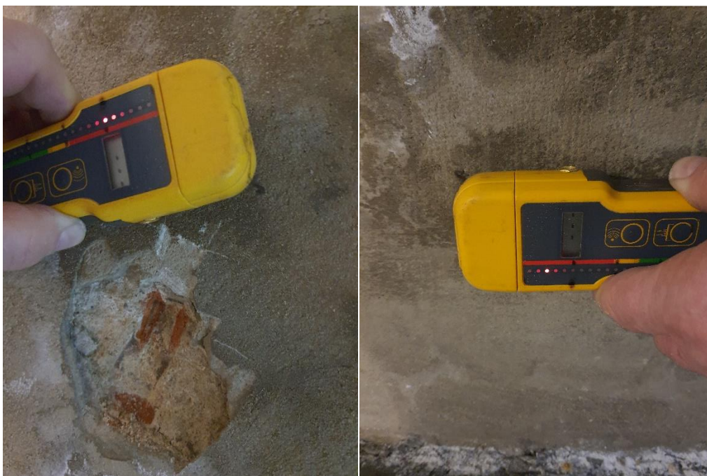
Fot. 31, 32 Ściana północna: pomiar wilgotności strukturalnej ściany ceglanej przy użyciu sondy radiowej (Protimeter SurveyMaster SM, krzywa kalibracji wg miernika karbidowego CM-Gerat), wynik: po lewej: 12% - ściana silnie zawilgocona, po prawej: 12% - ściana bardzo silnie zawilgocona.
