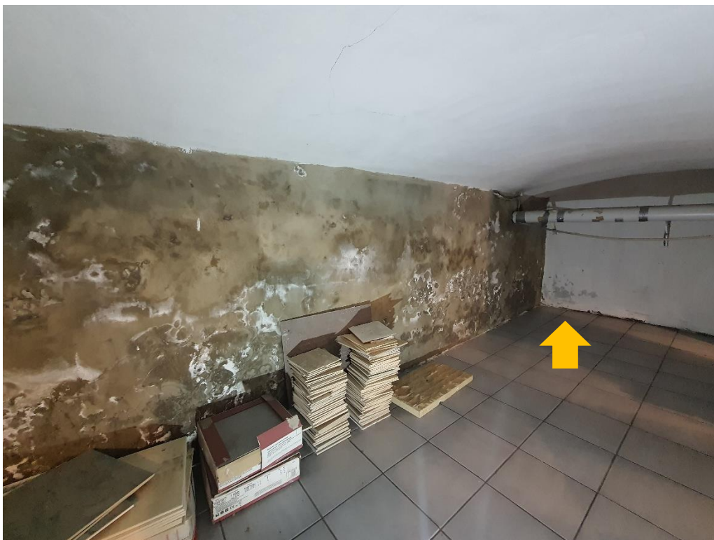
Fot. 2 Ściana południowa i narożnik półd-zach.: przebarwiona w wyniku zawilgoceń ściana półn, widoczne intensywne wysolenia, korozja wypraw tynkarskich w narożniku.
