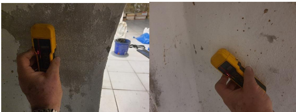
Fot. 61, 62 Ściana zachodnia: pomiar wilgotności strukturalnej przy użyciu sondy radiowej (Protimeter SurveyMaster SM, krzywa kalibracji wg miernika karbidowego CM-Gerat): wynik 9% - ściana zawilgocona. Po prawej: ściana zachodnia, wynik: 9% - ściana zawilgocona.
