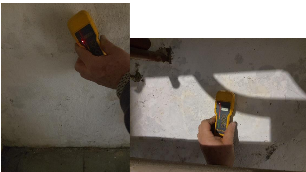
Fot. 55, 56 Ściana południowa: pomiar wilgotności strukturalnej przy użyciu sondy radiowej (Protimeter SurveyMaster SM, krzywa kalibracji wg miernika karbidowego CM-Gerat): po lewej, na wysokości ok. +0,40m ppp: wynik 11%, ściana silnie zawilgocona, po prawej na wysokości ok. +1,2m ppp: wynik 16% - ściana w bezpośrednim sąsiedztwie pachy sklepiennej bardzo silnie zawilgocona.
