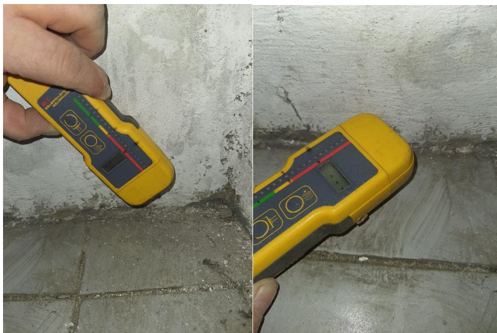
Fot. 53, 54 Narożnik płd-zach.: pomiar wilgotności strukturalnej przy użyciu sondy radiowej (Protimeter SurveyMaster SM, krzywa kalibracji wg miernika karbidowego CM-Gerat): po lewej: 11%, ściana silnie zawilgocona, po prawej: 13% - posadzka w narożniku bardzo silnie zawilgocona.
