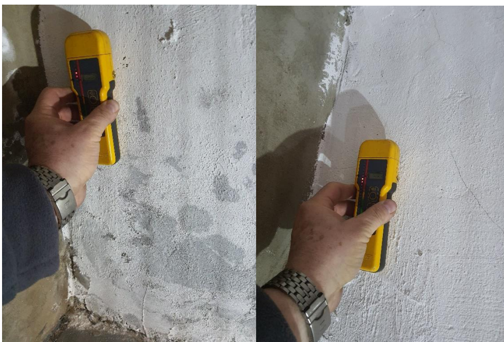
Fot. 17, 18 Narożnik płn-zach, ściana zachodnia (rys. 3, pkt. 6): pomiar wilgotności strukturalnej ściany ceglanej przy użyciu sondy radiowej (Protimeter SurveyMaster SM, krzywa kalibracji wg miernika karbidowego CM-Gerat), wynik: po lewej na wysokości ok. +0,70m ppp: 15% - ściana bardzo silnie zawilgocona, po prawej na wysokości +1,10m ppp: 11% - ściana silnie zawilgocona.
