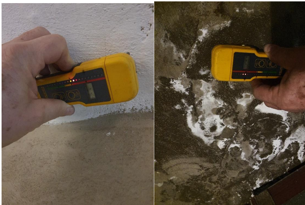
Fot. 35, 36 Ściana północna – pacha sklepienna, pomiar wilgotności strukturalnej ściany ceglanej przy użyciu sondy radiowej (Protimeter SurveyMaster SM, krzywa kalibracji wg miernika karbidowego CM-Gerat), wynik: 8% - sklepienie zawilgożone. Po prawej: pomiar na ścianie północnej, wynik: 13% - ściana silnie zawilgożona.
