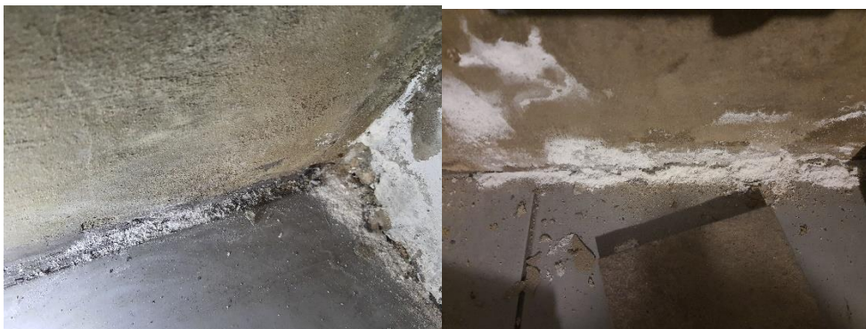
Fot. 25, 26 Narożnik płn-zach.: silna krystalizacji soli budowlanych w szczelinie pomiędzy ścianą a płytką ceramiczną - wynik długotrwałego okresowego zawilgocenia ściany. Po prawej: analogiczna sytuacja – rys. 3, pkt. 3.
