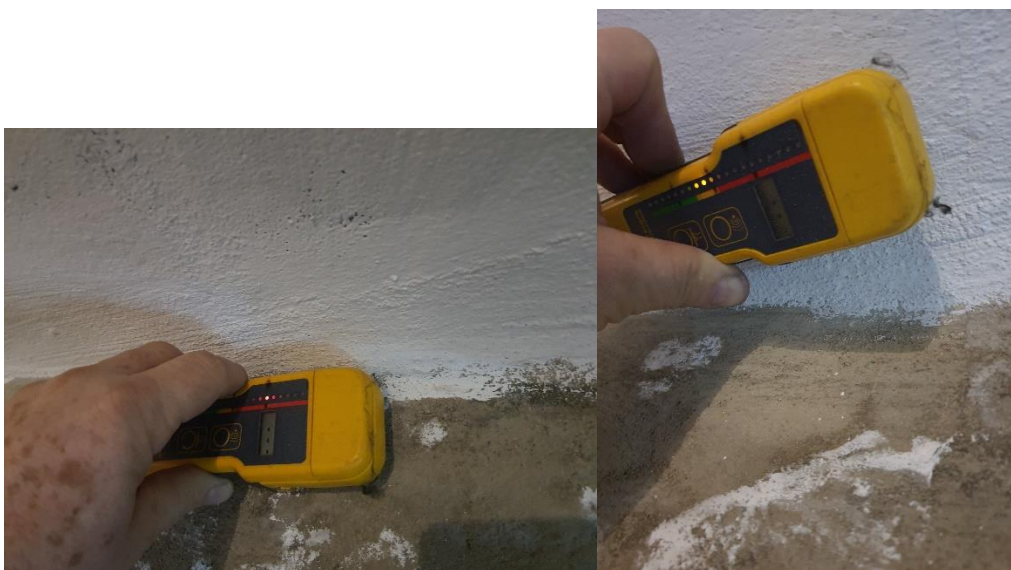
Fot. 29, 30 Ściana północna, pacha sklepienia: pomiar wilgotności strukturalnej ściany ceglanej przy użyciu sondy radiowej (Protimeter SurveyMaster SM, krzywa kalibracji wg miernika karbidowego CM-Gerat), wynik: po lewej: 12% - sklepienie silnie zawilgocone, po prawej: 5% - sklepienie zawilgocone.
