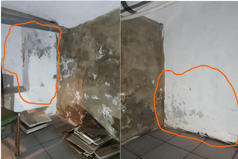
Fot. 3, 4 Narożnik pół-wsch.: obszar zawilgocenia i korozji wypraw tynkarskich na ścianie wschodniej. Po prawej: analogicznie – ściana zachodnia.
