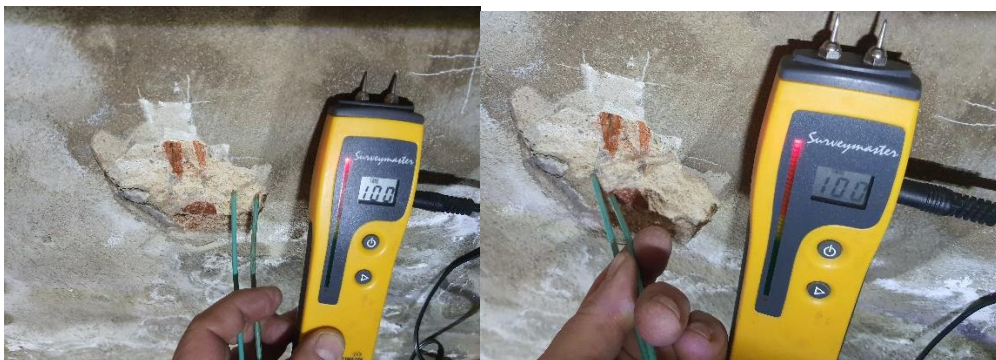
Fot. 15, 16 Odkrywka na ścianie północnej (rys. 3, pkt. 4): pomiar wilgotności powierzchniowej pierwszej warstwy tynku cem-wap. (Protimeter SurveyMaster SM, krzywa kalibracji wg miernika karbidowego CM-Gerat), wynik: >20%, ściana bardzo silnie zawilgocona.
