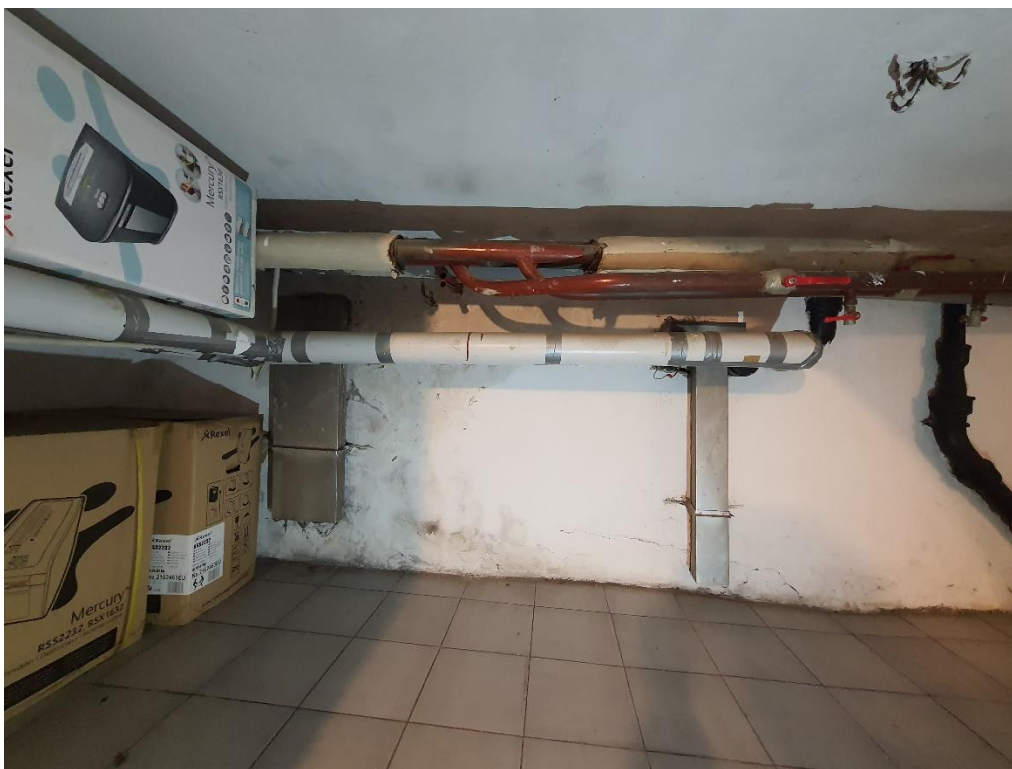
Fot. 49 Ściana południowa: w górnej części pomieszczenia występują instalacje, na wysokości pomieszczenia obudowy elementów wentylacji.
