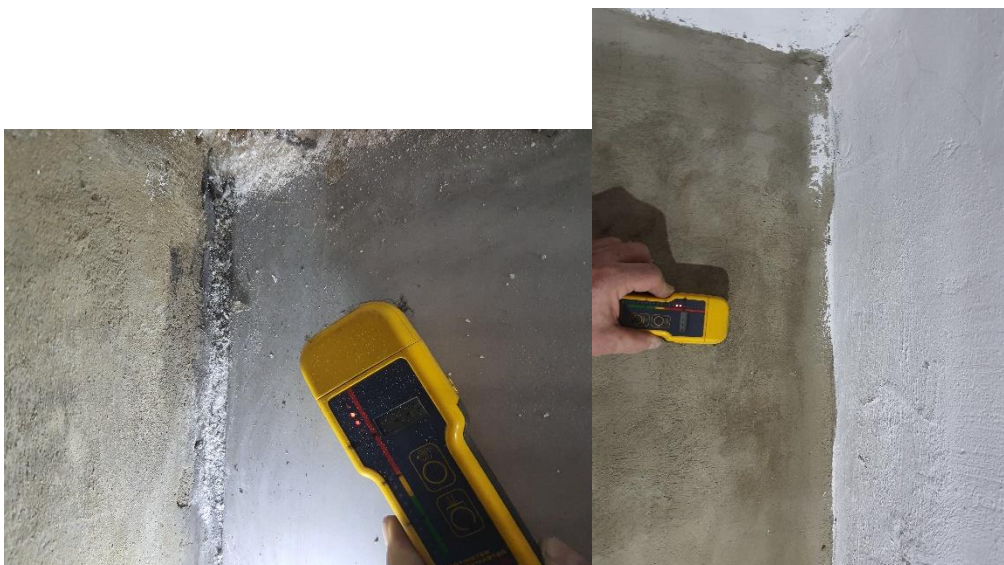
Fot. 27, 28 Narożnik płn-zach. (rys. 3: pkt. 6): pomiar wilgotności strukturalnej ściany ceglanej na wysokości >1,0m ppp przy użyciu sondy radiowej (Protimeter SurveyMaster SM, krzywa kalibracji wg miernika karbidowego CM-Gerat), wynik: po lewej: 15% - ściana bardzo silnie zawilgocona, po prawej: 10% - ściana silnie zawilgocona.
