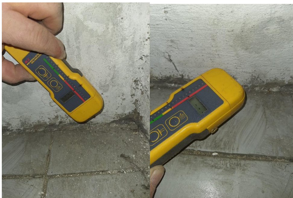
Fot. 41, 42 Narożnik półn-wsch., pomiar wilgotności strukturalnej przy użyciu sondy radiowej na wysokości ok. +0,05m ppp (Protimeter SurveyMaster SM, krzywa kalibracji wg miernika karbidowego CM-Gerat), wynik: 11% - ściana silnie zawilgocona. Po prawej: analogiczny pomiar wilgotności strukturalnej przyległego podkładu, wynik: 13% - podkład silnie zawilgocony.
