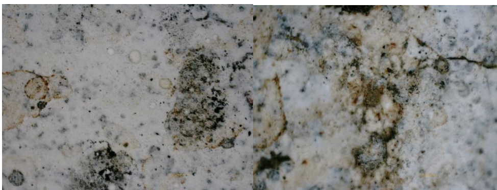
Fot. 65, 66 Ściana południowa: krystalizacja soli na powierzchni powłoki malarskiej, brak śladów porażenia biologicznego.
