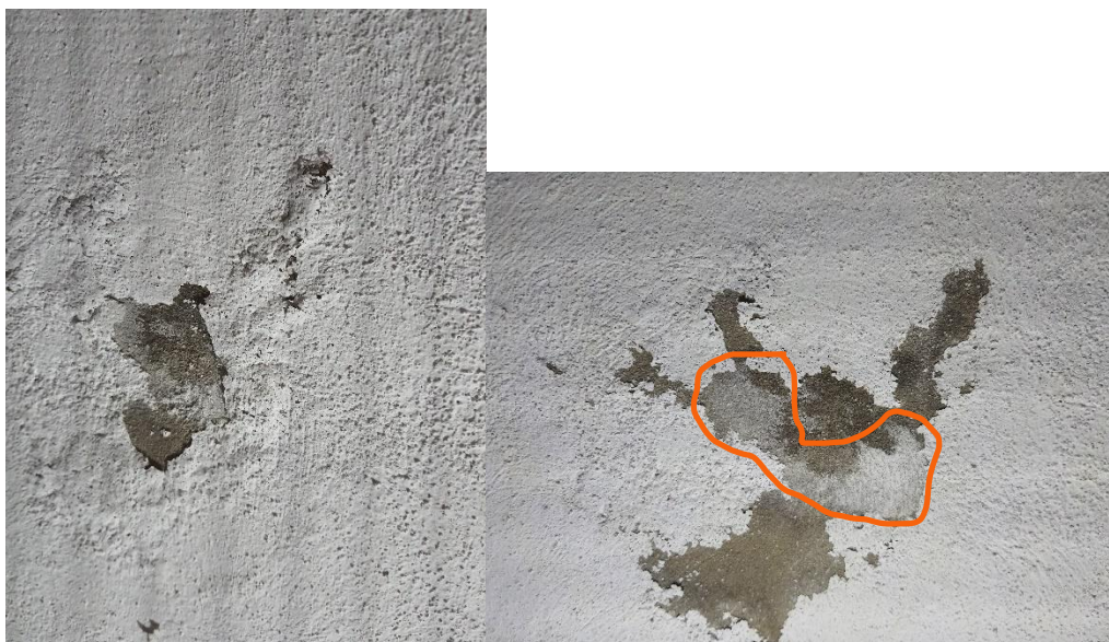
Fot. 19, 20 Ściana zachodnia, złuszczenie powłoki malarskiej w wyniku długotrwałego zawilgocenia na wysokości ok. +0,50m ppp. Po lewej wygląd pierwotny. Po prawej: powierzchnia wyprawy tynkarskiej po usunięciu powłoki – widoczne silne wysolenia na powierzchni tynku cementowego.
