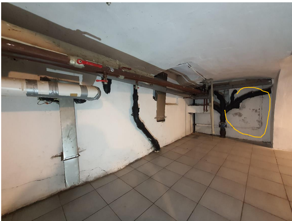
Fot. 50 Ściana południowa i narożnik płd-zach.: największy obszar występowania zawilgocenia wypraw tynkarskich występuje na wskazanym fragmencie ściany wschodniej w pobliżu ruraru technologicznego.
