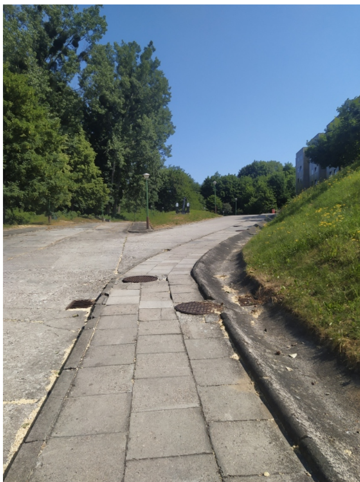
4. Nawierzchnia ist. z płyt betonowych chodnika do remontu, z odprowadzeniem wód deszczowych
