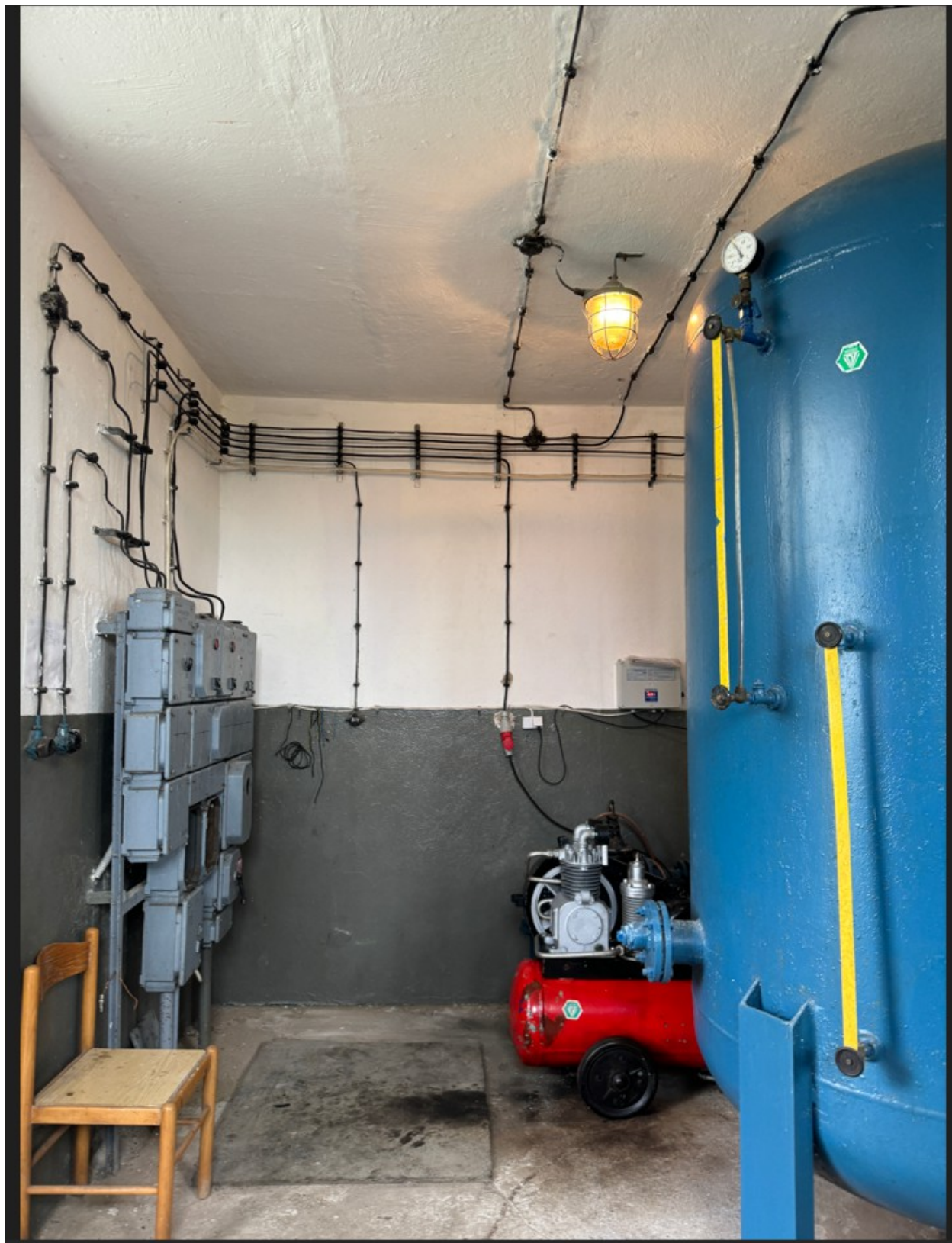
Istniejąca tablica elektryczna
