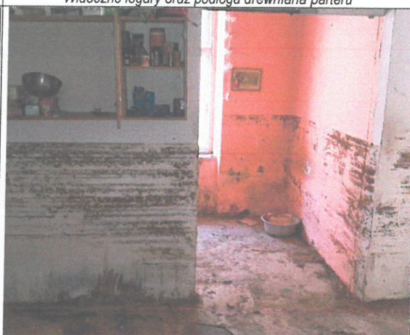
Fot. 12 Widok ogólny uszkodzeń pomieszczeń parteru. Stan techniczny wszystkich lokali zlokalizowanych na parterze zły. W celu umożliwienia korzystania z lokali na parterze konieczny jest remont generalny.
