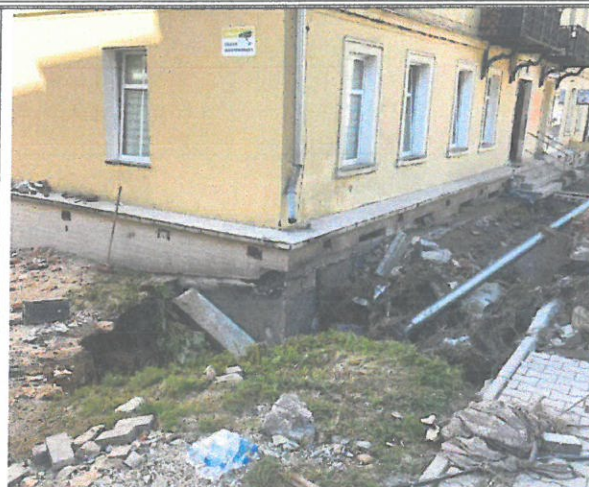
Fot. 4 Widok podmytego gruntu przy fundamencie- narożnik elewacji wschodniej i południowej. Fundamenty budynku zostały wzmocnione przy pomocy „gorsetu” żelbetowego po powodzi w 1997r.
