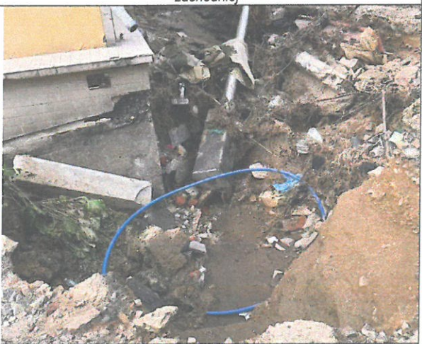
Fot. 8 Widok 2 podmytego gruntu przy fundamencie- narożnik elewacji wschodniej i południowej.
