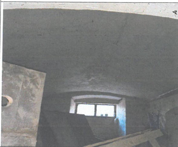
Fot. 17 Widok lokalnie zarysowanego sklepienia nad piwnicą
