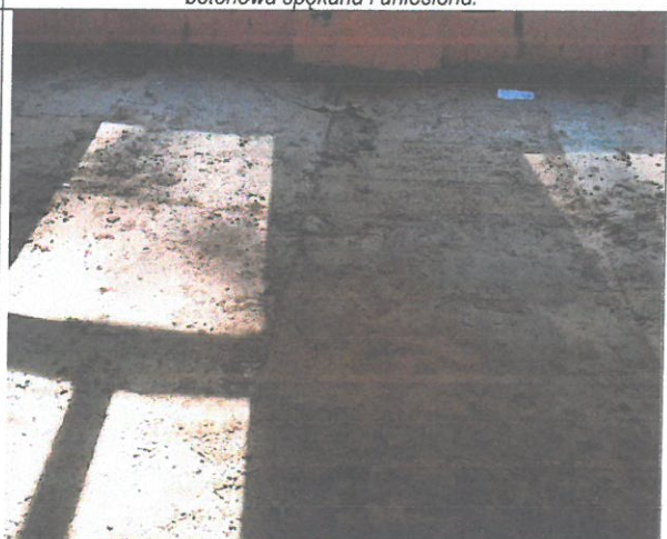
Fot. 20 Widok stanu technicznego podłóg drewnianych parteru. Podłogi nie kwalifikują się do dalszego użytkowania. Konieczna jest wymiana wszystkich podłóg na parterze.
