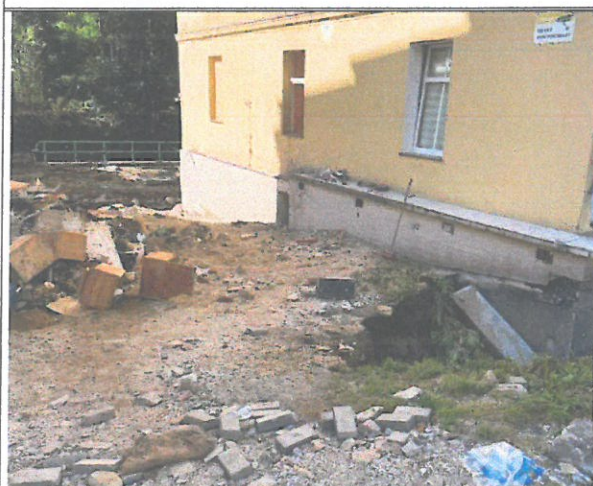
Fot. 5 Widok uszkodzeń przyziemia przy elewacji południowej
