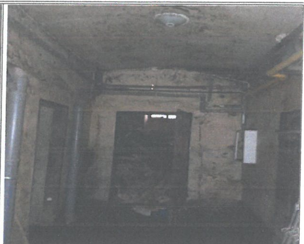
Fot. 16 Widok ogólny stanu technicznego piwnicy. Stan techniczny uniemożliwia użytkowanie pomieszczeń piwnicy. Konieczny jest remont generalny.
