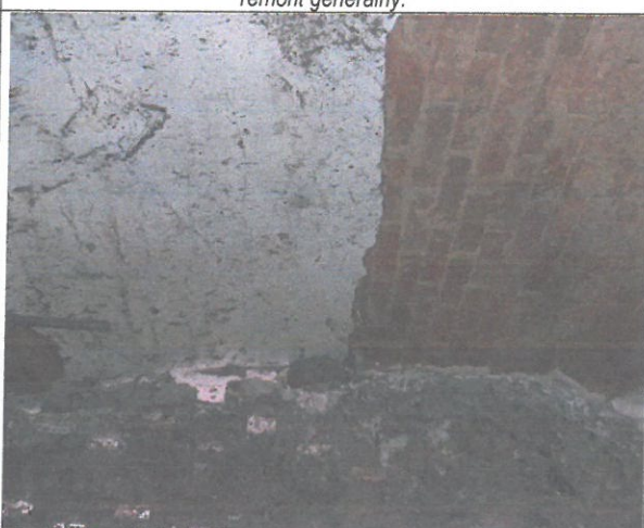
Fot. 14 Widok 2 pęknięcia i przemieszczenia sklepienia ceramicznego nad piwnicą
