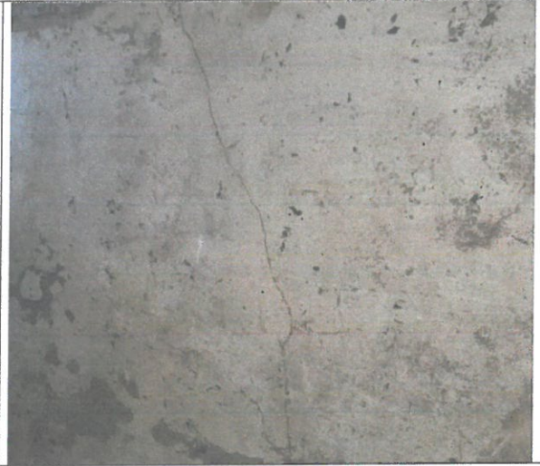
Fot. 22 Widok zarysowania ściany piwnicy.
