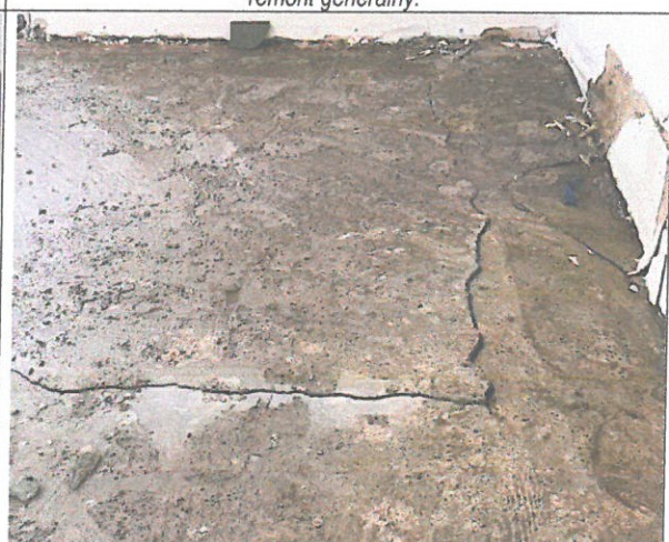
Fot. 18 Widok 1 uszkodzonej posadzki parteru. Posadzka betonowa spękana i uniesiona.
