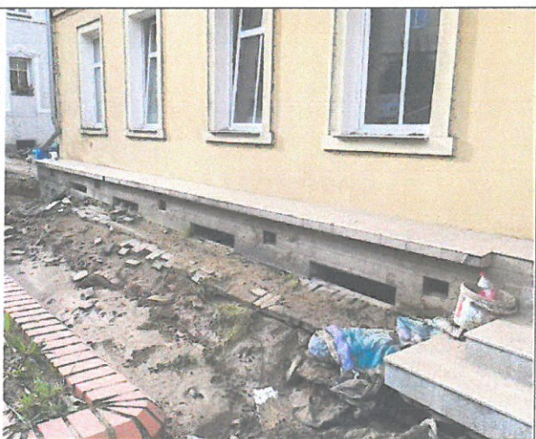
Fot. 7 Widok uszkodzeń przyziemia przy elewacji frontowej.
