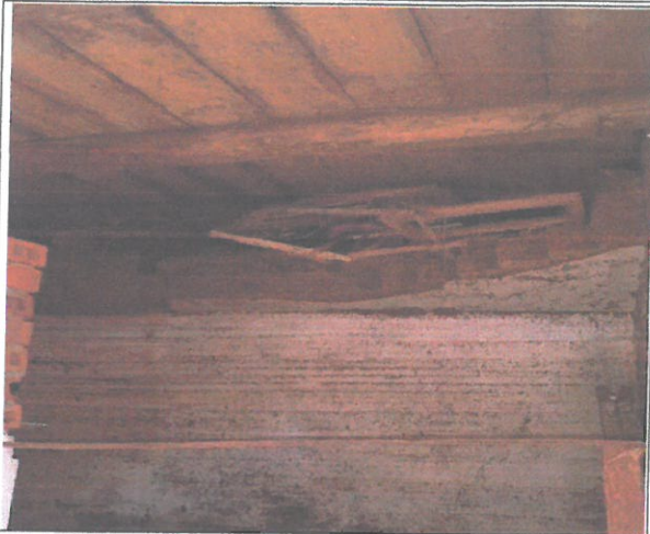
Fot. 9 Widok 1 pozostałości zawalonego sklepienia nad piwnicą. Widoczne legary oraz podłoga drewniana parteru
