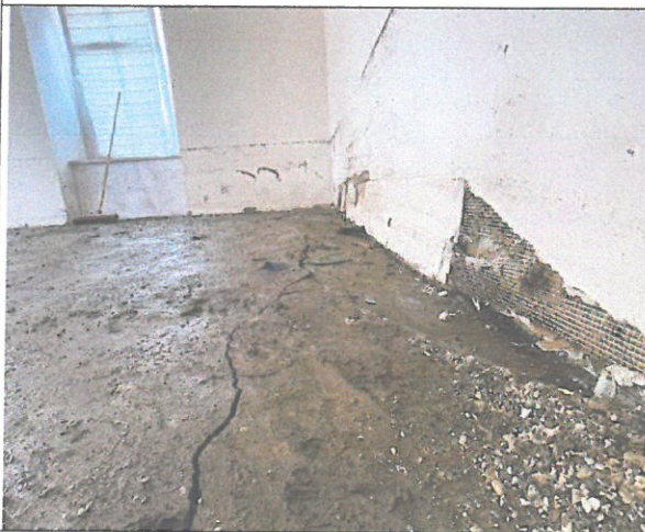
Fot. 19 Widok 2 uszkodzonej posadzki parteru. Posadzka betonowa spękana i uniesiona.
