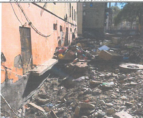
Fot. 6 Widok podmytego gruntu przy fundamencie od strony zachodniej
