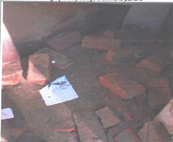
Fot. 11 Widok cegieł zawalonego sklepienia zalegające na posadzce piwnicy..
