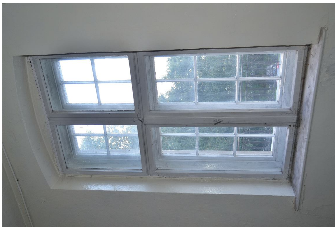
II. 28 Pławin, budynek dawnego dworu - okno TYP O/III – pierwotna stolarka okienna, rewers
