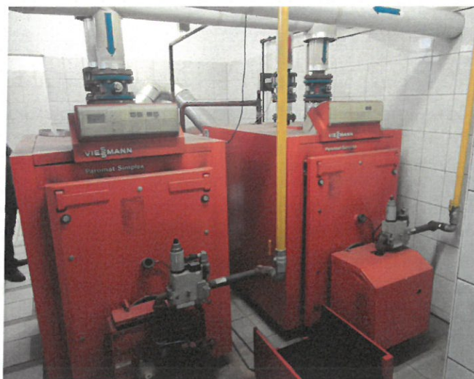
Fot. 1. Istniejące kotły firmy Viessmann.
