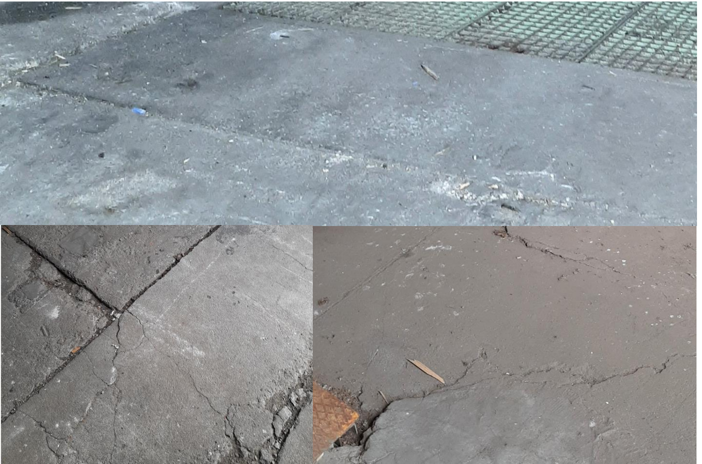
G. Widok uszkodzonej wylewki posadzki betonowej
