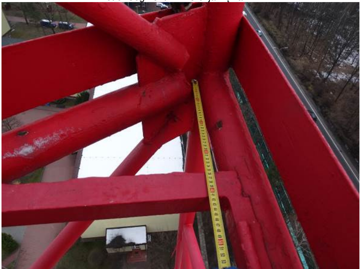
Fot.10 Podest H46,65m – brak blachy podestu
