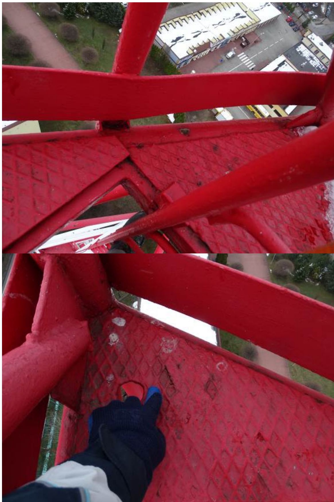
Fot.11-12 Podest H46,65m – korozja blach
