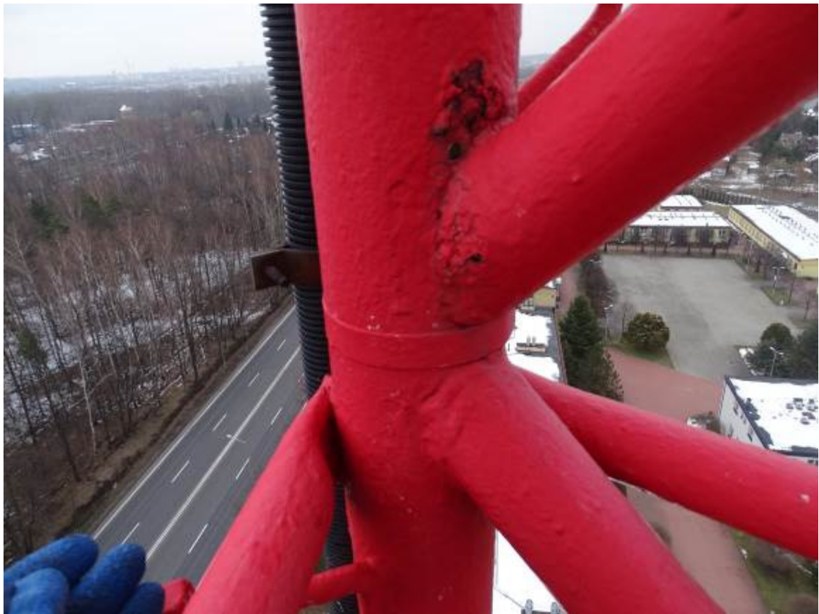
Fot.9 Segment 1 – korozja węzła
