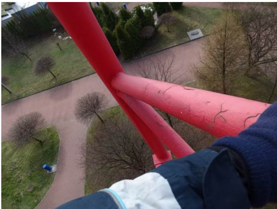
Fot.35 Segment 3 – pęknięcia powłoki malarskiej
