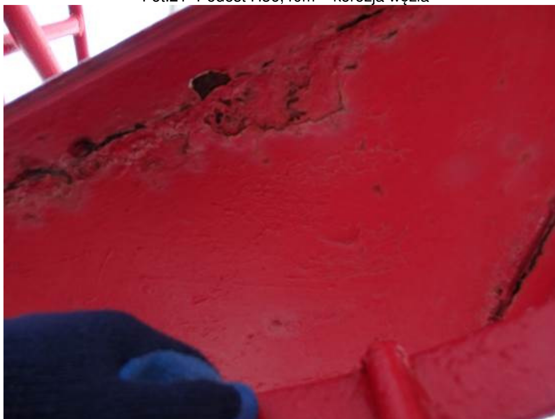
Fot.22 Podest H36,40m – korozja blach
