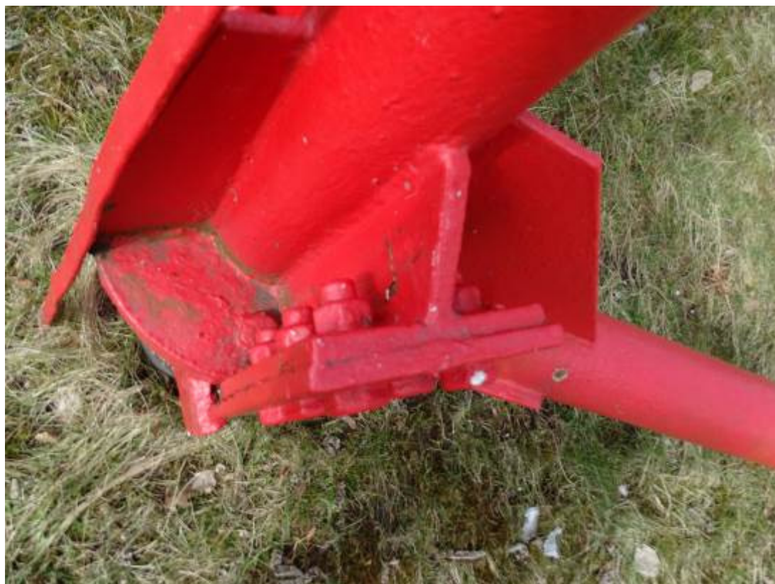
Fot.45 Segment 4 – korozja węzła
