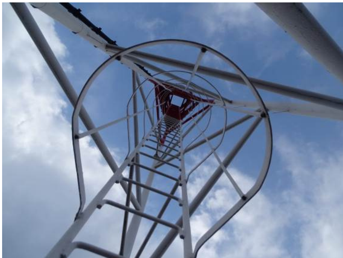
Fot.17 Korozja uchwytów rury osłonowej
