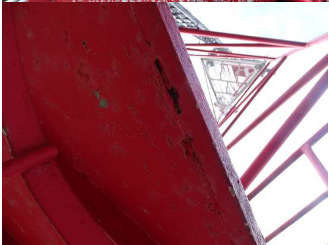
Fot.37-38 Podest H12,40m – korozja blach
