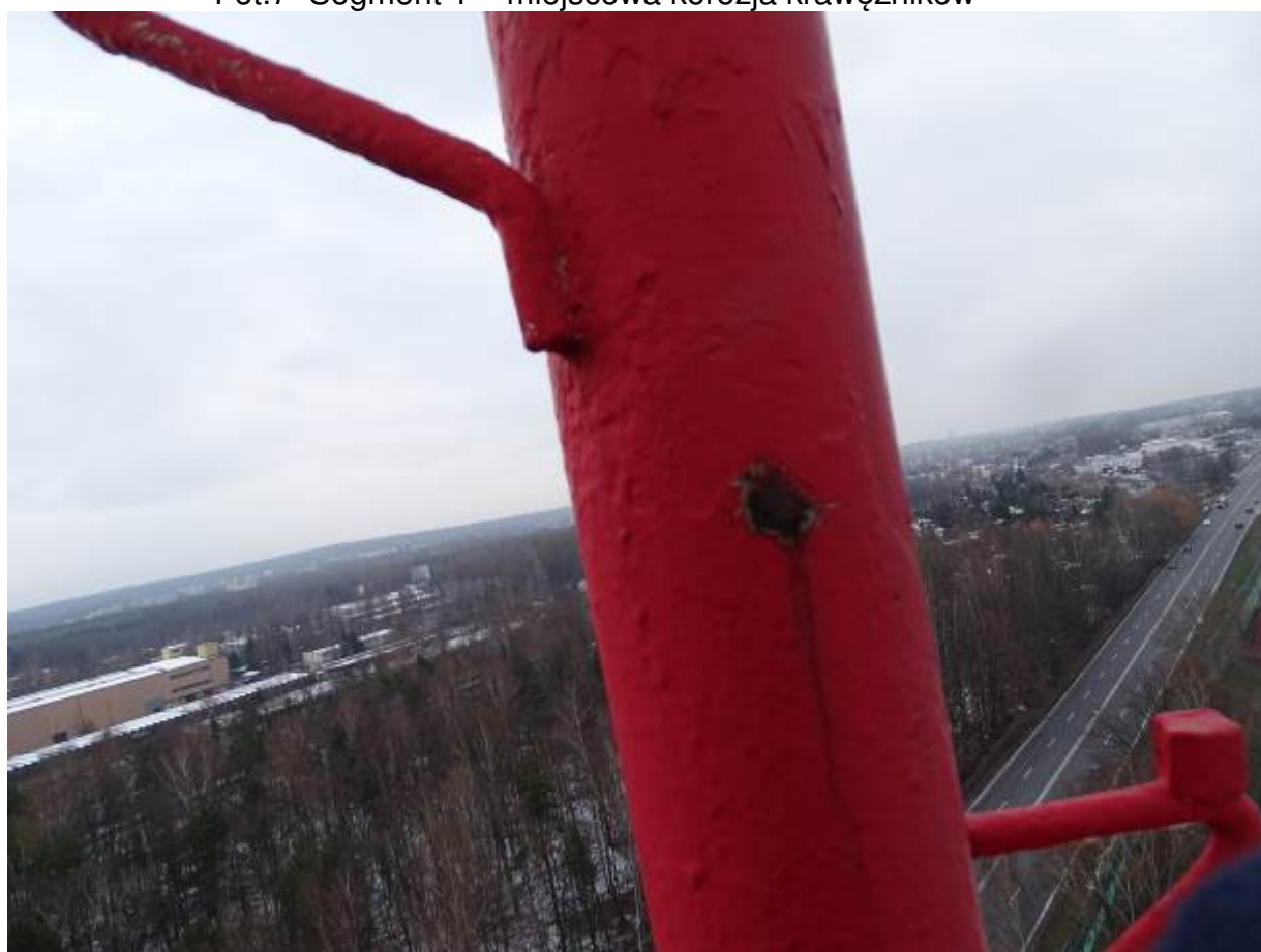
Fot.8 Segment 1 – miejscowa korozja krawężników
