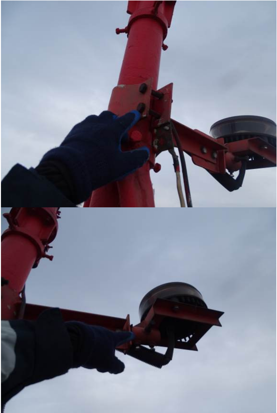
Fot.3-4 Konstrukcja wsporcza oświetlenia – korozja łączników
