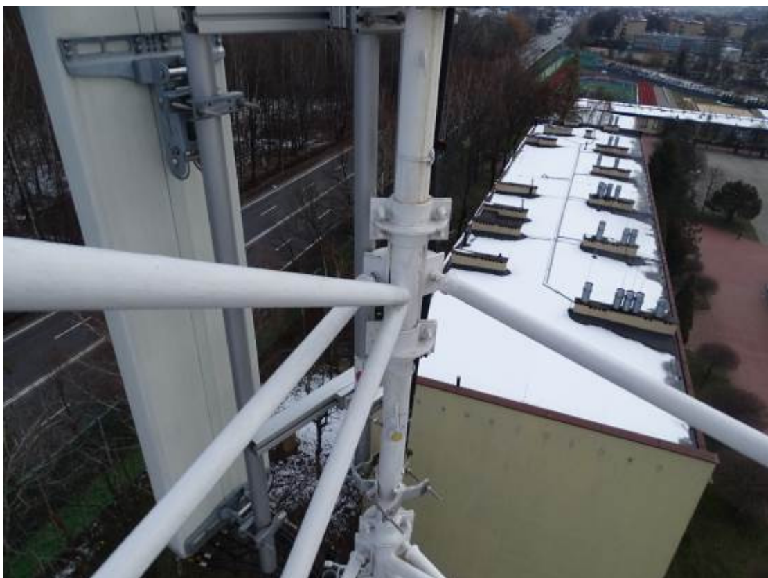
Fot.27 Segment 2 – konstrukcje wsporcze PLAY
