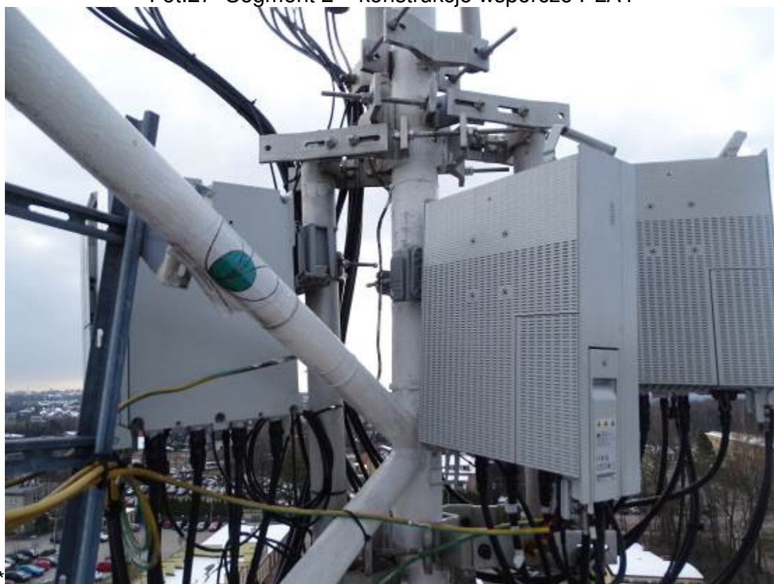
Fot.28 Segment 2 – konstrukcje wsporcze PLAY
