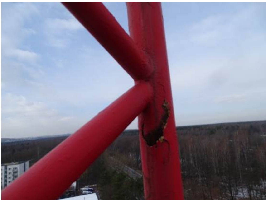
Fot.23 Segment 2 – miejscowa korozja krawężników
