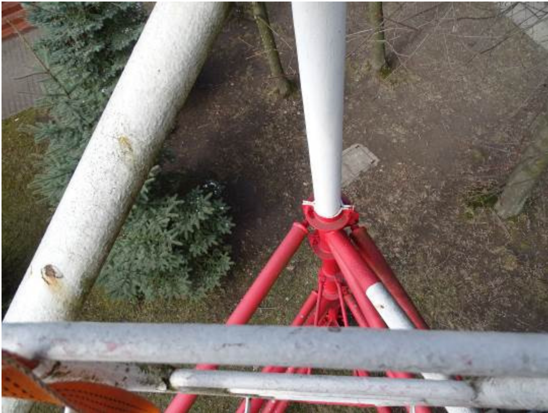
Fot.43 Segment 4 – miejscowa korozja krzyżulców
