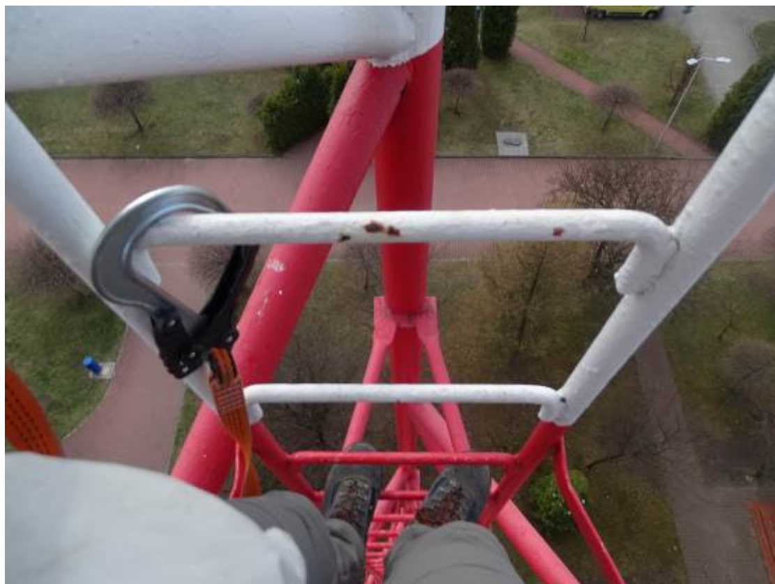
Fot.33 Segment 3 – miejscowa korozja drabiny
