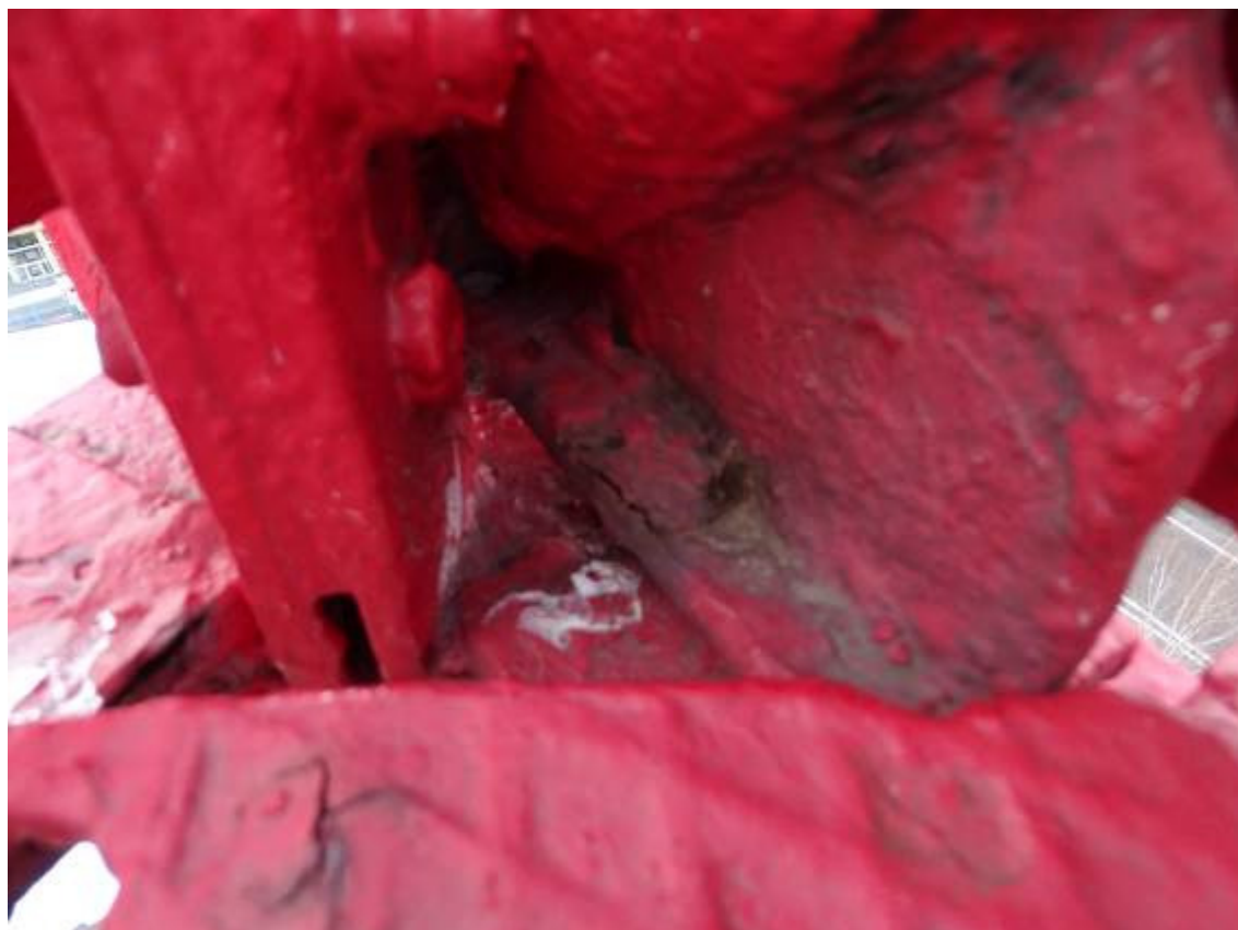
Fot.21 Podest H36,40m – korozja węzła
