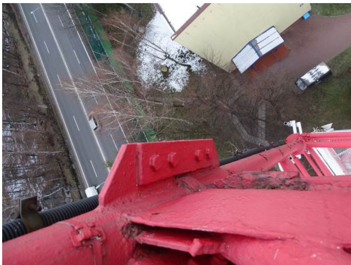
Fot.19 Segment 1 – korozja węzła
