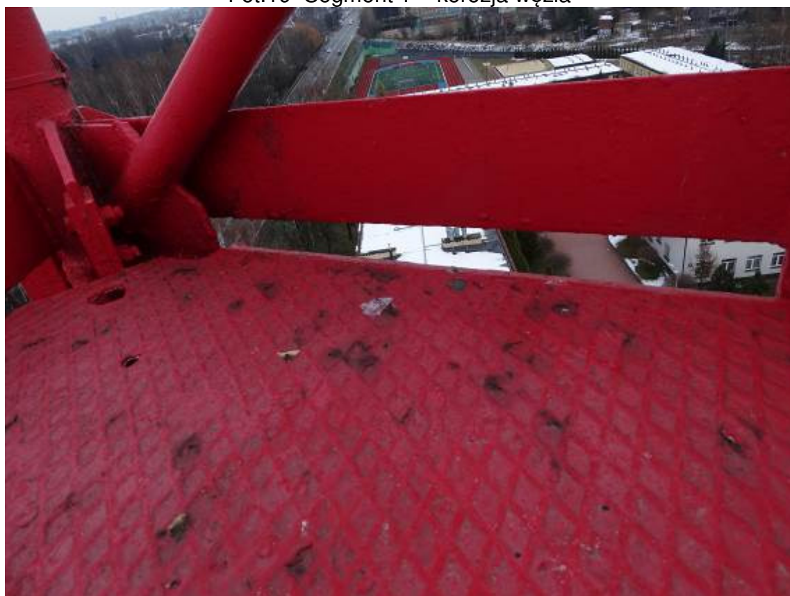
Fot.20 Podest H36,40m – korozja blach
