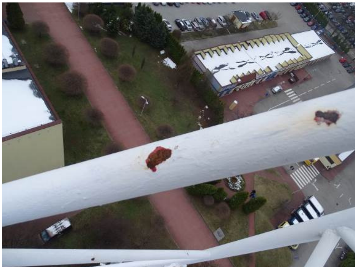
Fot.15 Segment 1 – miejscowa korozja krzyżulców
