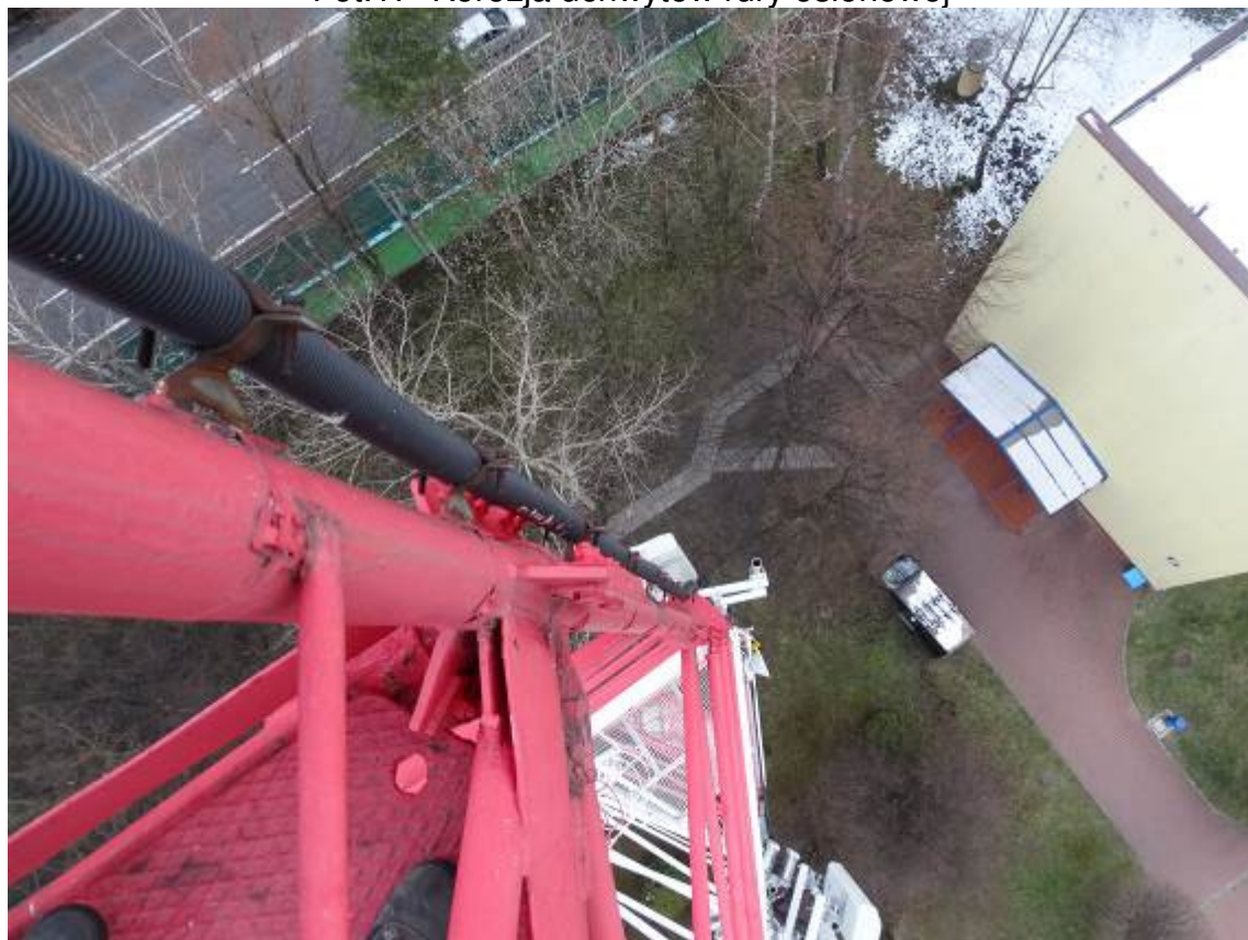
Fot.18 Korozja uchwytów rury osłonowej
