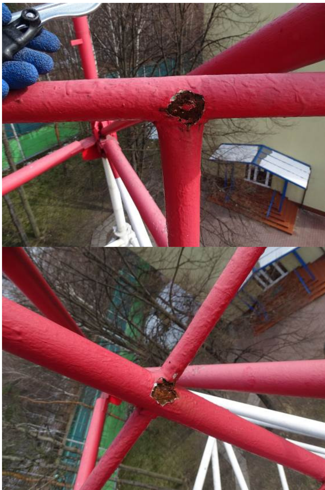
Fot.39-40 Podest H12,40m – korozja barierek
