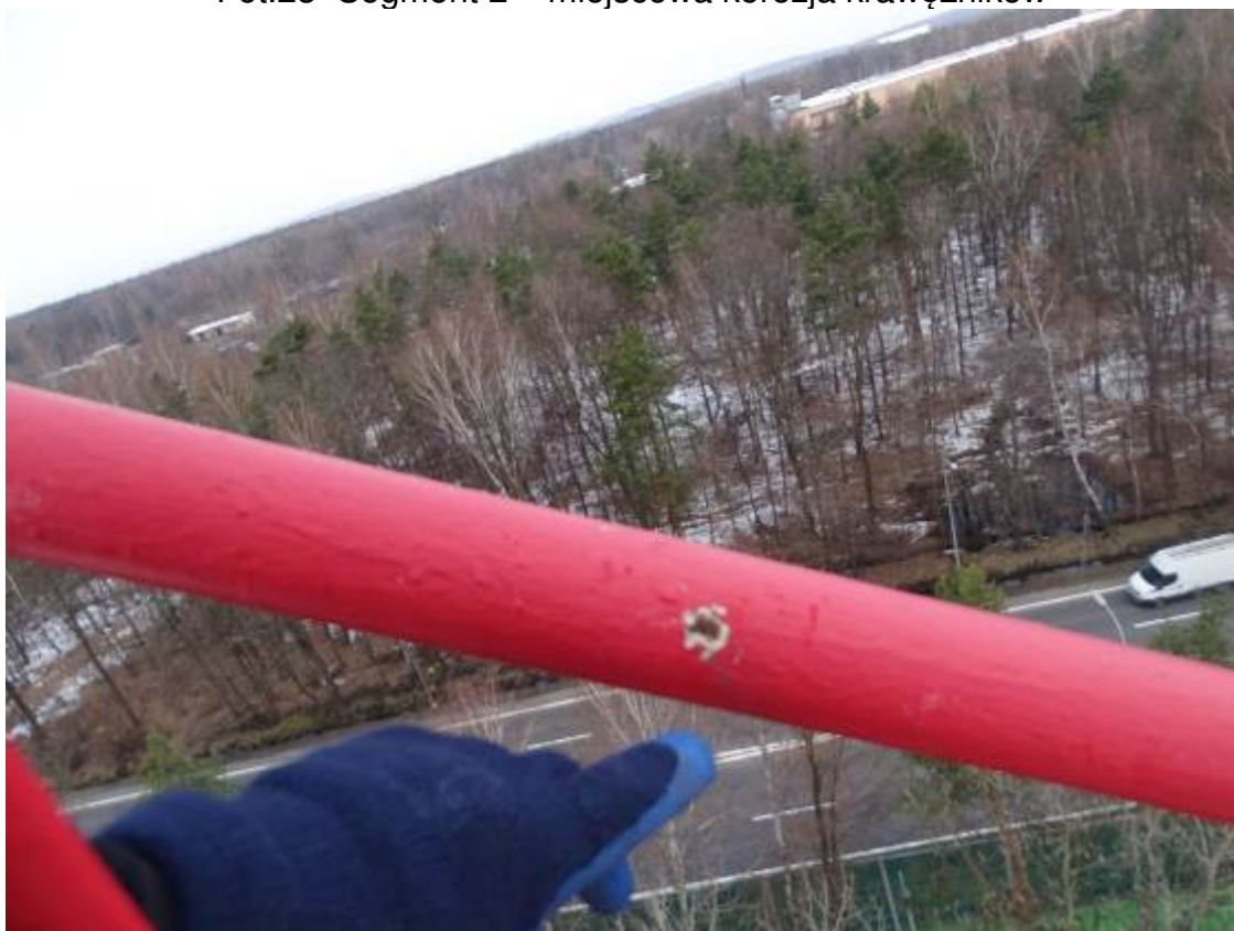
Fot.24 Segment 2 – miejscowa korozja krzyżulców
