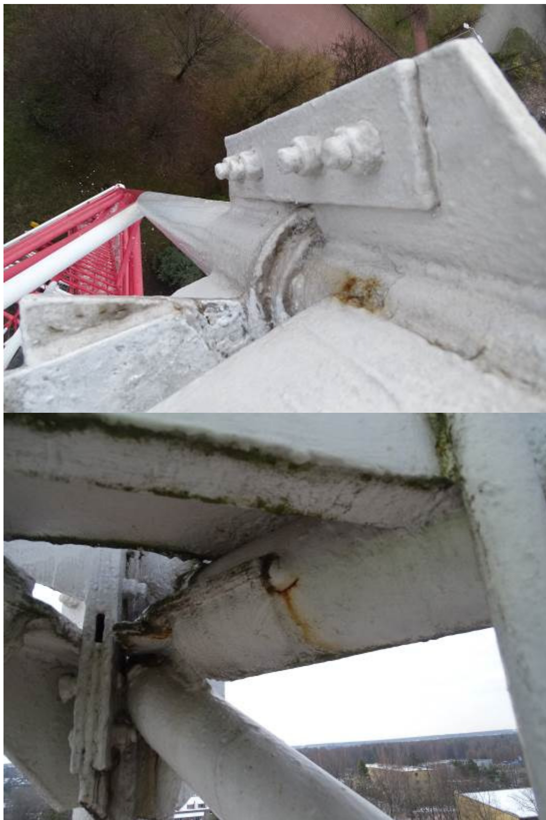
Fot.29-30 Segment 2 – korozja węzła
