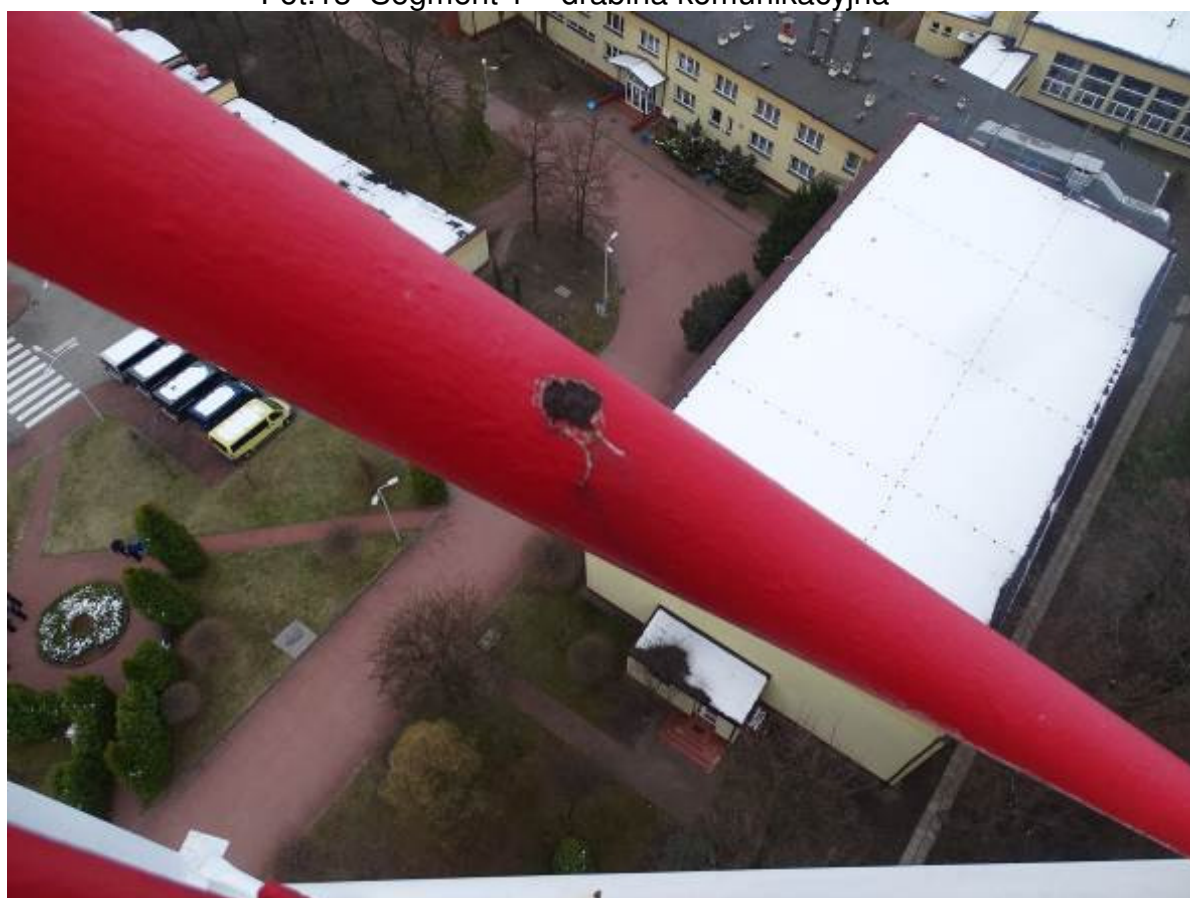
Fot.14 Segment 1 – miejscowa korozja krzyżulców
