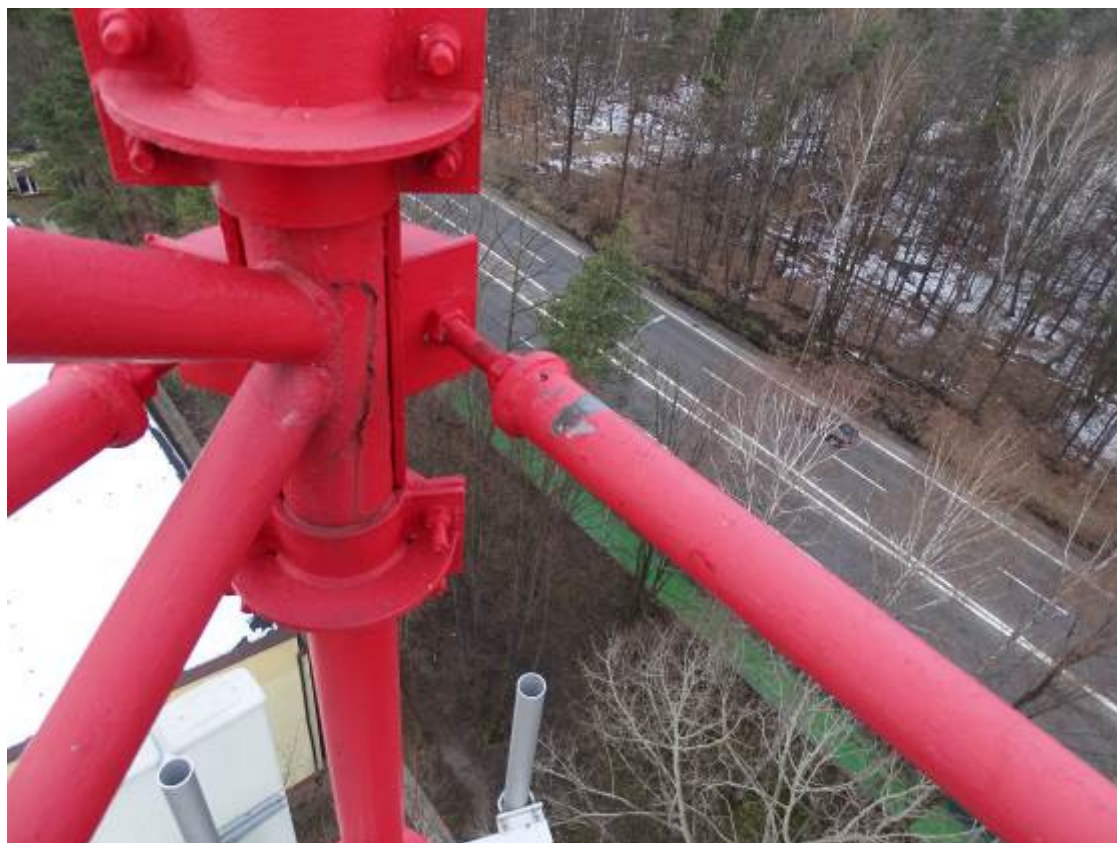
Fot.25 Segment 2 – odpryski farby na elementach wzmocnienia
