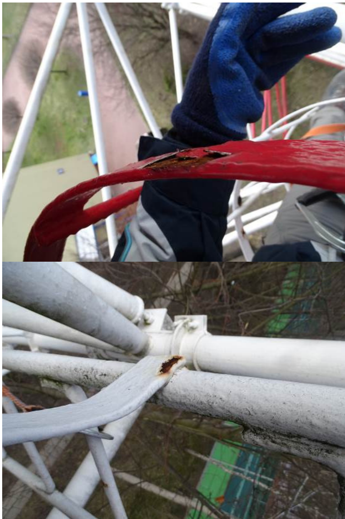
Fot.41-42 Segment 4 – korozja kosza ochronnego
