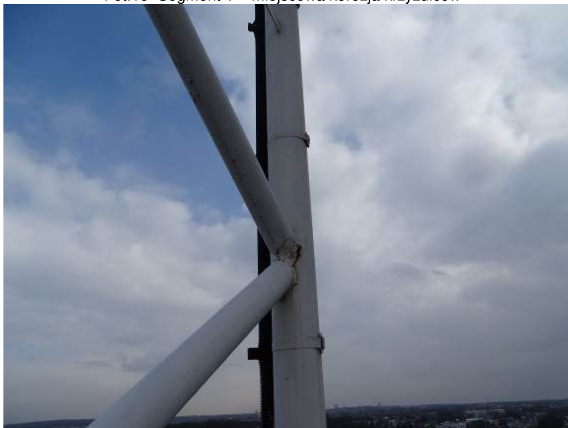
Fot.16 Segment 1 – korozja węzła
