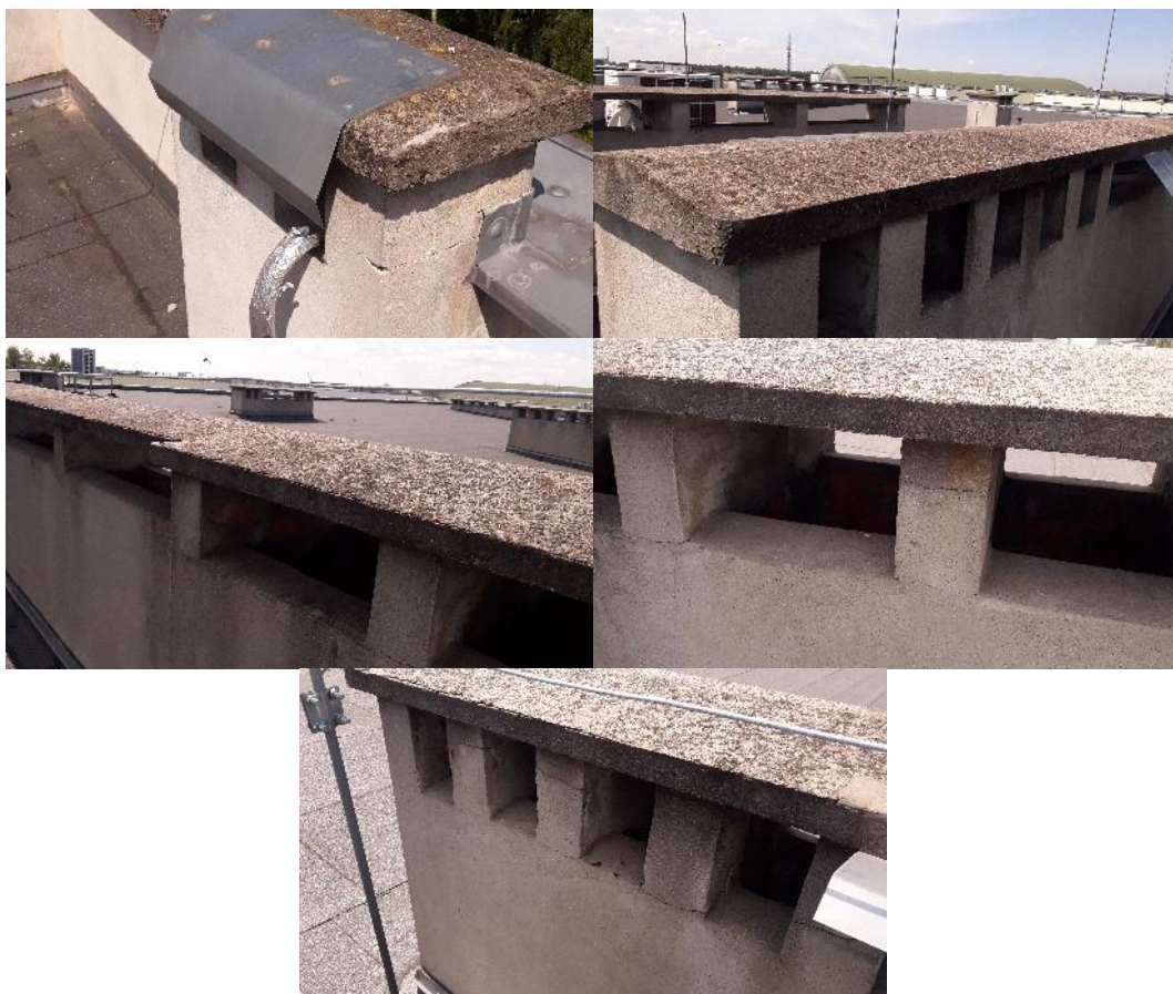
Zdjęcia przedstawiają zarysowania koron kominów wentylacyjnych jak również nieizolowanych czap kominowych na budynku szkoły skrzydło prawe.
