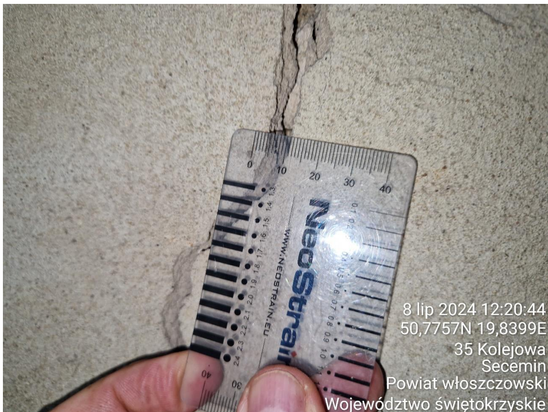
Fot. 7. Pomiar rozwartości pęknięć i rys.
