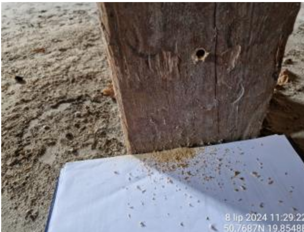
Fot.4. Widoczne drobne suche wióry bez próchnicy i murszu.
