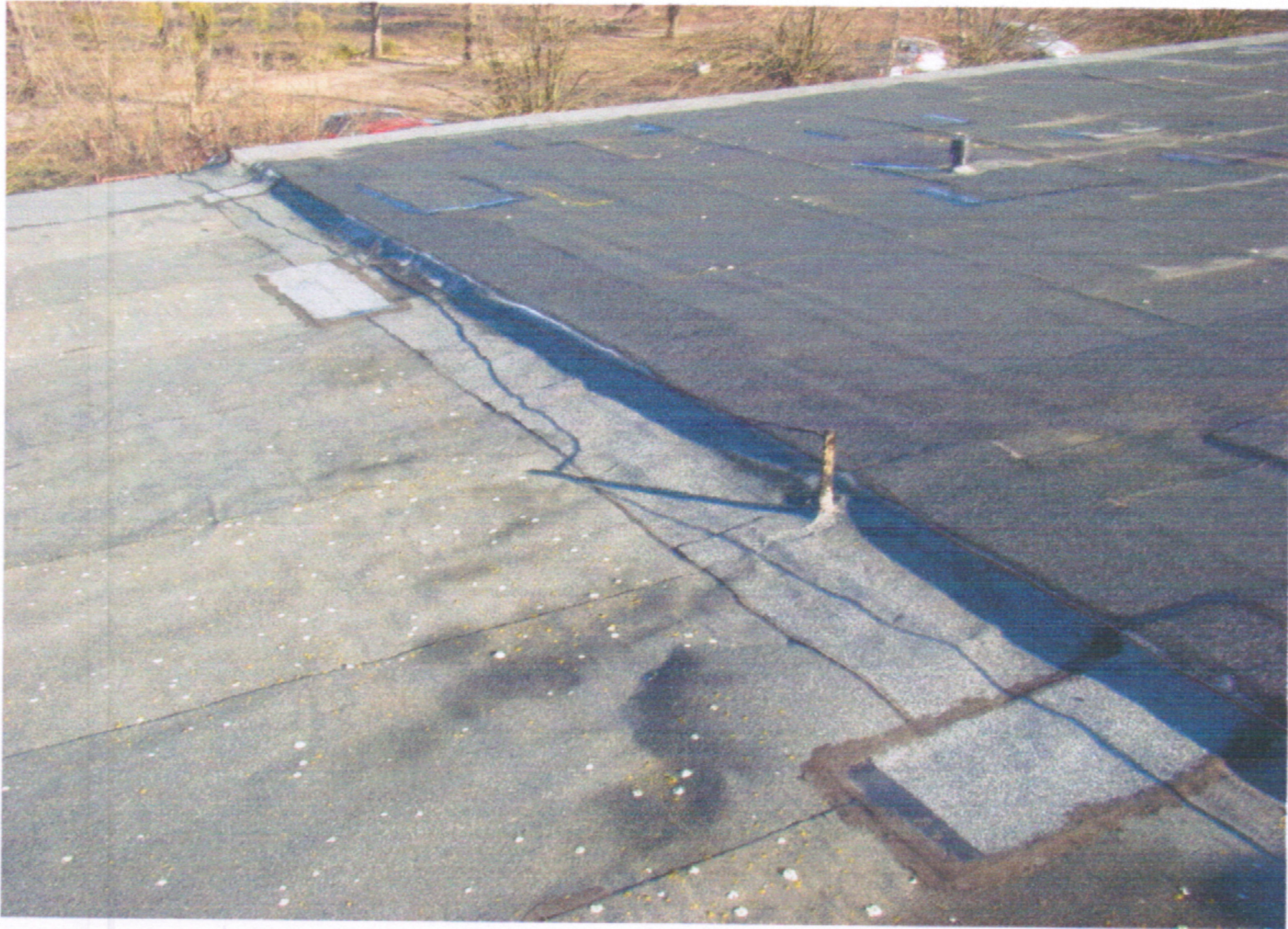
Widok dachu – pęcherze i zanieczyszczenia
