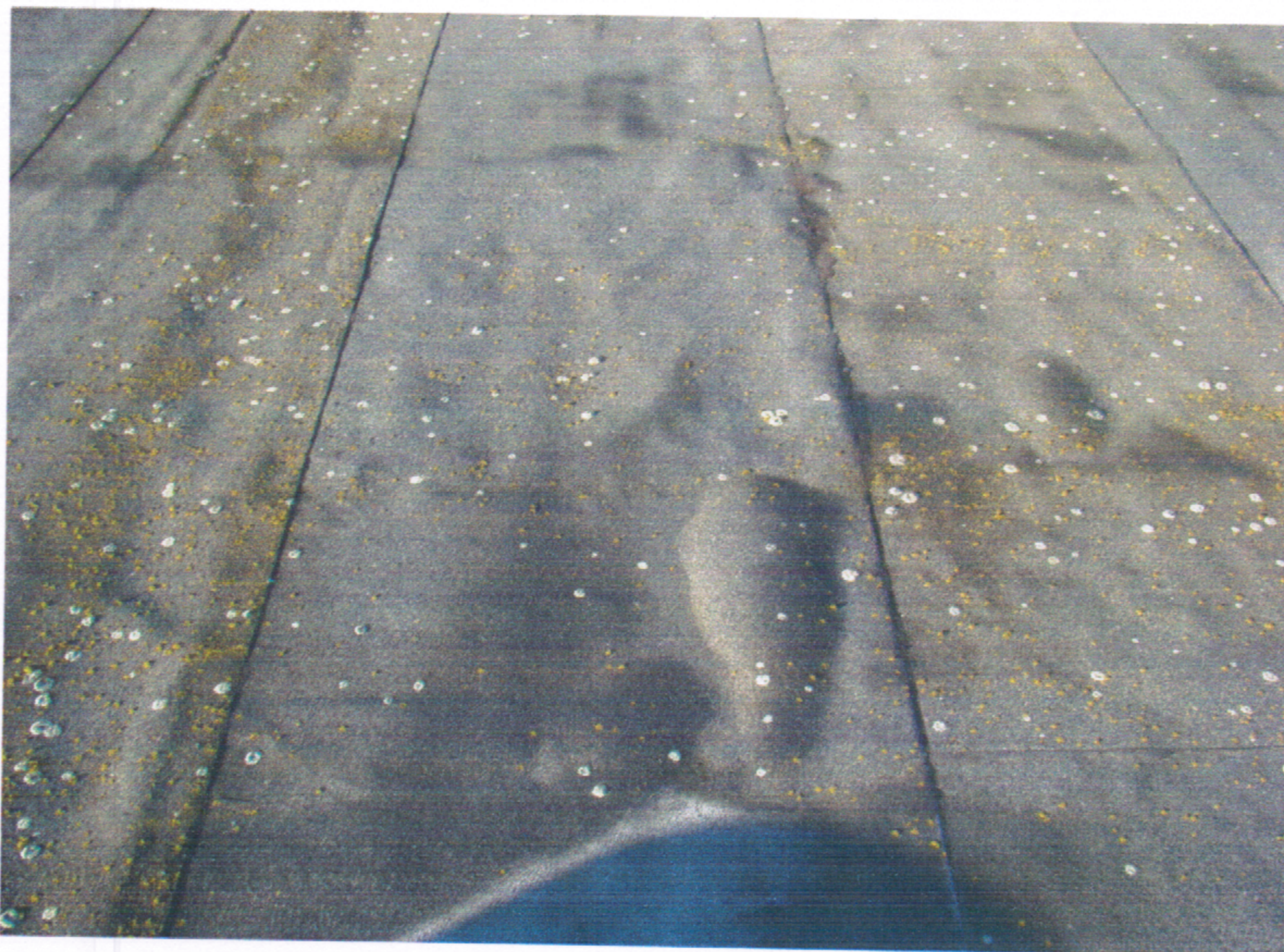
Widok pokrycia dachu – pęcherze i zanieczyszczenia
