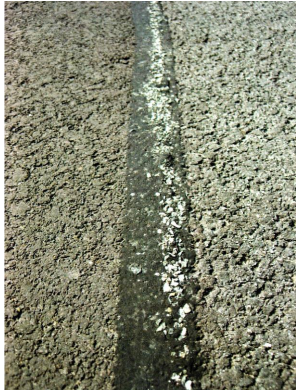
Rys. 4. Wykonanie złącza podłużnego metodą „gorące przy zimnym” bez zastosowania materiału uszczelniającego złącze, np. bez taśmy topliwej (Sposób niezalecany na drogach publicznych. Może być stosowany tylko wyjątkowo za zgodą Inżyniera, np. na krótkich odcinkach lub w warunkach specjalnych)
