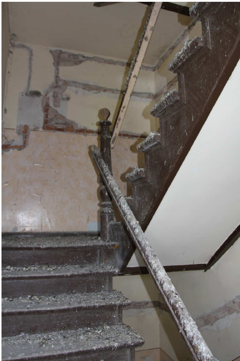
Fot. 37. Klatka schodowa budynków przy ul. Spichrzowej 21-23 w Grudziądzu (IV kondygnacja od zachodu, ulokowana w bryle budynku 23) (fot. Karolina Witkowska).
