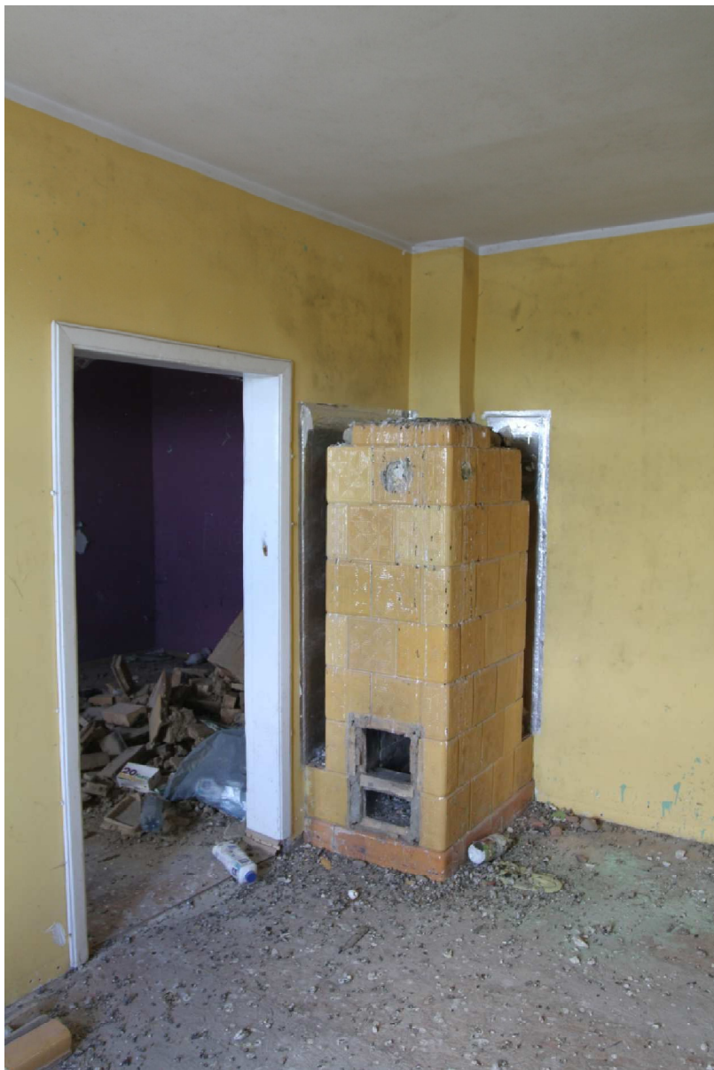
Fot. 41. Stan zachowania przykładowych pomieszczeń (fot. Karolina Witkowska).
