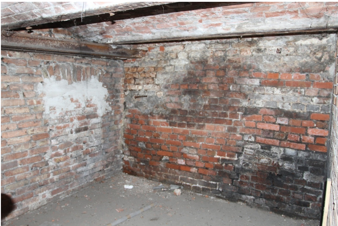
Fot. 34. Kapa pruska, zamurowany otwór drzwiowy, wtórny podciąg, piwnica budynku przy ul. Spichrzowej 23 w Grudziądzu (II kondygnacja od zachodu) (fot. Karolina Witkowska).
