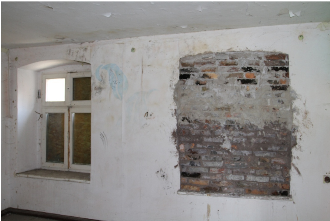
Fot. 45. Stan zachowania przykładowych pomieszczeń (fot. Karolina Witkowska).
