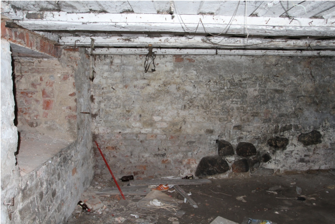
Fot. 27. Kamienie w dolnych partiach ścian, piwnica budynku przy ul. Spichrzowej 23 w Grudziądzu (I kondygnacja od zachodu) (fot. Karolina Witkowska).
