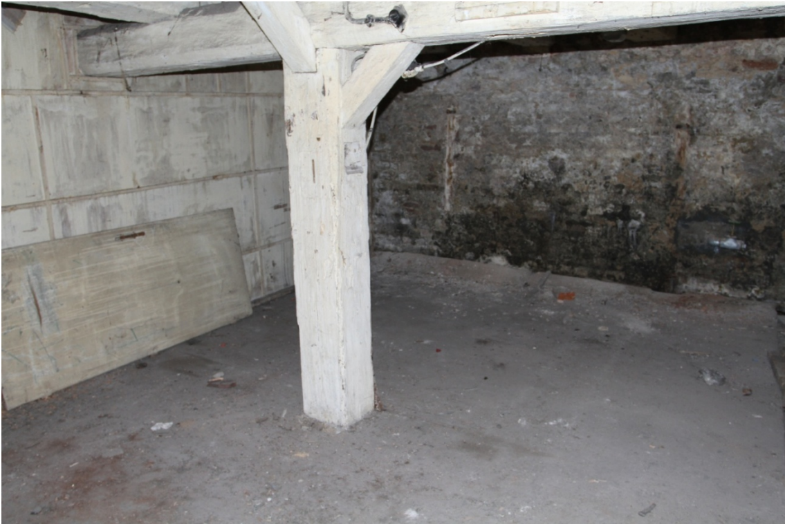
Fot. 19. Piwnica budynku przy ul. Spichrzowej 21 w Grudziądzu (II kondygnacja od zachodu) (fot. Karolina Witkowska).
