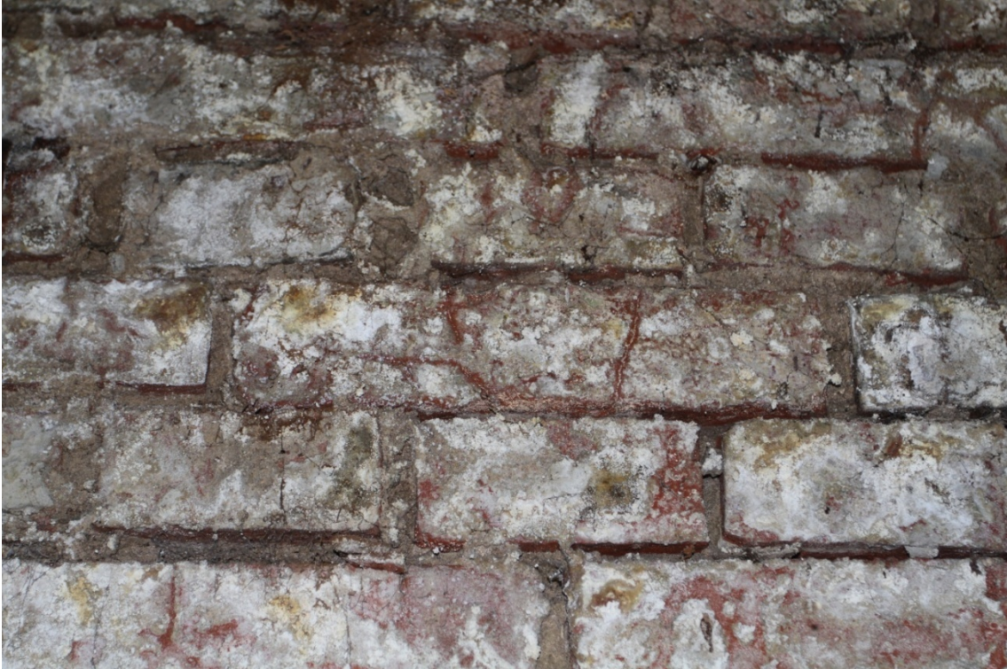
Fot. 25. Wysolenia na ścianie wschodniej, parter budynku przy ul. Spichrzowej 21 w Grudziądzu (III kondygnacja od zachodu) (fot. Karolina Witkowska).
