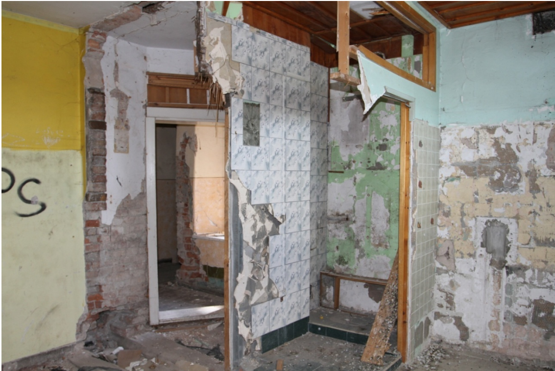
Fot. 44. Stan zachowania przykładowych pomieszczeń (fot. Karolina Witkowska).
