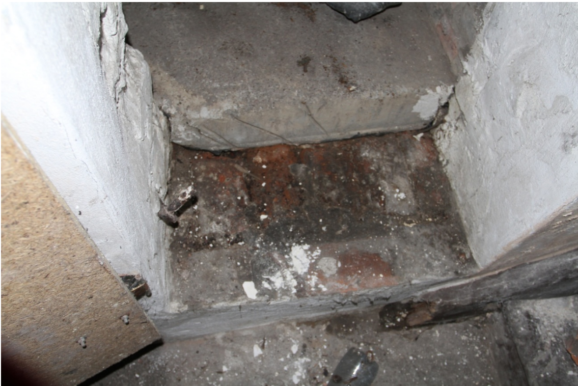
Fot. 26. Cegła pod wylewką betonową, piwnica budynku przy ul. Spichrzowej 23 w Grudziądzu (I kondygnacja od zachodu) (fot. Karolina Witkowska).
