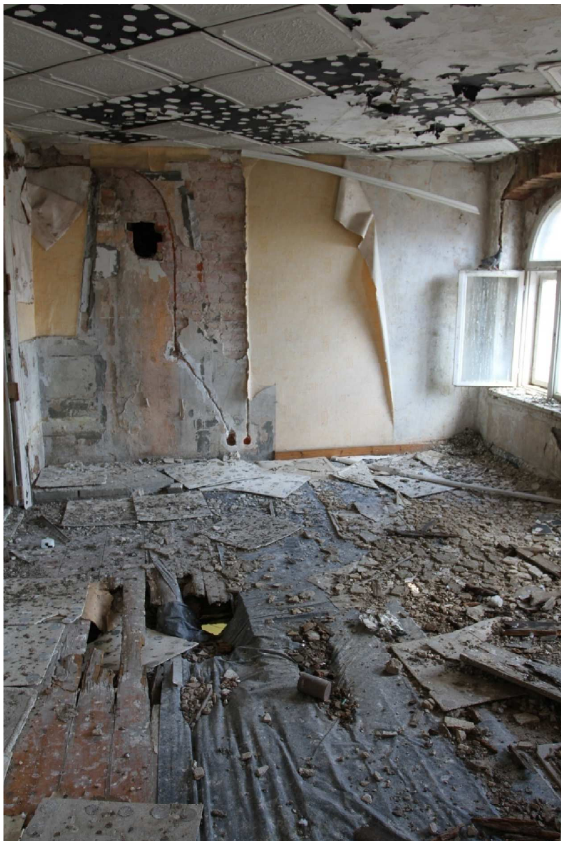
Fot. 46. Stan zachowania przykładowych pomieszczeń (fot. Karolina Witkowska).
