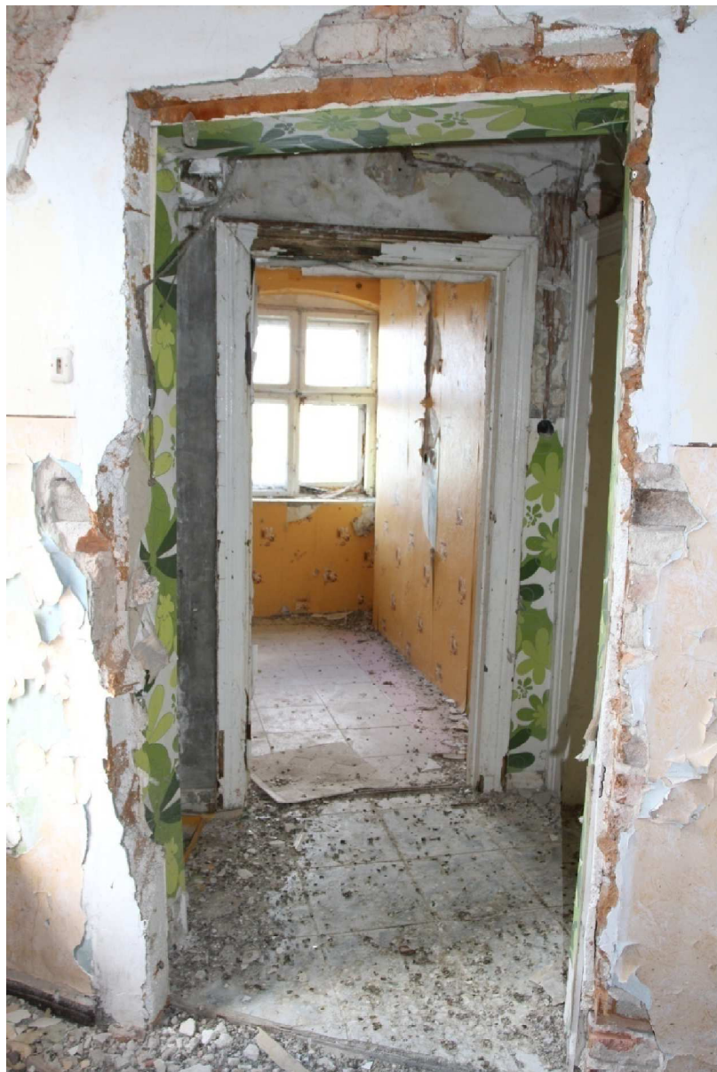
Fot. 43. Stan zachowania przykładowych pomieszczeń (fot. Karolina Witkowska).
