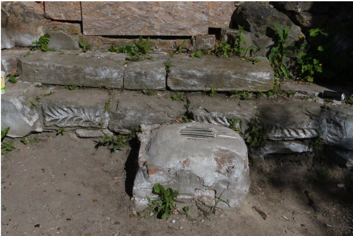
Fot. 15. Schody z piaskowca, elewacja zachodnia budynku przy ul. Spichrzowej 21 w Grudziądzu (fot. Karolina Witkowska).
