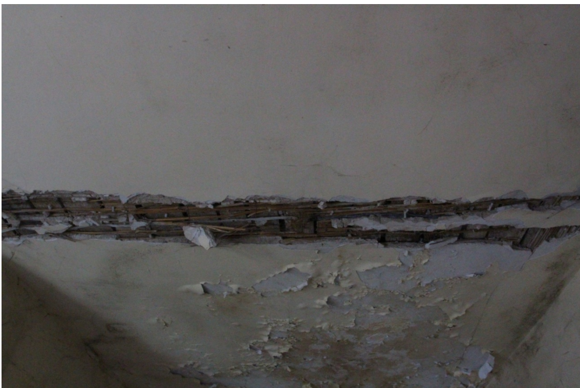
Fot. 39. Podsufitka w klatce schodowej budynków przy ul. Spichrzowej 21-23 w Grudziądzu (V kondygnacja od zachodu, ulokowana w bryle budynku 23) (fot. Karolina Witkowska).
