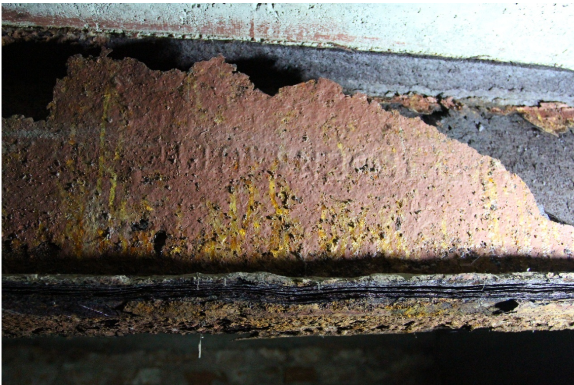
Fot. 32. Korodujące wzmocnienia wtórnych stropów, piwnica budynku przy ul. Spichrzowej 23 w Grudziądzu (I kondygnacja od zachodu) (fot. Karolina Witkowska).
