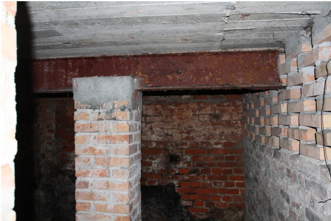
Fot. 31. Korodujące wzmocnienia wtórnych stropów, piwnica budynku przy ul. Spichrzowej 23 w Grudziądzu (I kondygnacja od zachodu) (fot. Karolina Witkowska).
