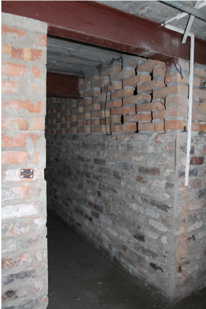
Fot. 29. Wtórne ścianki i podciągi, piwnica budynku przy ul. Spichrzowej 23 w Grudziądzu (I kondygnacja od zachodu) (fot. Karolina Witkowska).
