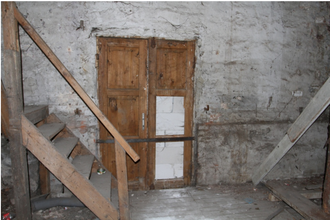
Fot. 17. Piwnica budynku przy ul. Spichrzowej 21 w Grudziądzu (I kondygnacja od zachodu) (fot. Karolina Witkowska).
