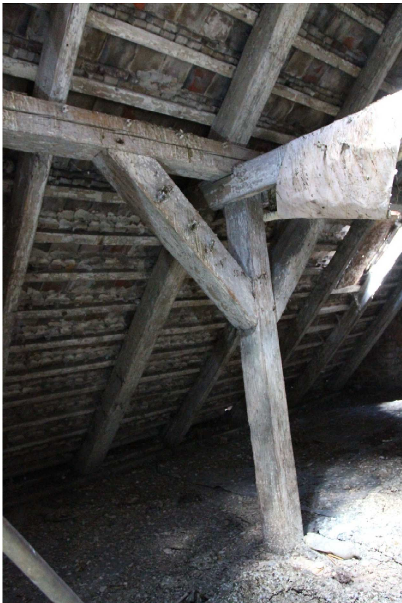
Fot. 47. Poddasze z nieszczelnym dachem (fot. Karolina Witkowska).
