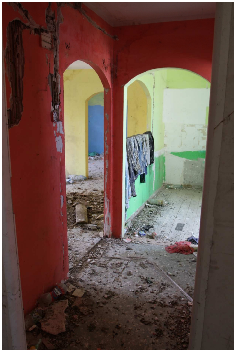
Fot. 42. Stan zachowania przykładowych pomieszczeń (fot. Karolina Witkowska).
