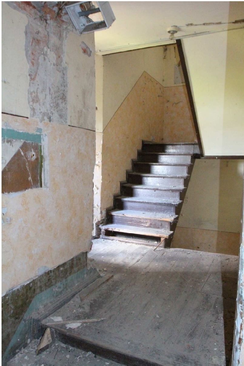
Fot. 36. Klatka schodowa budynków przy ul. Spichrzowej 21-23 w Grudziądzu (III kondygnacja od zachodu, ulokowana w bryle budynku 23) (fot. Karolina Witkowska).
