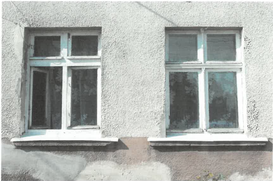
Okna na parterze elewacji frontowej. Z lewej strony wtórne, a z prawej oryginalne.
