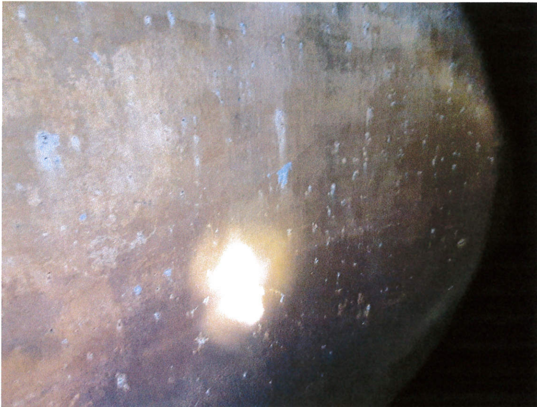
Zdjęcie 9. Ściana zewnętrzna – widoczne drobne ślady przecieków
