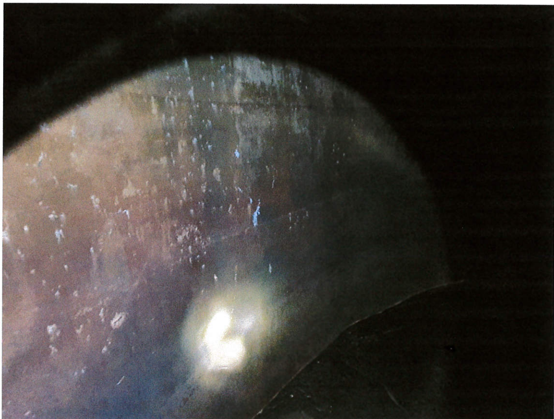
Zdjęcie 12. Ściana zewnętrzna – widoczne drobne ślady przecieków
