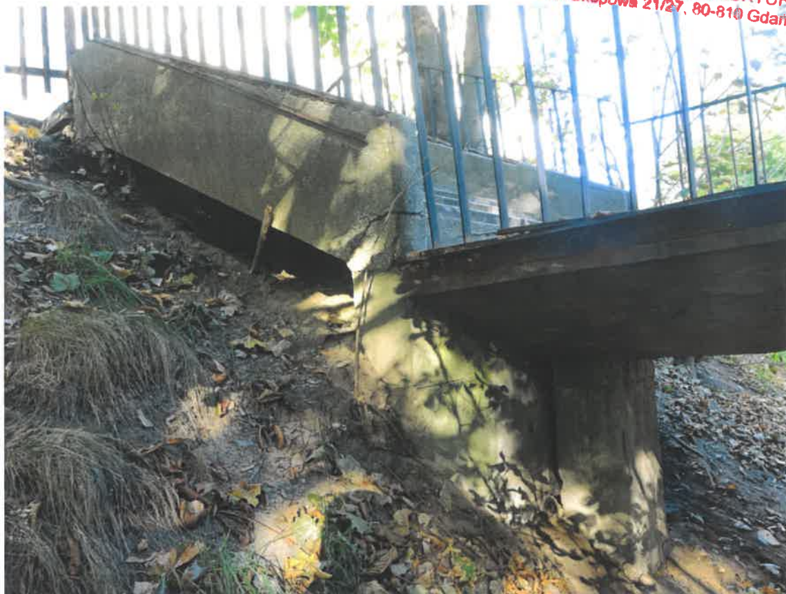
Fot. 16 Widok na górną część schodów. Widoczne spękania belki policykowej, ubytki w skarpie
