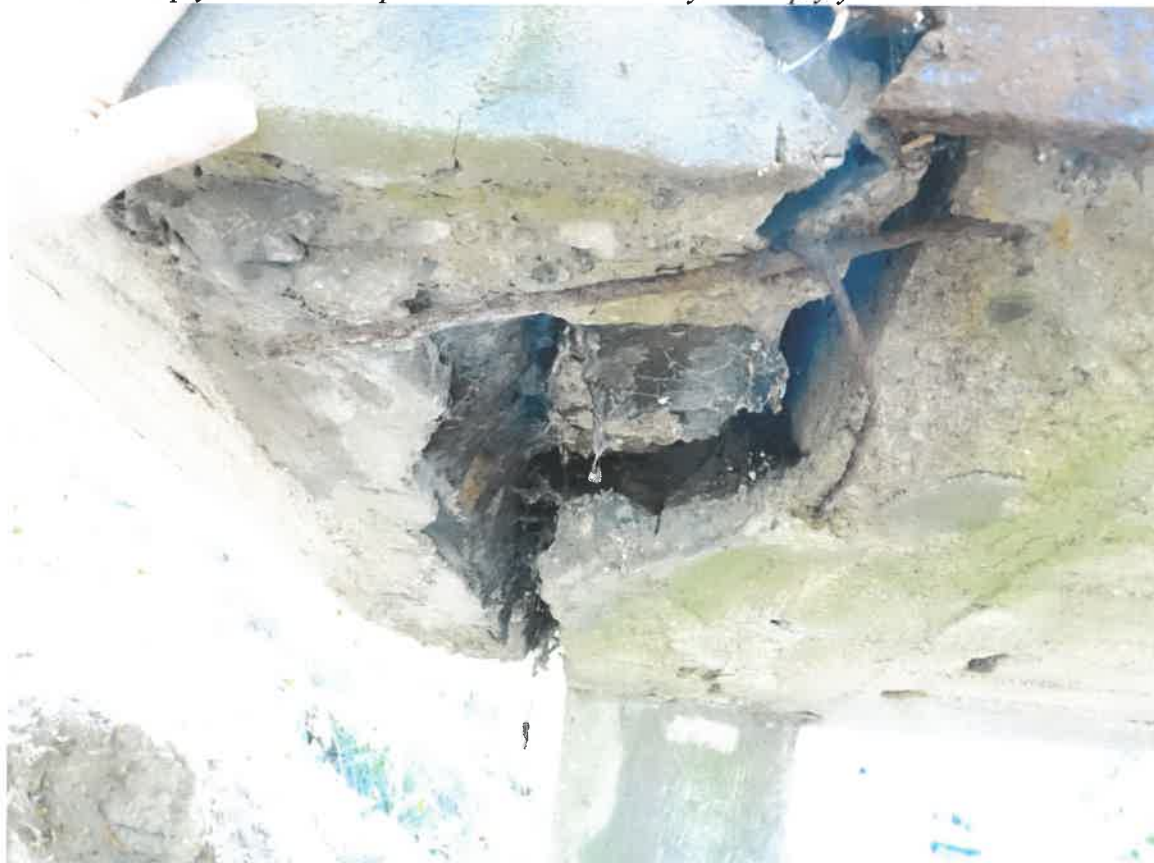
Fot. 12 Stan przegubu kładka /schody. Widoczne znaczne ubytki betonu i mocno skorodowane zbrojenie
