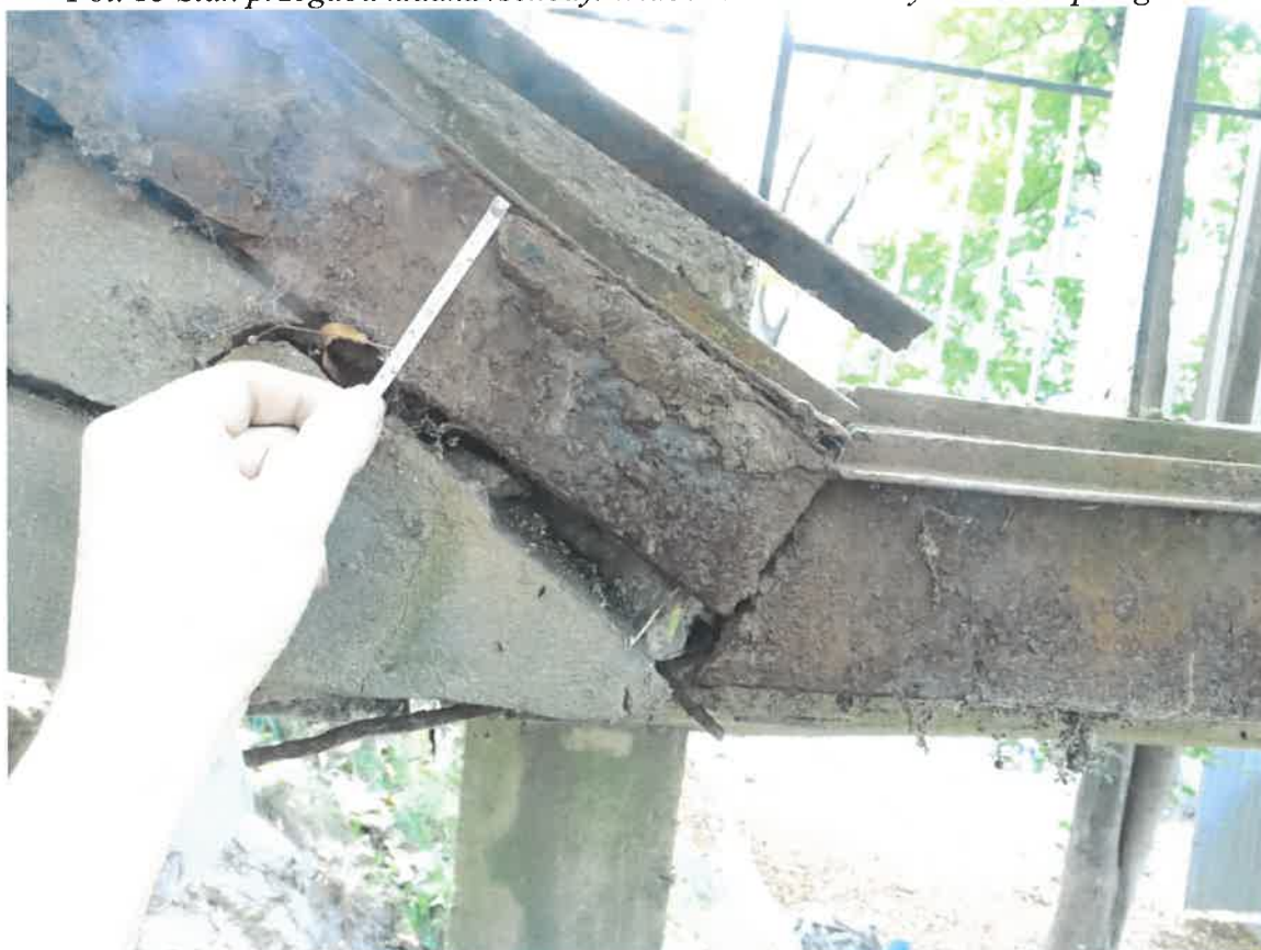
Fot. 14 Widok na przegub kładka/schody. Widoczne mocno skorodowane okucie stalowe krawędzi kładki
