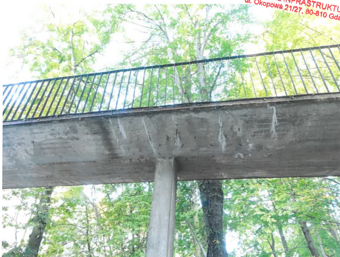
Fot. 11 Widok na płytę kładki od spodu. Widoczne solne wycieki z płyty oraz skorodowane zbrojenie
