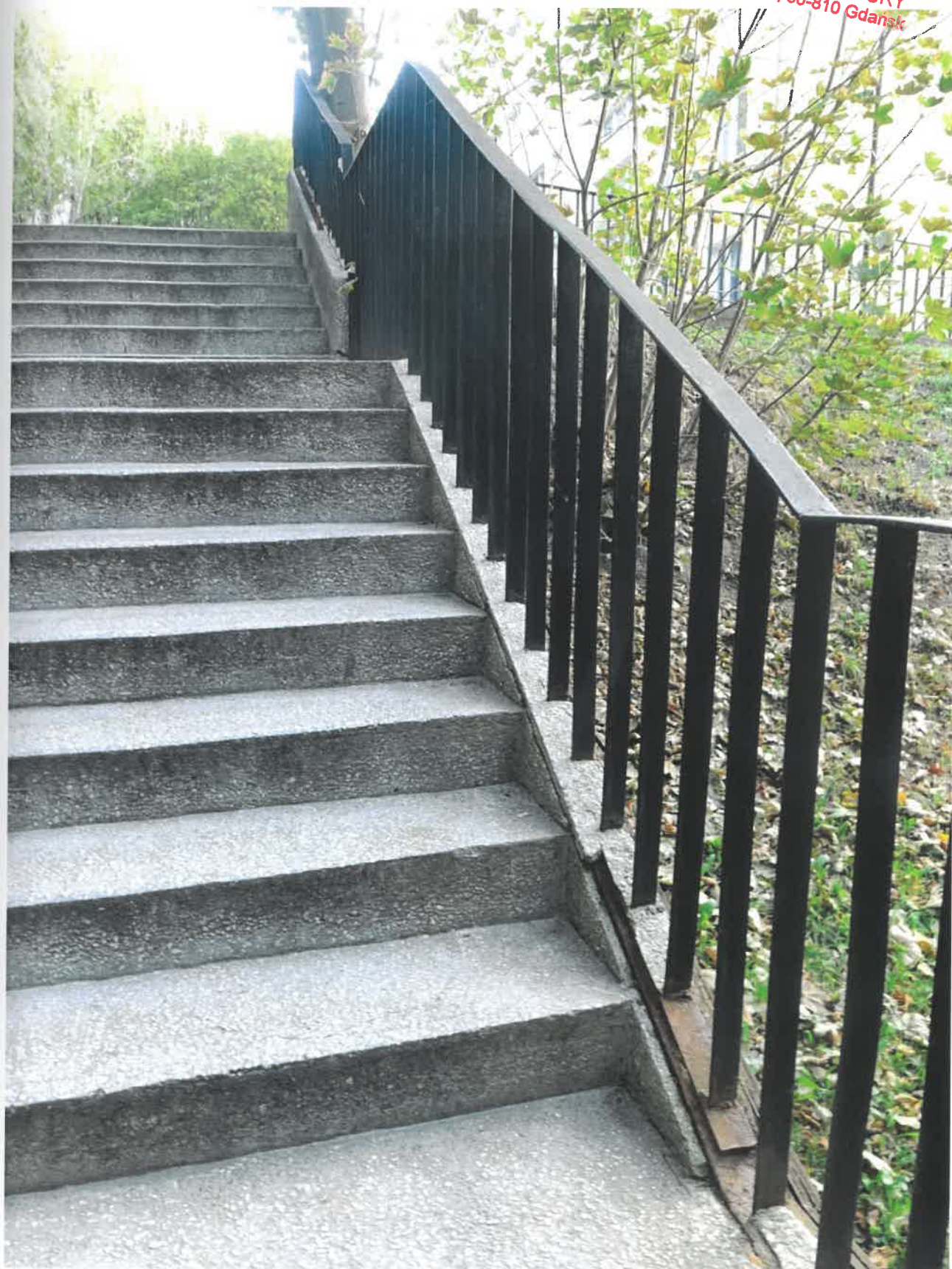
Fot. 4 Widok na schody Widoczne skorodowane zamocowanie balustrady do schodów oraz ubytki betonu belki policzkowej schodów
