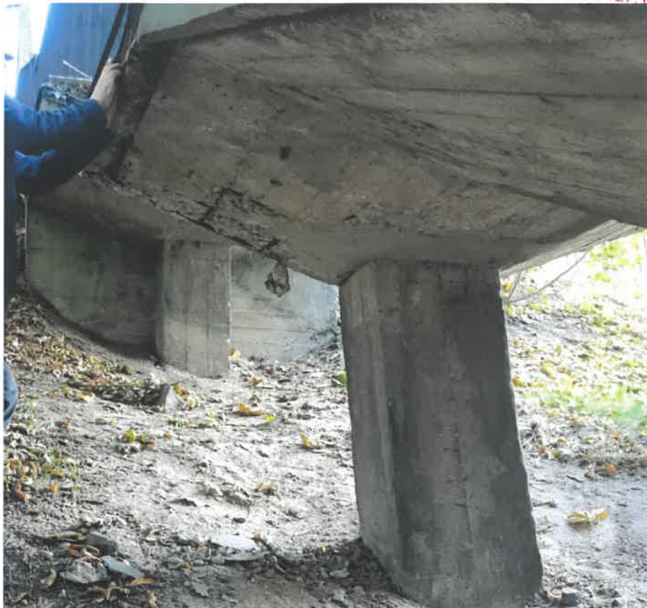
Fot. 15 Widok na schody od spodu. Widoczne odsłonięte i skorodowane zbrojenie płyty schodów.
