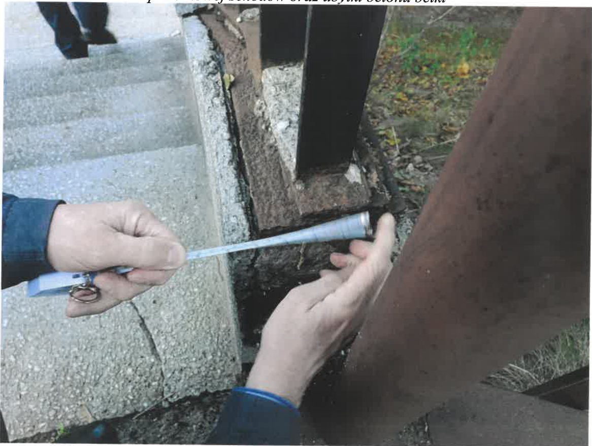
Fot. 6 Skorodowana balustrada na schodach zamocowana do okucia krawędzi schodów
