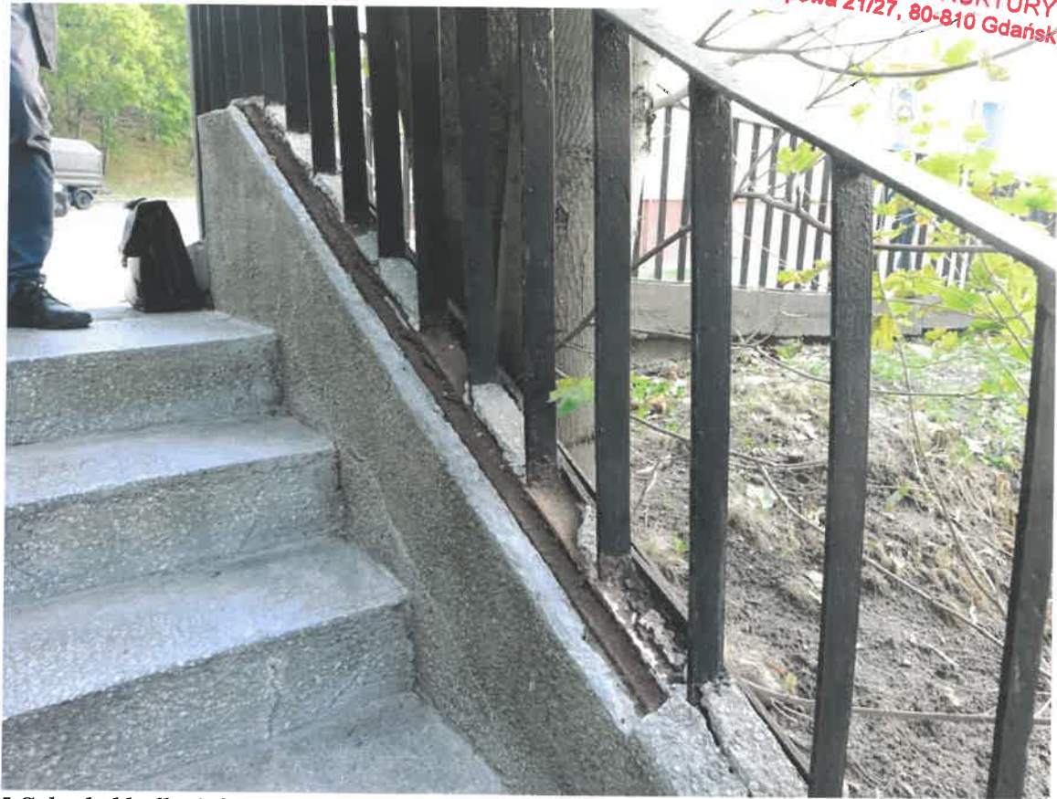
Fot. 5 Schody kładki (górny bieg). Widoczne mocno skorodowane zamocowanie balustrady do belki policzkowej schodów oraz ubytki betonu belki
