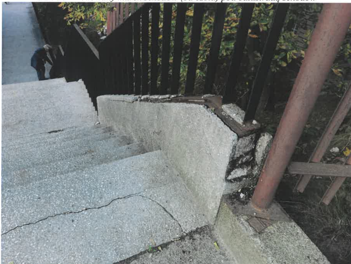
Fot. 8 Schody wejściowe. Widoczne ubytki betonu belki schodów, spękane lastryko na stopniach
