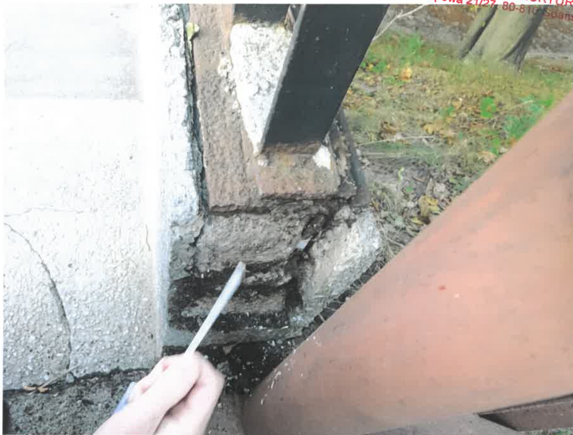
Fot. 7 Skorodowany murek schodów (od czola) pod balustradą schodów
