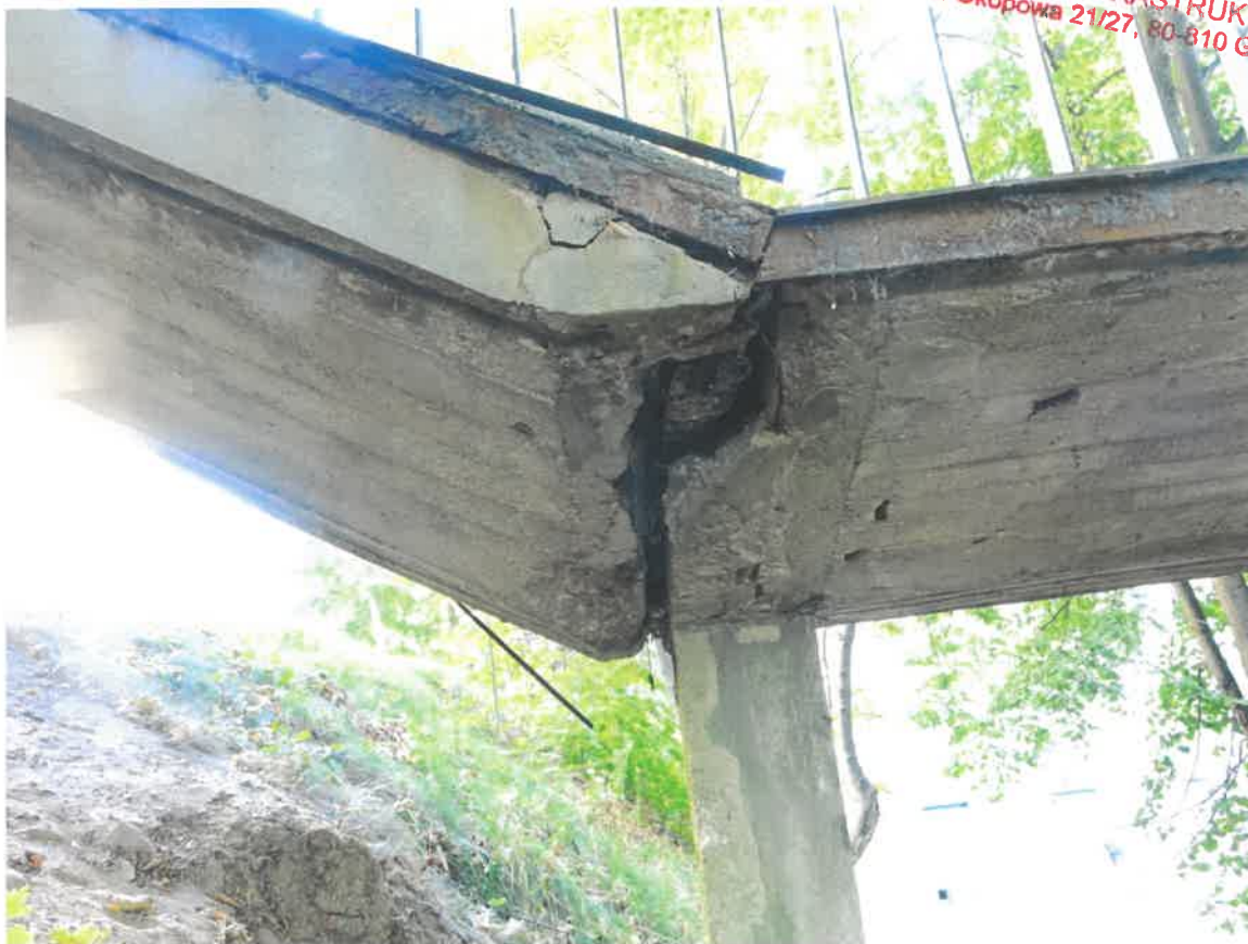
Fot. 13 Stan przegubu kładka /schody. Widoczne znaczne ubytki betonu przegubu
