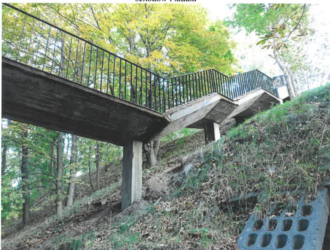
Fot. 10 Widok na kładkę i schody. Widoczne mocno skorodowane okucie stalowe krawędzi kładki
