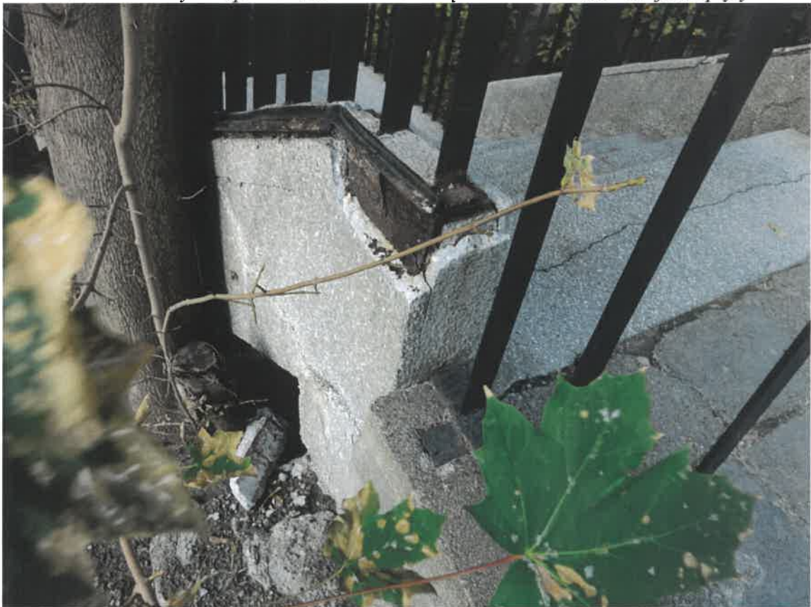
Fot. 16 Przyczółek schodów wejściowych na kładkę. Widoczne skorodowane zamocowanie balustrady, ubytki beton, spękanie lastryko.
