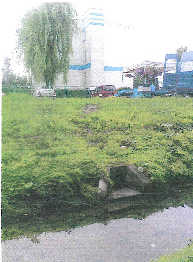
Wylot kanalizacji deszczowej z terenu Ośrodka do Potoku Północnego w km 0+378. W głębi widoczna północna ściana szczytowa budynku Ośrodka (z windą).
