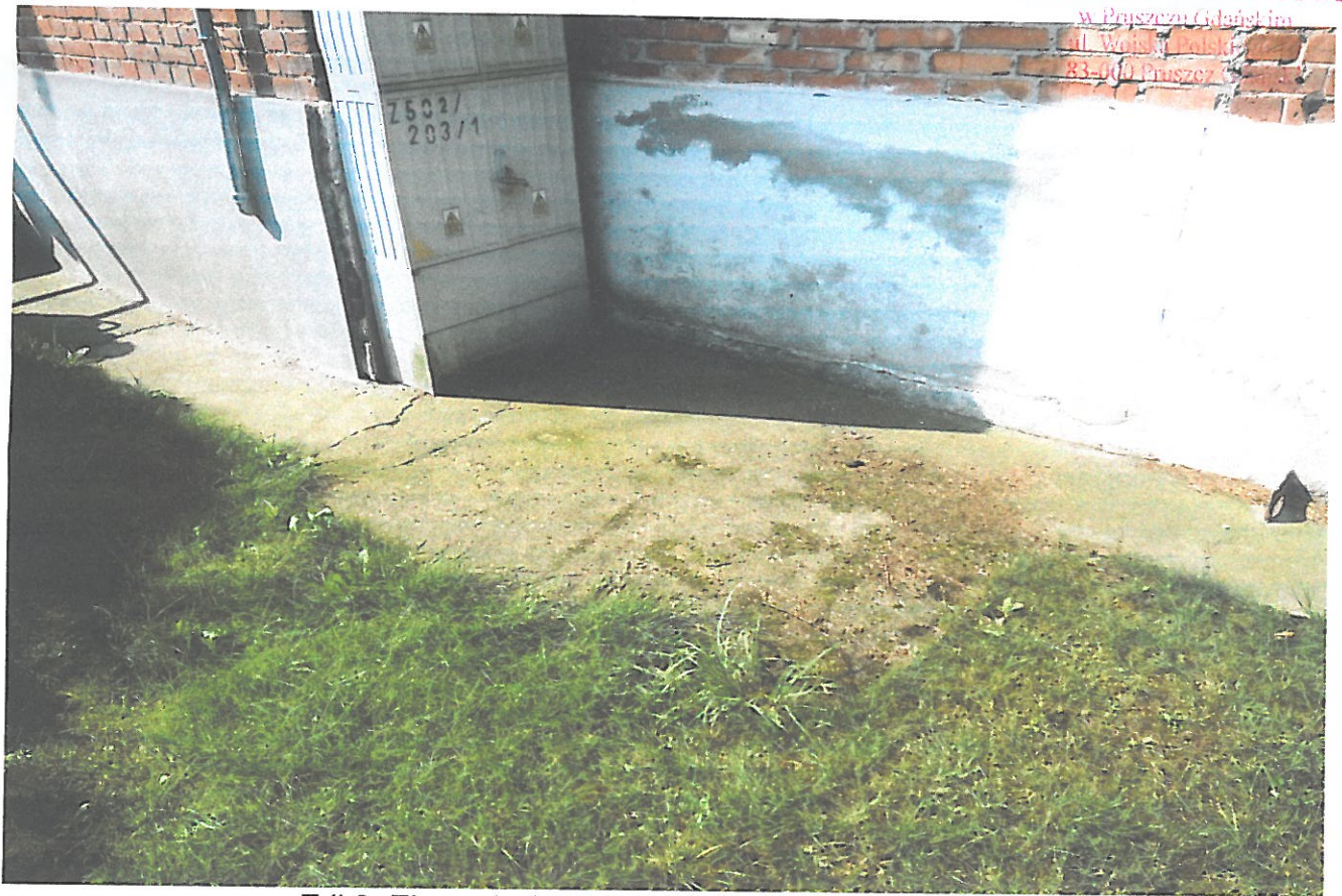
Zdj.9. Elewacja frontowa – przyłącze energetyczne
