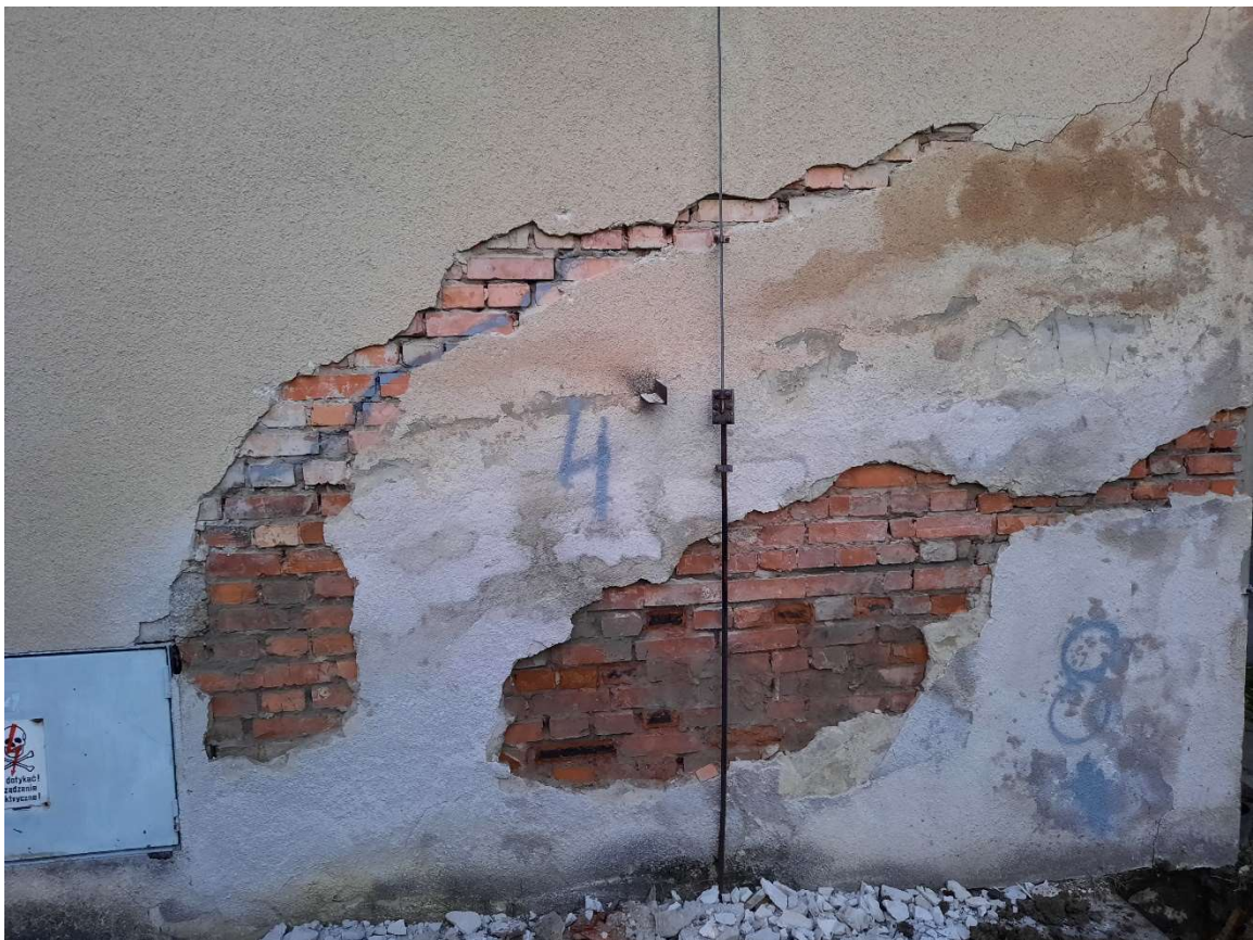
Rysunek 510. Odkrywka 4 - Uszkodzenie narożnika ściany zewnętrznej w osi 1-A (od zewnątrz).
