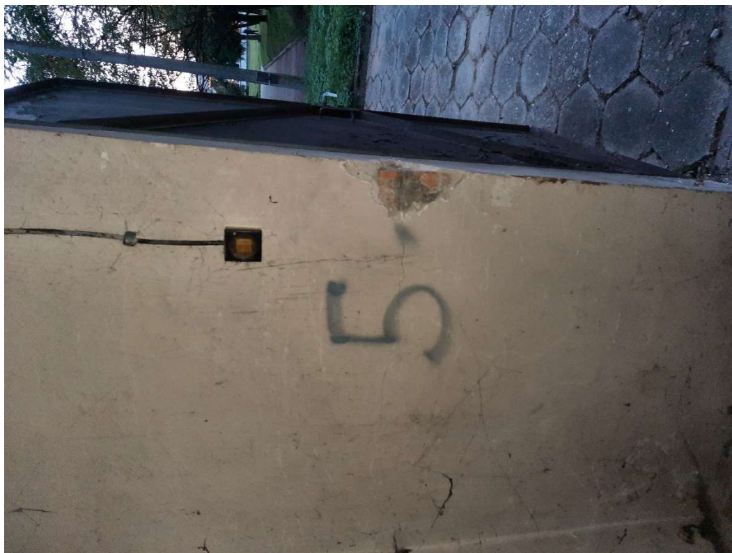
Rysunek 511. Odkrywka 5 - Zarysowania narożnika drzwiowego przy osi 2-A (od wewnątrz).
