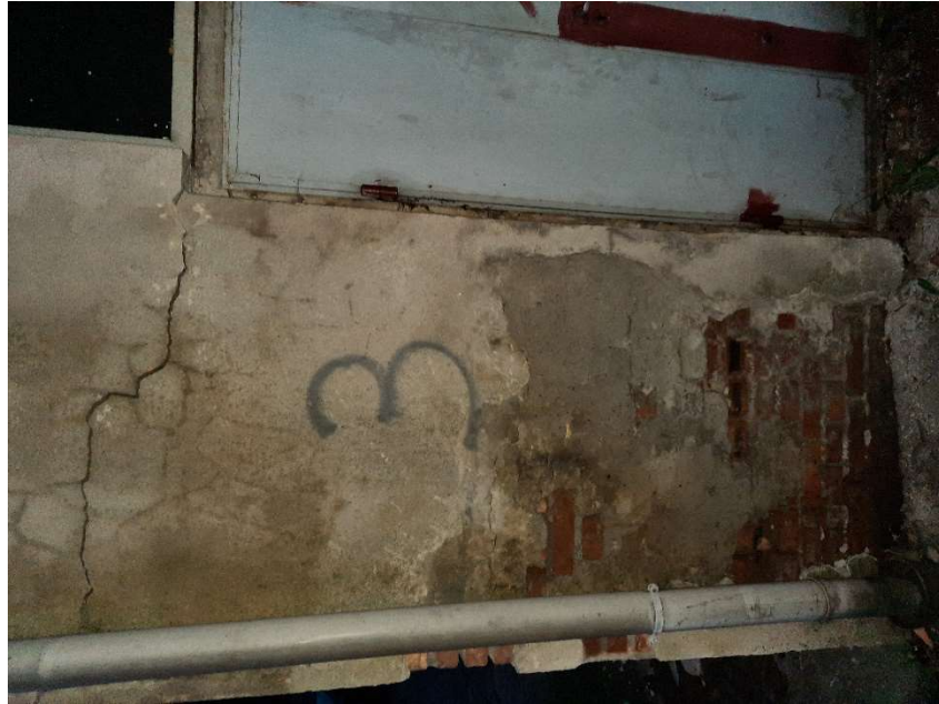
Rysunek 59. Odkrywka 3 - Uszkodzenie narożnika ściany zewnętrznej w osi 1-A (od zewnątrz).
