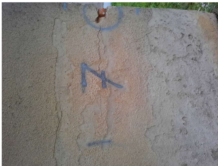
Rysunek 513. Odkrywka 7 - Zarysowania narożnika ściany zewnętrznej w osi 3-B (od zewnątrz).
