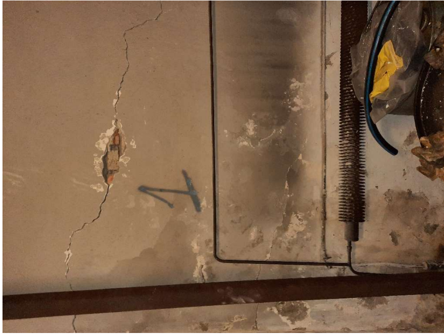
Rysunek 57. Odkrywka 1 - Uszkodzenie narożnika ściany zewnętrznej w osi 1-A (od wewnątrz).
