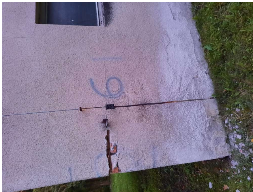
Rysunek 512. Odkrywka 6 - Zarysowania narożnika ściany zewnętrznej w osi 3-B (od zewnątrz).
