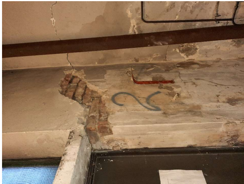
Rysunek 58. Odkrywka 2 - Uszkodzenie narożnika ściany zewnętrznej w osi 1-A (od wewnątrz).
